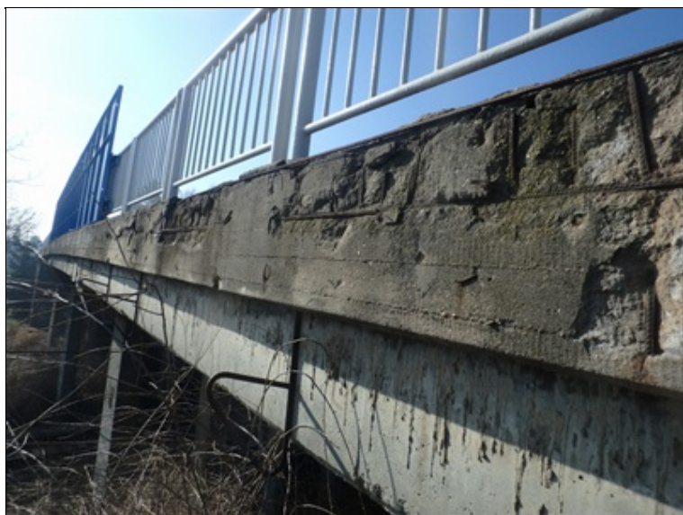
Degradace betonu římsy.
