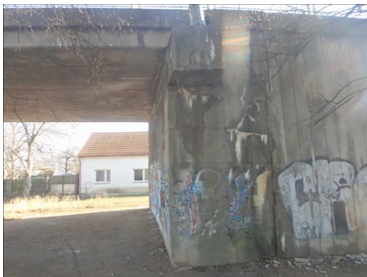
Výluhy pojiva na boku opěry.
