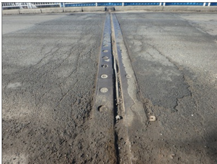
Zanesený mostní závěr nad pilířem 3.
