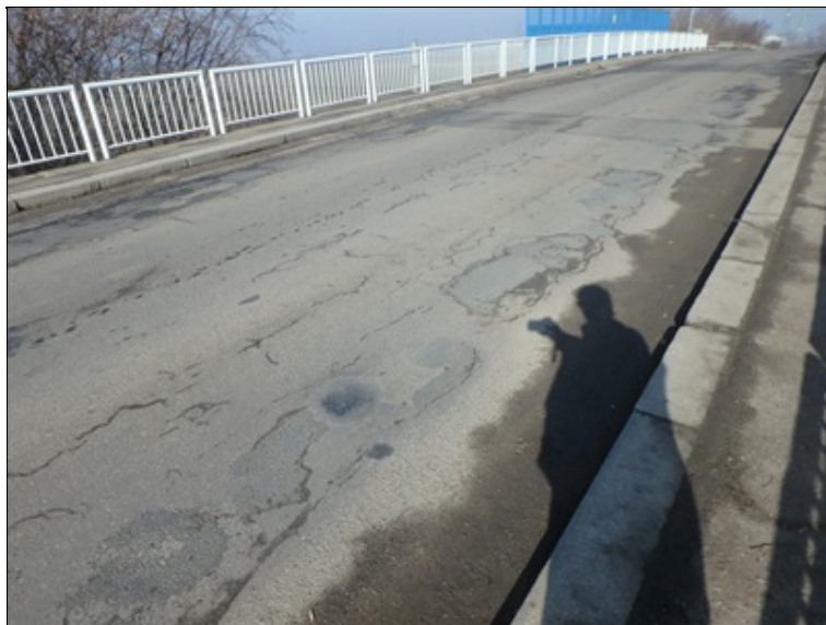
Stav krytu vozovky.
