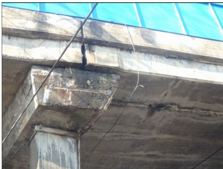
Zatékání n stativo.
