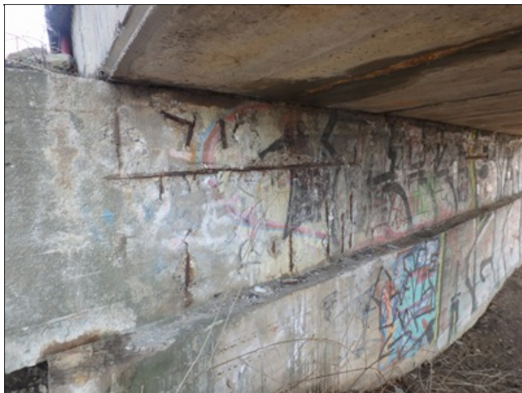
Koroze odhalené výztuže opěry 5.
