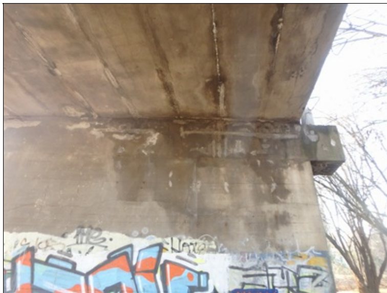
Stopy pozatékání s výluhy pojiva na opěře 1.
