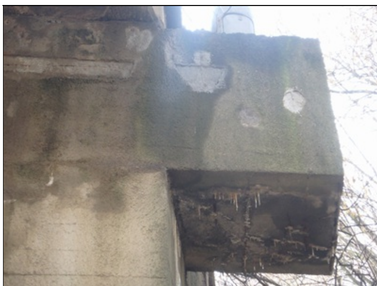
Zatékání s výluhy pojiva konzoly věžného osvětlení.
