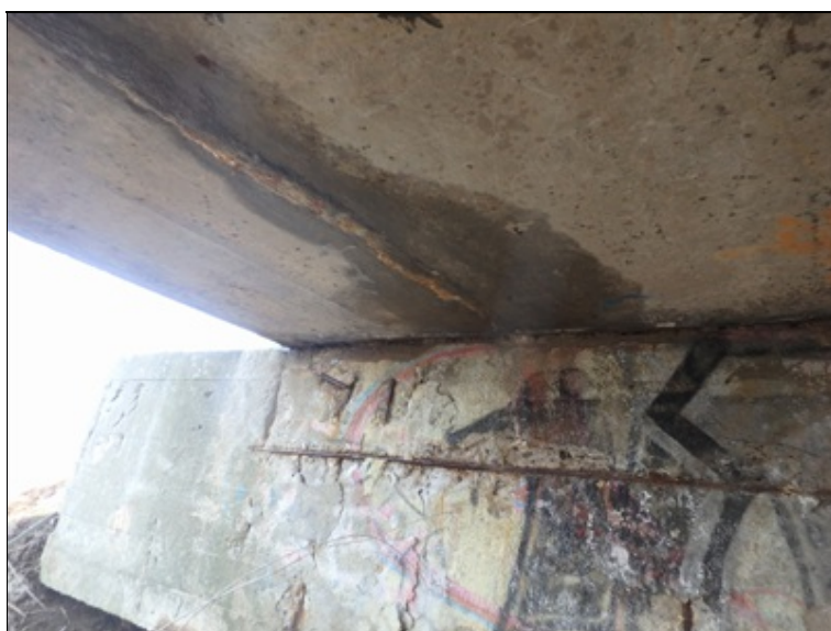
Zatékání sparami mezi nosíky.
