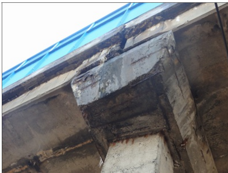
Stopy po zatékání na stativo pilíře 3.
