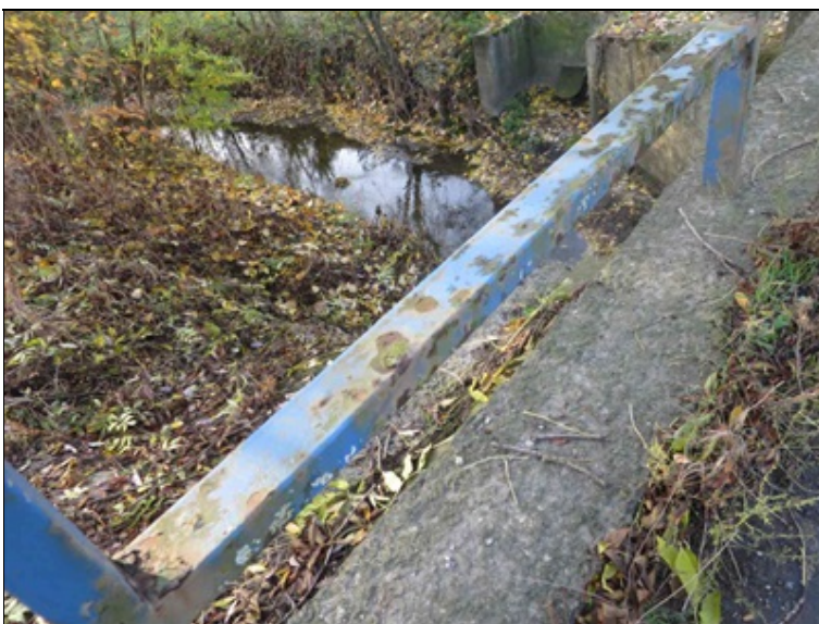
korozí zábradlí, degradace betonu římsy
