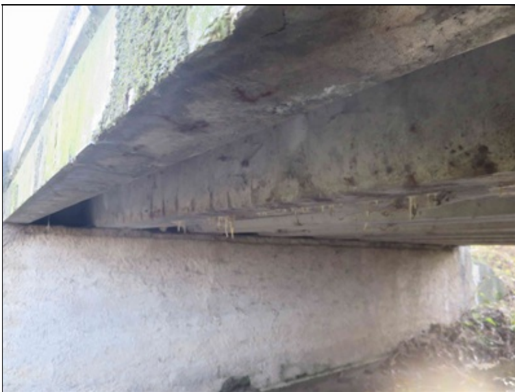
podhled NK, stopy po průsacích s výluhy sparami mezi nosníky, koroze obnažené konstrukční výztuže, podélné trhliny charakteristické pro separaci krycí vrstvy nad korodující nosnou výztuží
