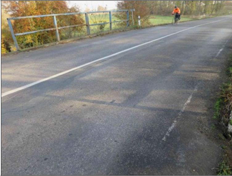
deformace krytu vozovky
