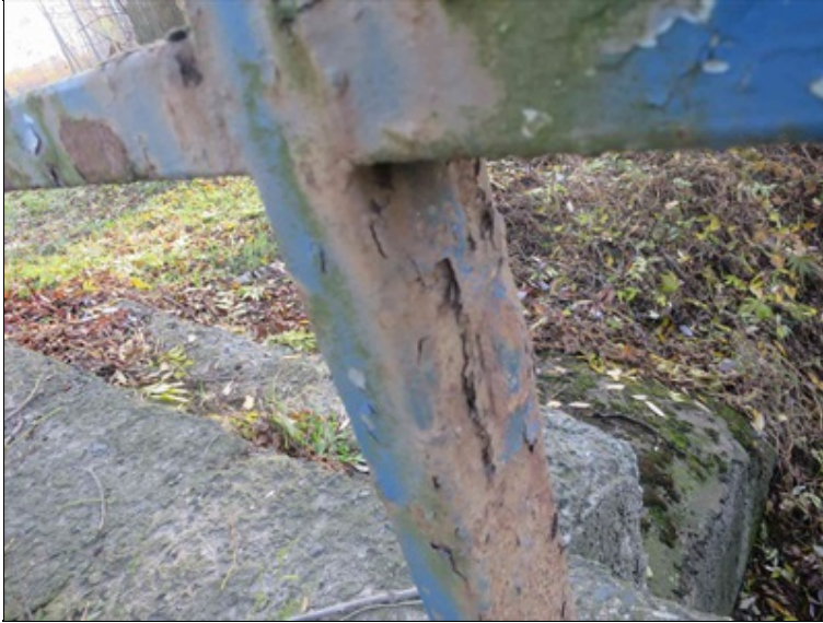
intenzivní koroze zábradlí.
