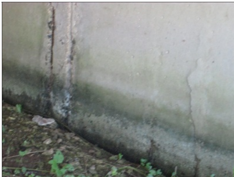
IMG_8709.JPG Degradace betonu spar NK
