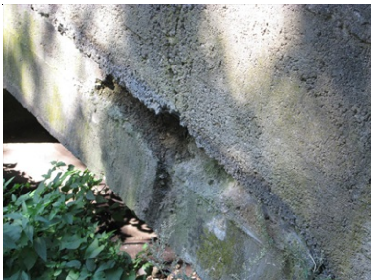
IMG_8695.JPG Degradace betonu spodního okraje římsy
