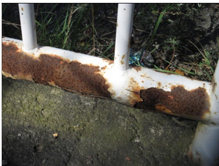
IMG_8696.JPG Koroze zábradlí
