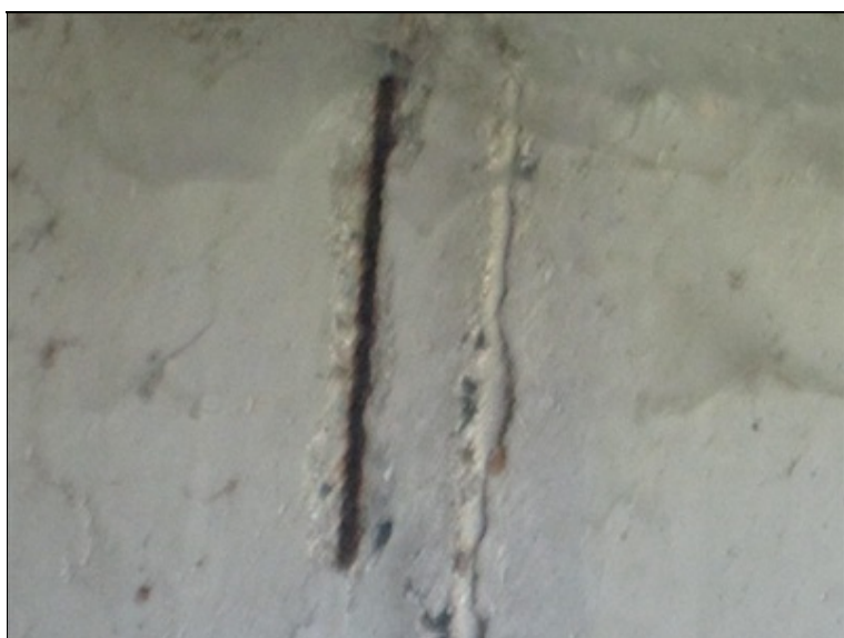
IMG_8707.JPG Odhalená korodující výztuž NK
