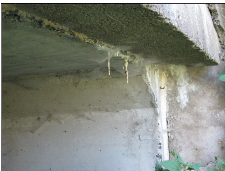
IMG_8703.JPG Výluhy pod římsovou
