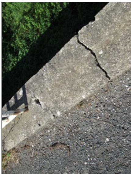
IMG_8698.JPG Trhlina v římse
