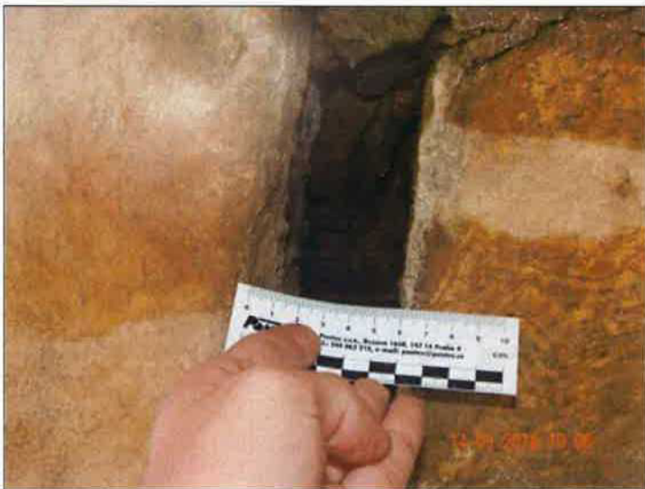
Detail trhliny na pravé straně šířky 50 mm.
