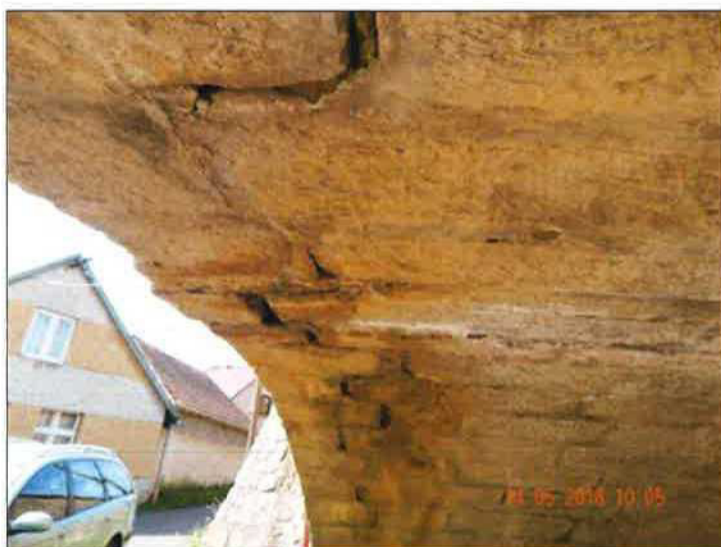
Podélná trhlina pravé straně nosné konstrukce.
