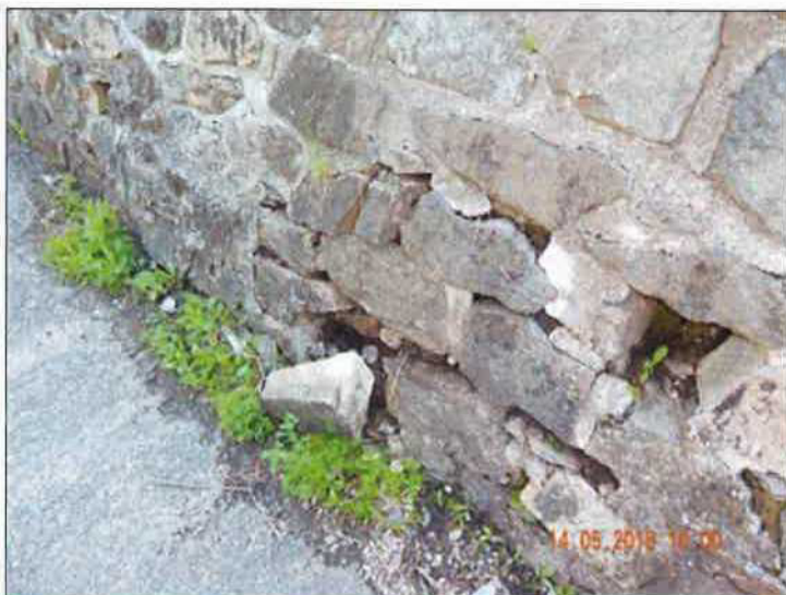
Pata navazující opěrné zdi na levé straně, vypadlý kámen.
