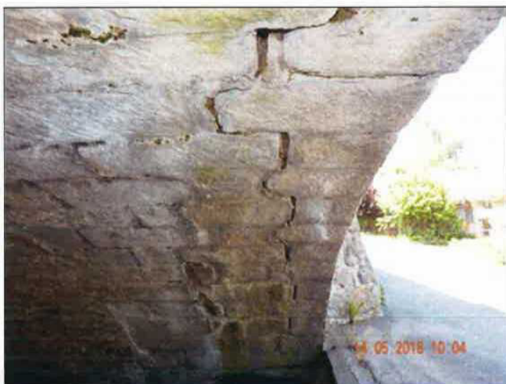
Podélná trhлина na levém kraji nosné konstrukce.
