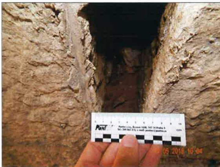
Detail trhliny na levé straně nosné konstrukce v úrovni rubu čelní zdi. Šířka trhliny 70 mm.
