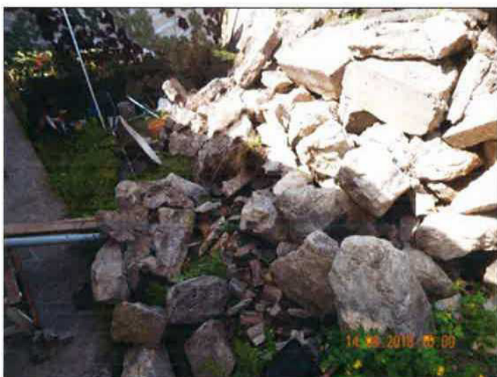
Pohled na navazující opěrnou zeď na pravé straně - část dále od mostu u které došlo k jejímu zřícení.
