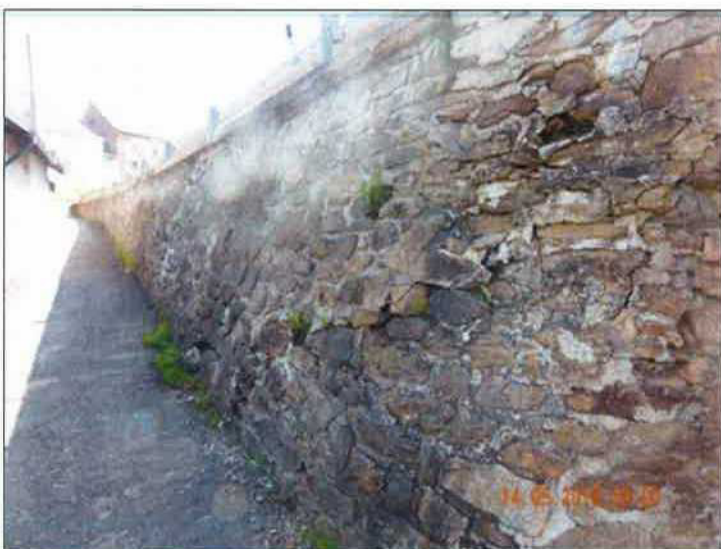
Pohled na navazující čelní zeď na levé straně, plošně vypadlé spárování, místa rozvolněné kameny, uchycená vegetace.
