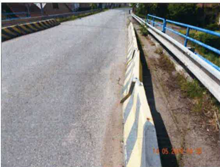
Deformace vozovky, podélné trhliny nad levou částí nosné konstrukce klenby - nutné zajistit aby vozidla nevjížděla na trhlinami porušenou část vozovky.
