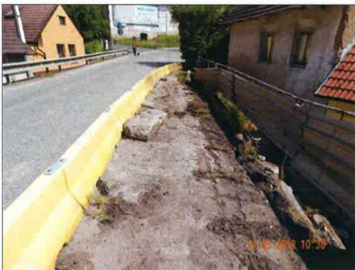
Deformace vozovky a podélné trhliny nad zřícenou částí zdi. Stav celého zemního tělesa je jen omezeně stabilní.
