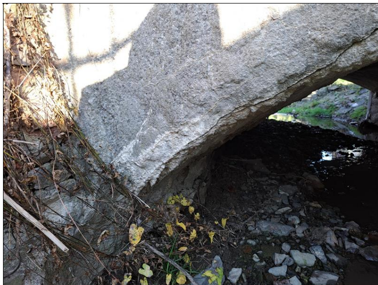
Popraskání torkretu na levé straně OP2
