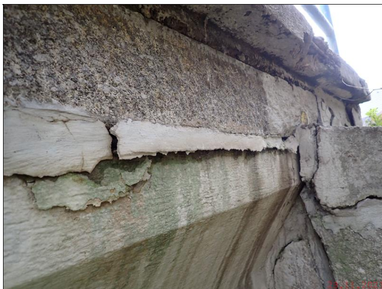
2.1 Nosná konstrukce ve 3. poli vpravo - vypadlá výplň spáry pod římsou.JPG
