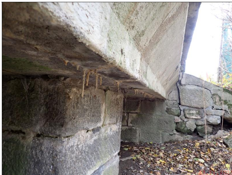
2.1 Nosná konstrukce vpravo - krápníky v krajní spáře.JPG
