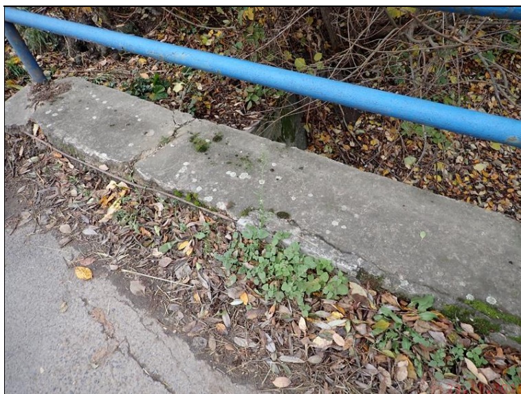
3.3 Římsa vpravo - příčné trhliny a separovaná povrchová vrstva betonu.JPG
