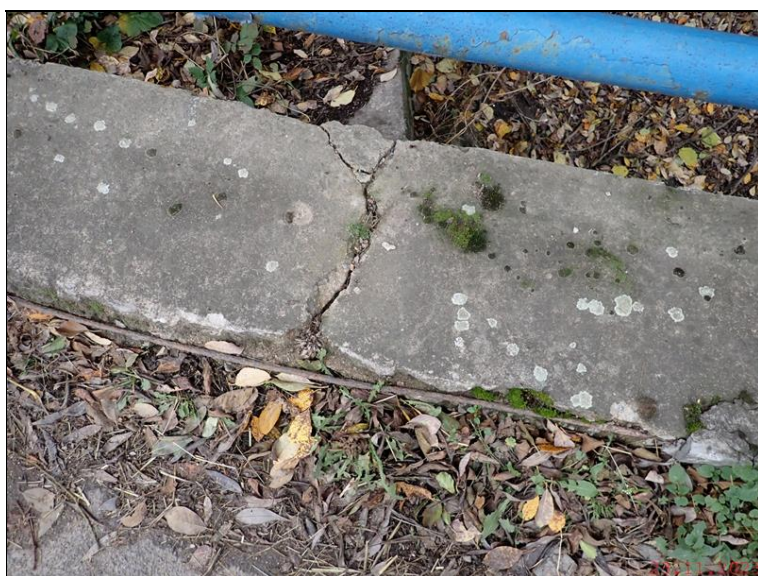
3.3 Římsa vpravo - separovaný beton v trhlině.JPG
