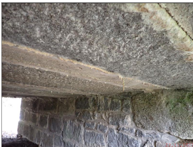
2.1 Nosná konstrukce ve 3. poli - krápníky ve spárách.JPG
