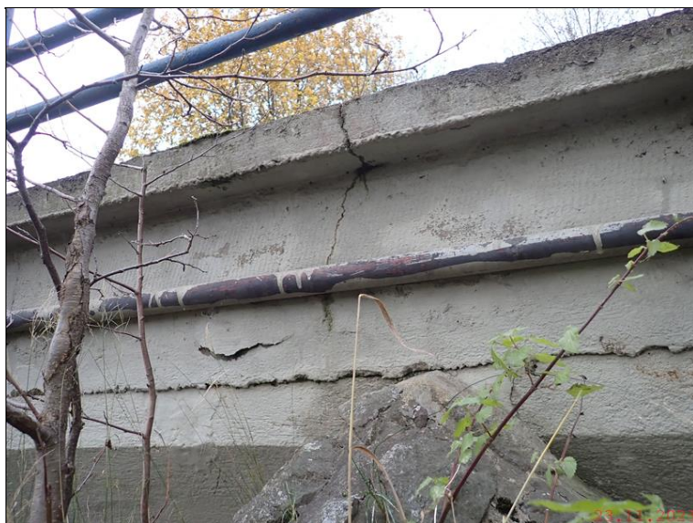
3.3 Římsa vlevo nad P2 - separovaná omítka svislá trhlina.JPG
