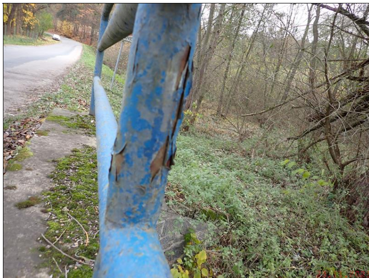
4.2 Zábradlí vlevo - oloupaný nátěr.JPG
