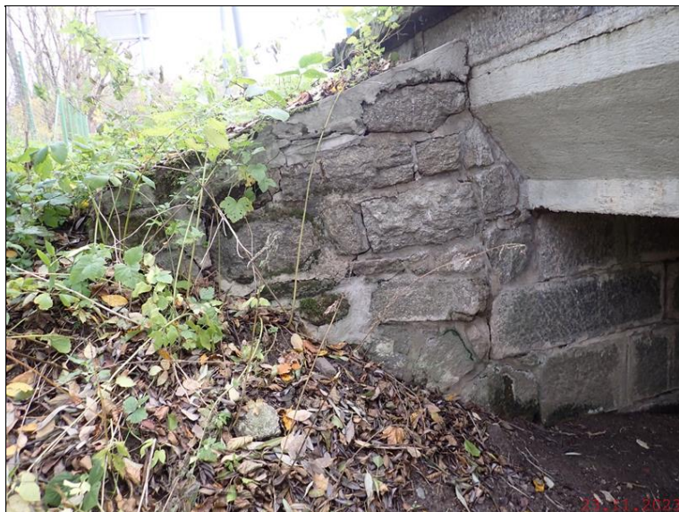
1.2 Opěra O1 vpravo - trhliny v křídle.JPG
