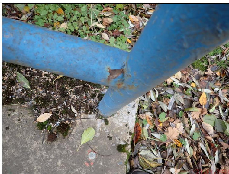
4.2 Zábradlí - lokálně oloupaný nátěr a povrchová koruze.JPG
