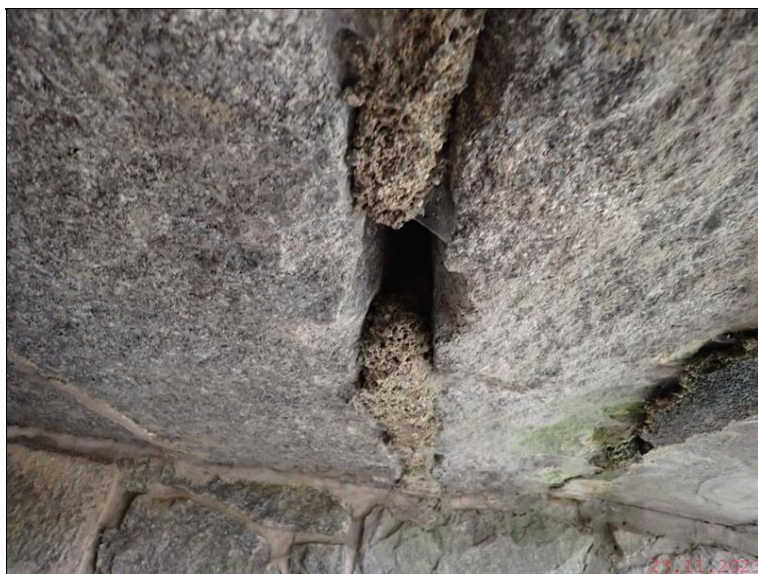
2.1 Nosná konstrukce v 1. poli - lokálně vypadlé spárování.JPG
