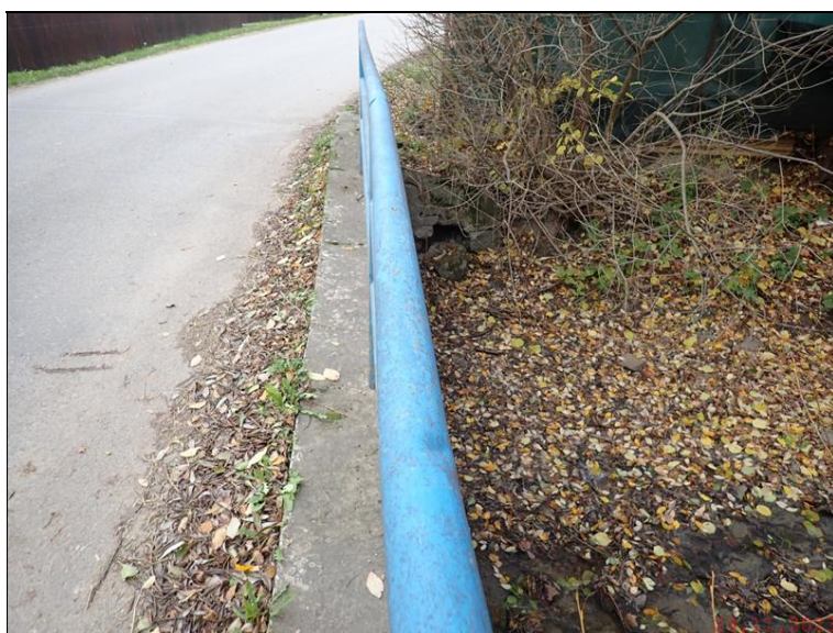
4.2 Zábradlí vpravo lokálně deformované.JPG
