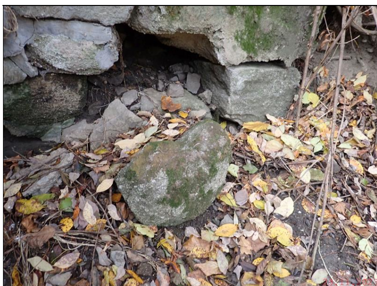
1.2 Opěra O4 - vypadlý kámen zdiva dole.JPG
