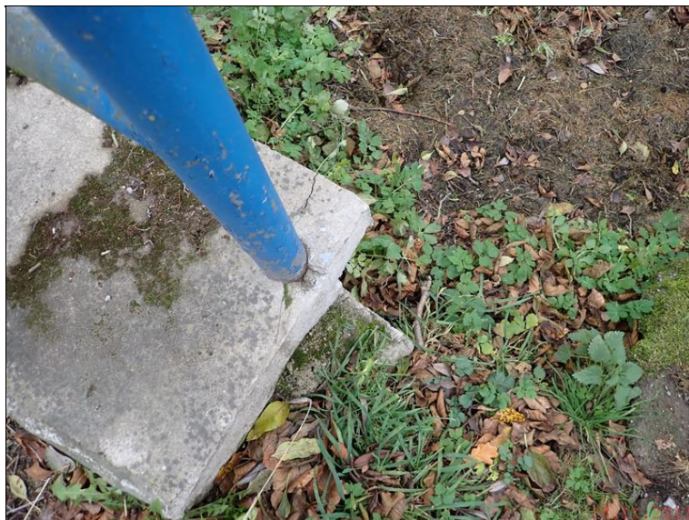
3.3 Římsa vlevo - na konci mostu separovaný beton v místě kotvení sloupku.JPG
