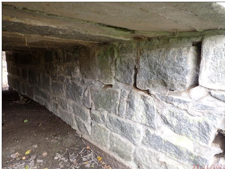
1.2 Pilíř P3 vlevo - vypadlé spárování.JPG
