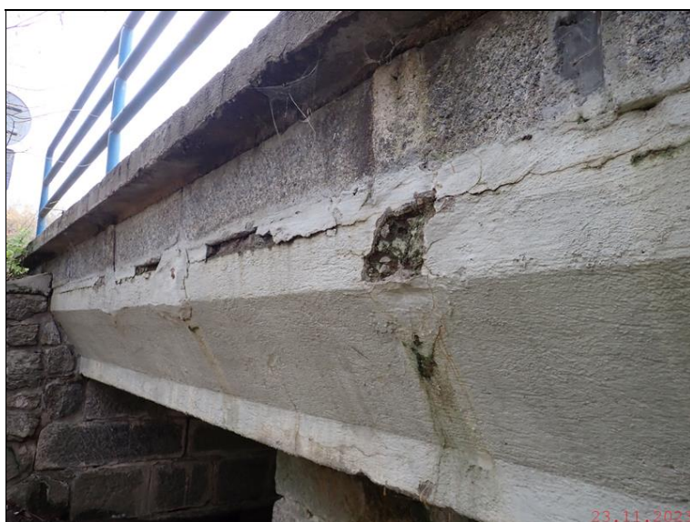
2.1 Nosná konstrukce vpravo - degradace povrchu betonu na boku.JPG
