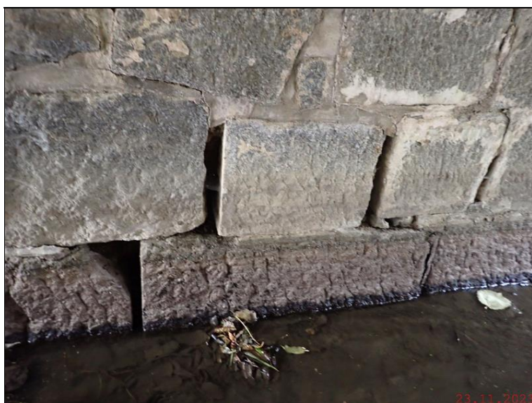
1.2 Pilíř P3 - v úrovni vody vymleté spárování.JPG
