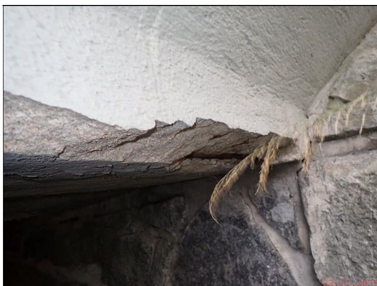
2.1 Nosná konstrukce ve 2. poli - lokálně odpadlý beton koroze obnažené výztuže.JPG
