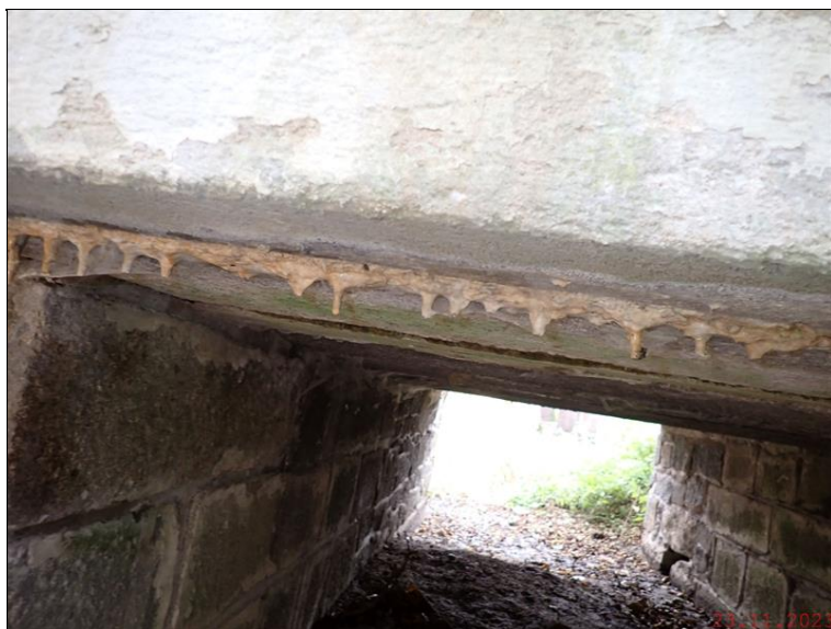
2.1 Nosná konstrukce ve 3. poli vpravo - krápníky v krajní spáře.JPG
