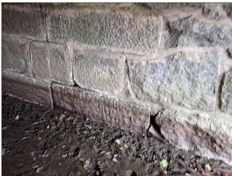
1.2 Opěra O1 - v úrovni vody vymleté spárování.JPG
