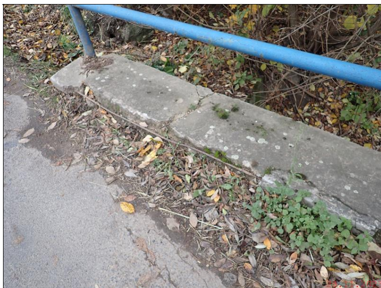
3.3 Římsa vpravo - rozpadlá obrubníková hrana volná výztuž.JPG
