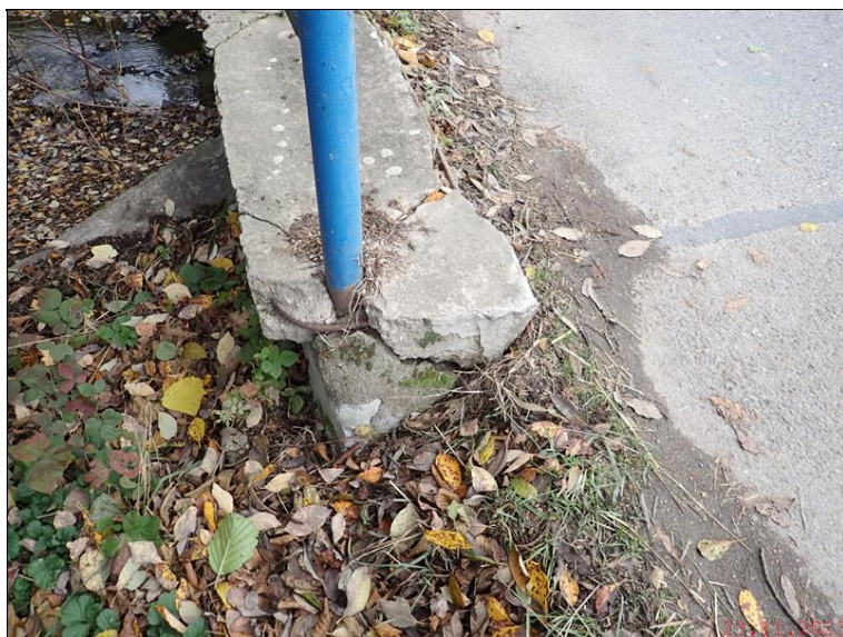
3.3 Římsa vpravo - rozpadlá za mostem volná výztuž.JPG
