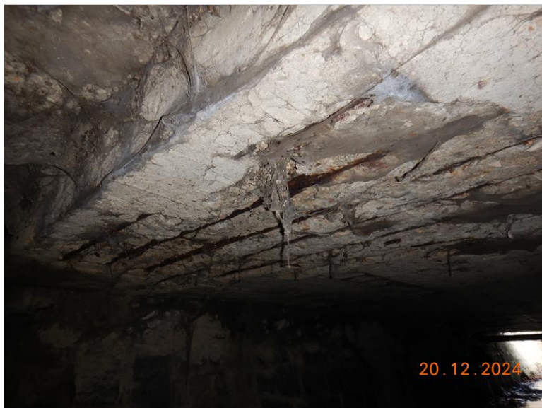
017_NK vlevo. Degradace betonu a koroze výztuže
