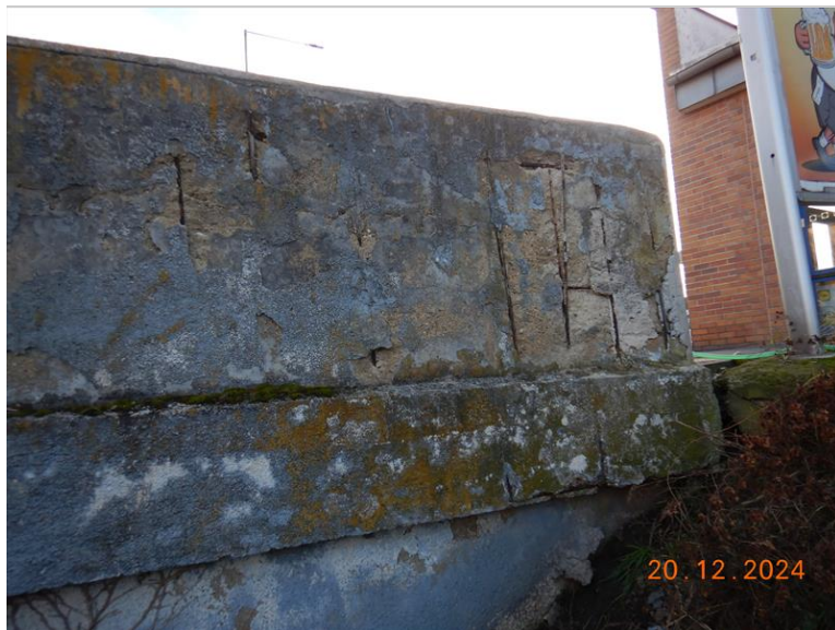
026_Parapetní zeď vpravo. Degradace betonu a koroze výztuže
