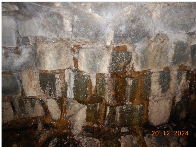
018_OP2 vlevo, detail. Intenzivní průsak
