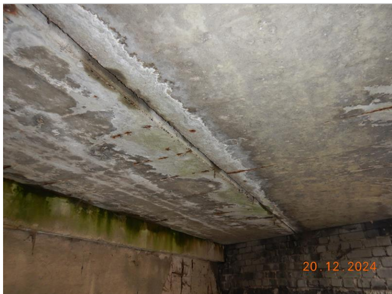
015_Podhled vlevo. Degradace betonu a koroze výztuže. Zatékání spárkou
