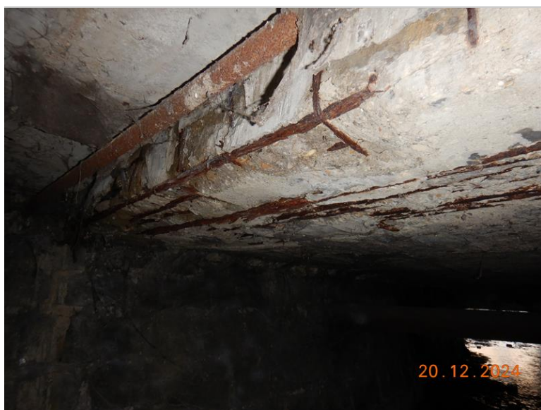
019_NK vlevo. Silná koroze výztuže
