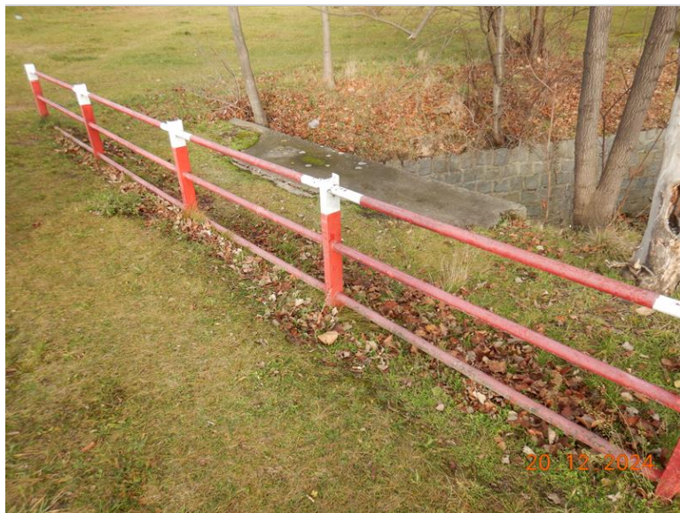
008_Zábradlí vlevo. Degradace nátěru, bionapadení
