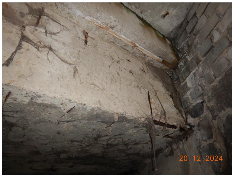
016_Krajní nosník vlevo. Degradace betonu a koroze výztuže. Zatékání
