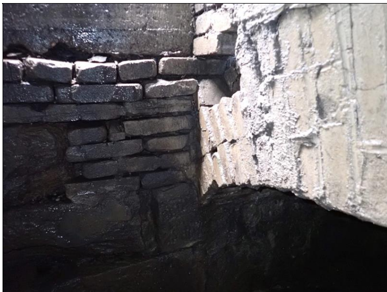
Rozpad zdiva šachty.
