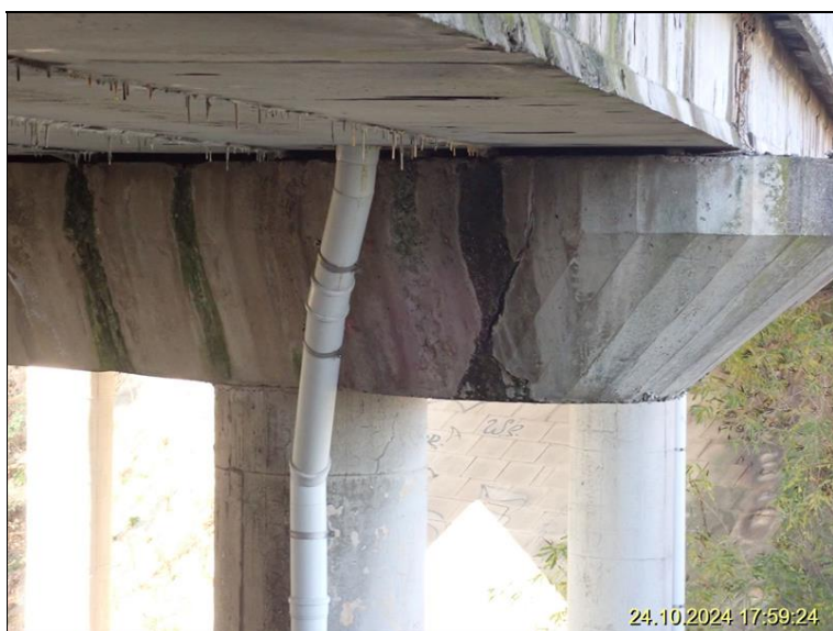
1.2 Pilíř P3 vlevo - zatékání.JPG
