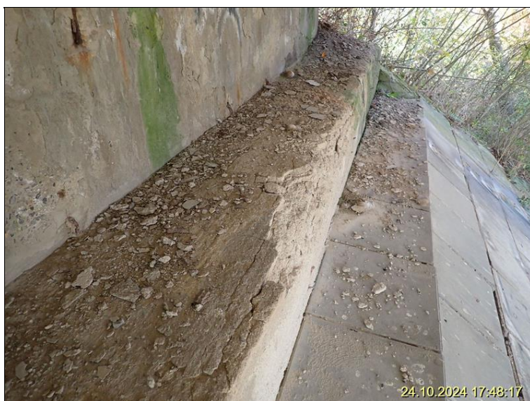
4.6 Zpevnění před O1 - lokální rozpad betonu.JPG
