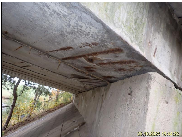
2.1 NK před O4 vpravo - krápníky ve spárách koroze výztuže na pohledu.JPG
