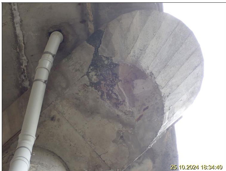
1.2 Pilíř P3 vpravo - lokální koroze výztuže na podhledu stativa separace krycí vrstvy.JPG
