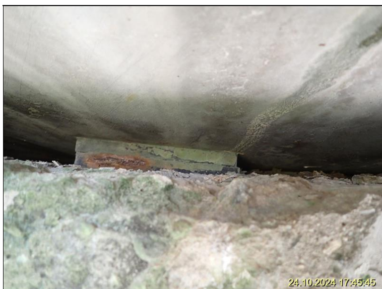
2.2 Ložisko na O1 roztržené s korozí.JPG
