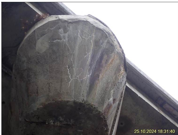
1.2 Pilíř P3 vlevo - všesměrné trhliny na čele stativa výluhy pojava i koroze.JPG
