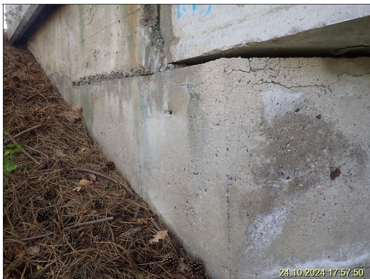
1.2 Opěra O4 vlevo - trhliny v rohu úložného prahu separace betonu.JPG
