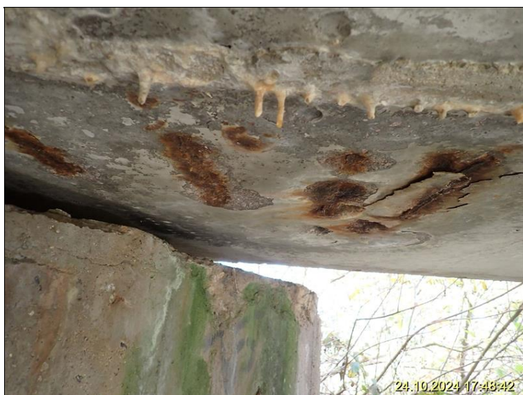
2.1 NK nad O1 vlevo - koroze obnažené výztuže na pohledu nosníku před opěrou.JPG
