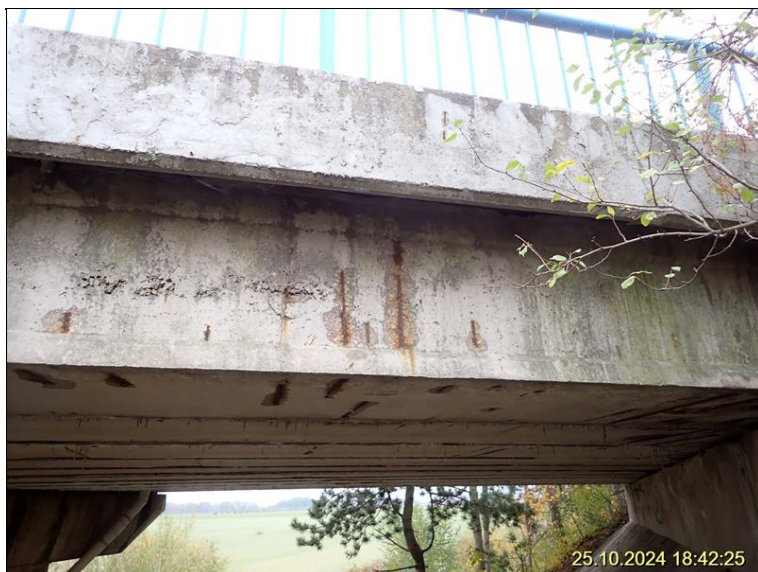
2.1 NK ve 3. poli vpravo - lokální štěrkové hnízdo v krajním nosníku a koroze výztuže.JPG
