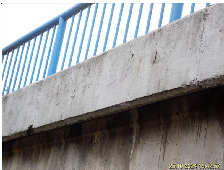
3.3 Římsa vpravo - separace krycí vrstvy betonu.JPG
