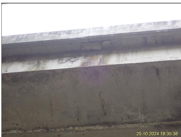
3.3 Římsy - koroze výztuže na pohledu.JPG
