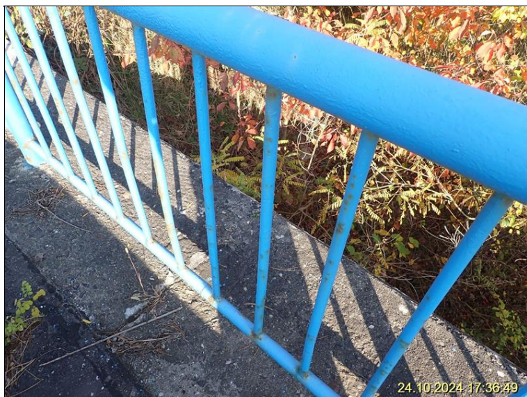
4.2 Lokální koroze zábradlí.JPG
