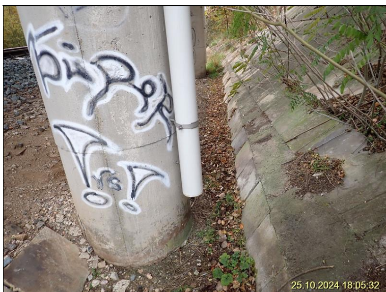
4.6 Zanesený příkop u pilířů P2.JPG
