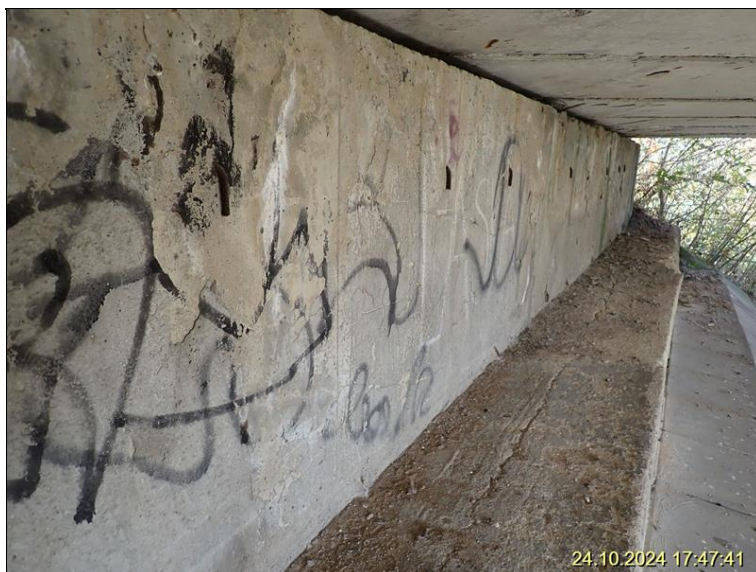
1.2 Opěra O1 - výluhy pojiva ve svislých trhlinách.JPG
