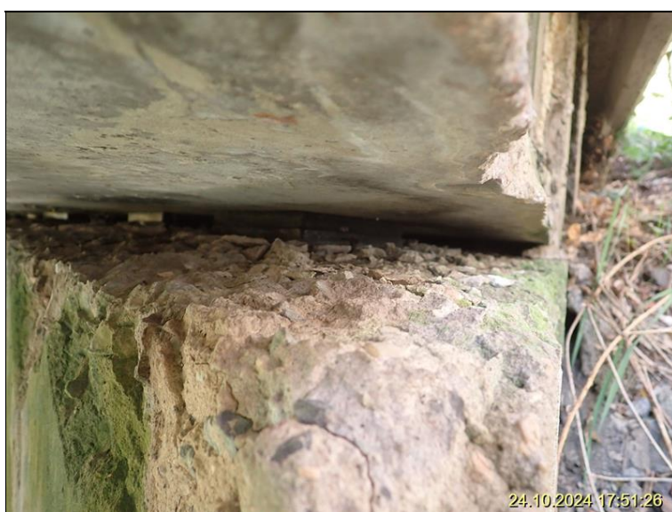
1.2 Opěra O1 vlevo - rozpadlý beton hrany úložného prahu od zatékání.JPG
