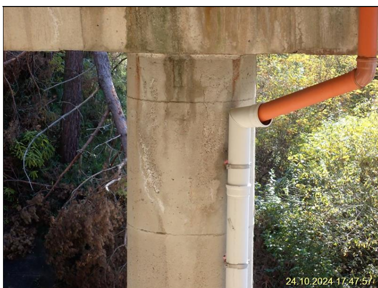
1.2 Pilíř P2 vpravo - zatékání trhliny a separace krycí vrstvy.JPG
