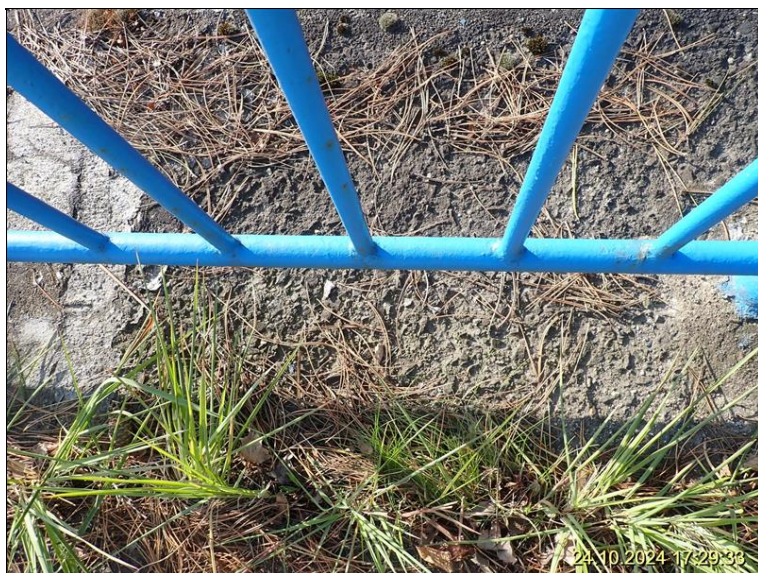
3.3 Degradace povrchu římsy vpravo.JPG
