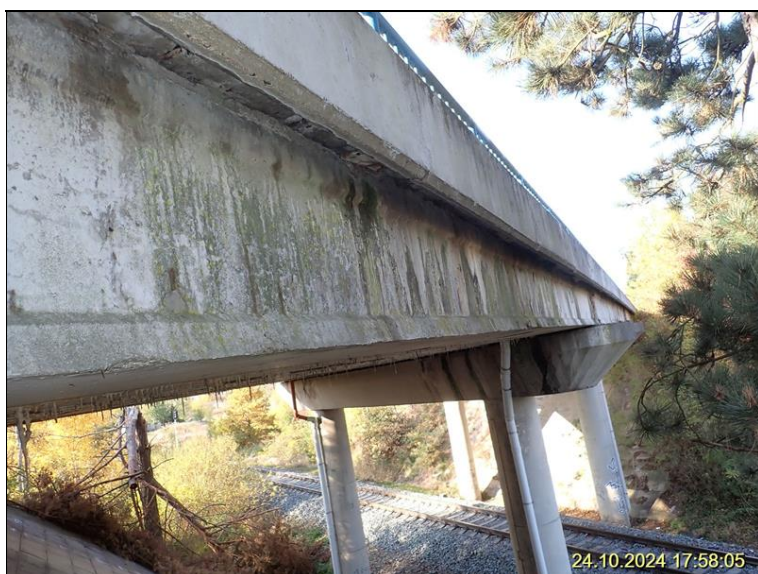
2.1 NK ve 3. poli vlevo - separace krycí vrstvy na boku nosníků koroze výztuže.JPG
