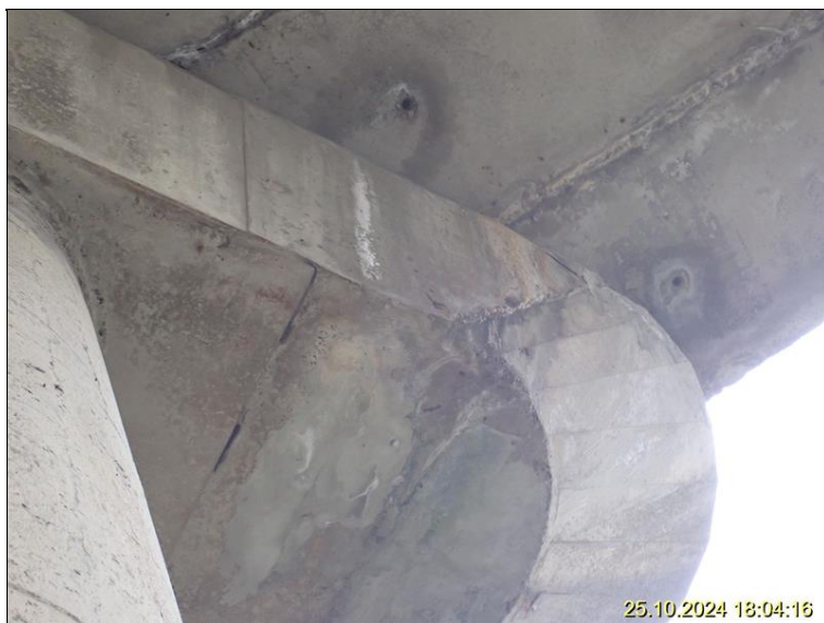
1.2 Pilíř P2 - zatékání na stativo z otvorů v NK.JPG
