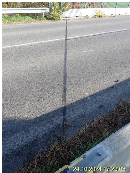
2.3 Dilatační spára nad O1.JPG
