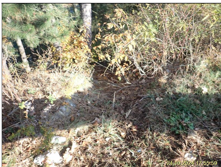
4.8 Zanesené skluzy u opěr.JPG
