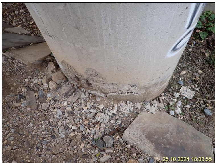
1.2 Pilíř P2 - separovaný beton v patě.JPG
