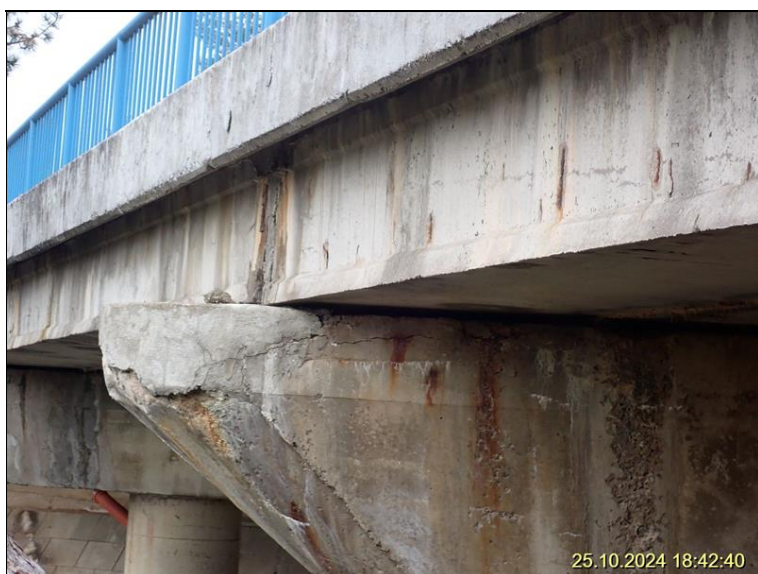
1.2 Pilíř P3 vpravo - trhliny s výluhy pojiva a koroze na konzole stativa separovaný beton.JPG
