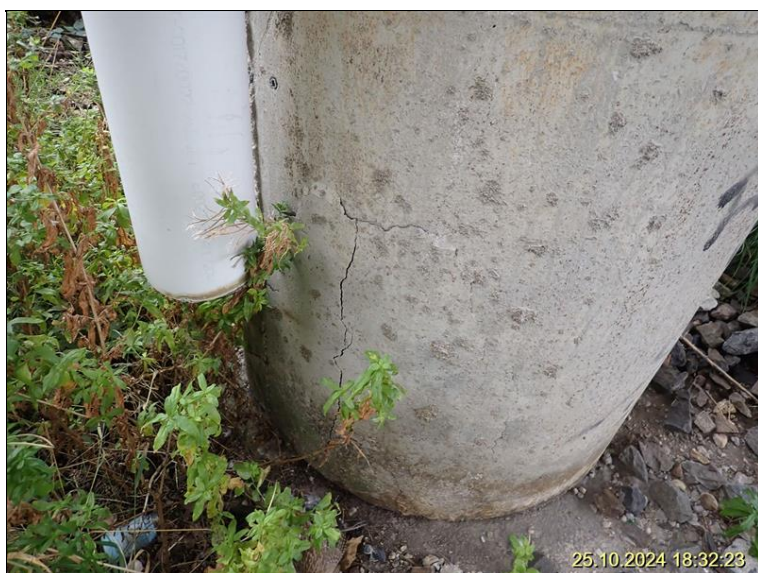
1.2 Pilíř P3 vpravo - separovaná krycí vrstva betonu v patě.JPG
