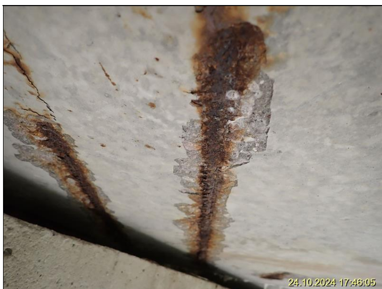
2.1 NK před O1 - koroze příčné výztuže na pohledu nosníků.JPG
