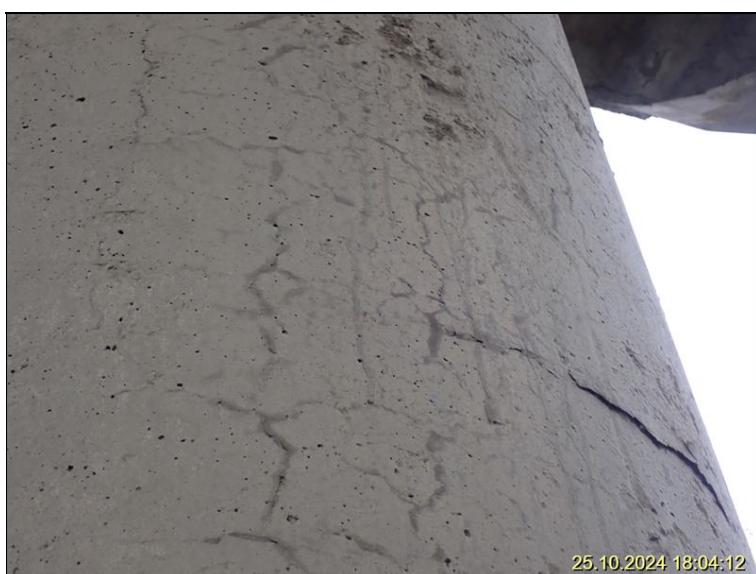
1.2 Pilíř P2 - trhliny a separace povrchové vrstvy betonu.JPG
