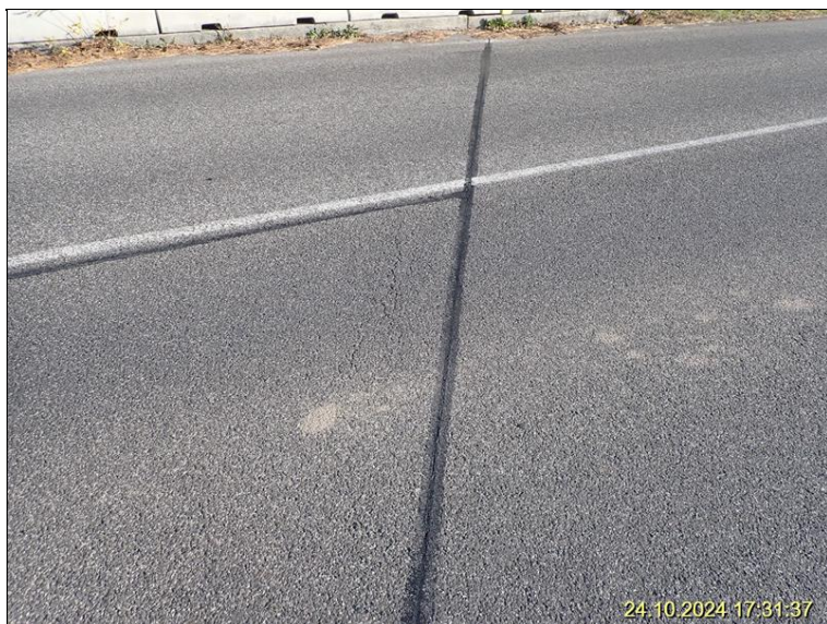
3.1 Souběžná trhlina ve vozovce u dilatační spáry nad O4.JPG
