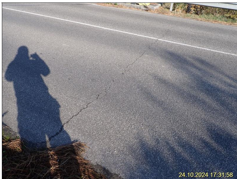
1.3 Příčná trhlina ve vozovce za mostem.JPG
