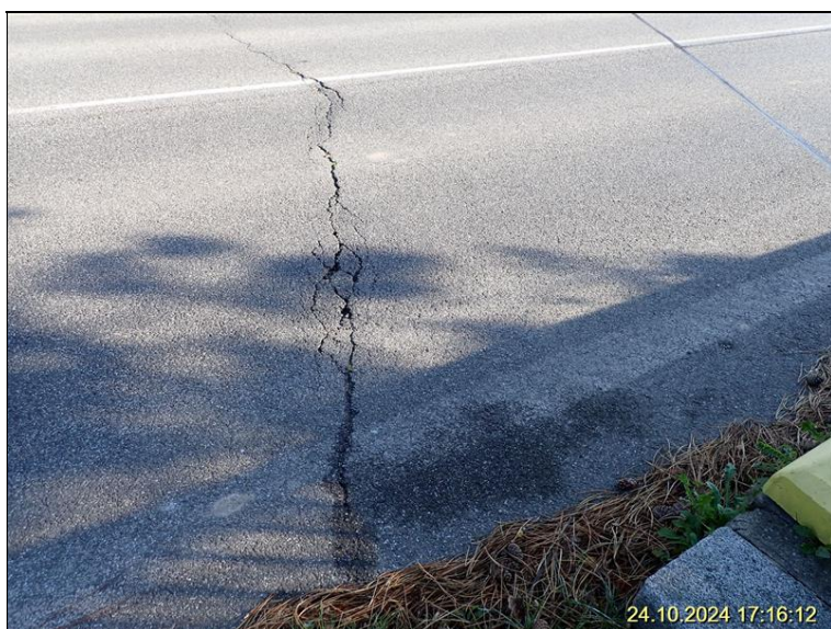
1.3 Příčná trhlina ve vozovce před mostem.JPG
