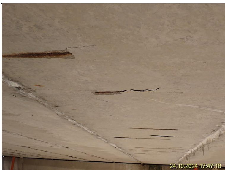
2.1 NK v 1. poli - separovaná krycí vrstva na pohledu koroze obnažené výztuže.JPG
