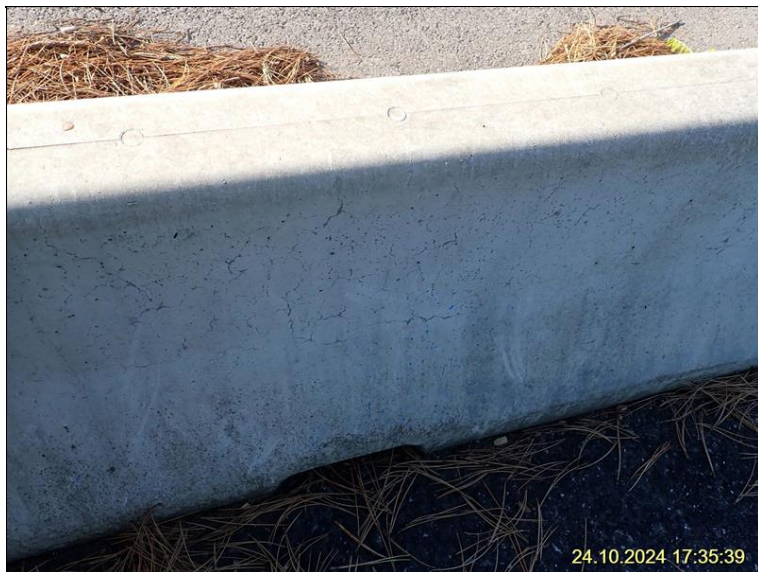
4.1 Povrchové trhliny na betonových svodidlech.JPG
