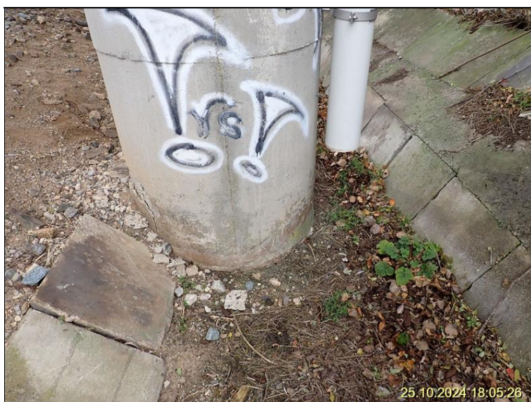
1.2 Pilíř P2 - separace krycí vrstvy betonu v patě.JPG
