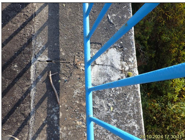
3.3 Příčné trhliny v římsce vpravo.JPG
