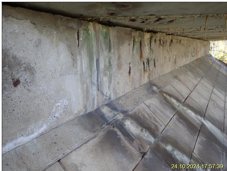
1.2 Opěra O4 - zatékání výluhy pojiva koroze výztuže.JPG
