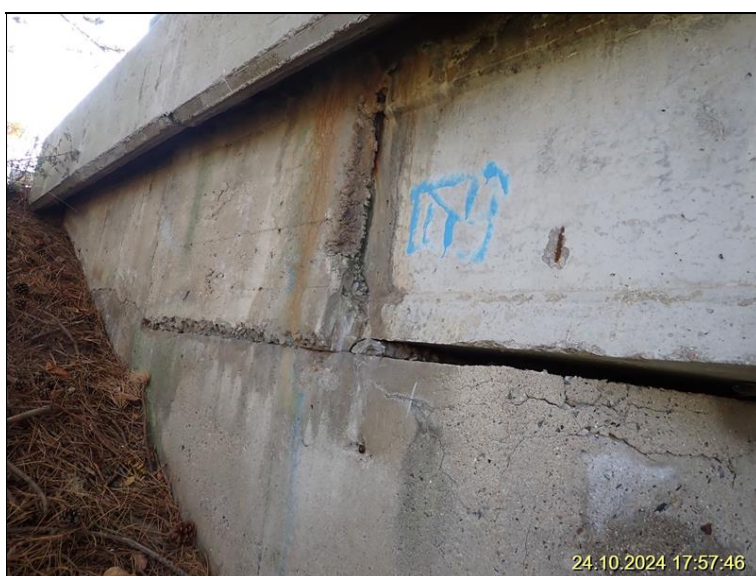
2.1 NK nad O4 vlevo - zatékání pod římsou.JPG
