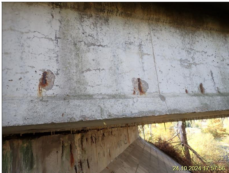
2.1 NK ve 3. poli vlevo - koroze výztuže na boku.JPG
