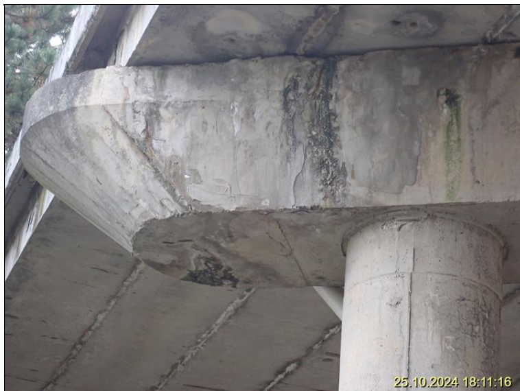
1.2 Pilíř P3 vpravo - zatékání separace krycí vrstvy.JPG
