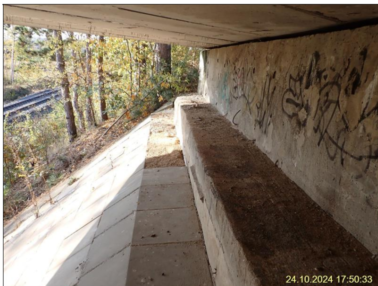
4.6 Zpevnění před O1 - lokálně chybí dlaždice.JPG
