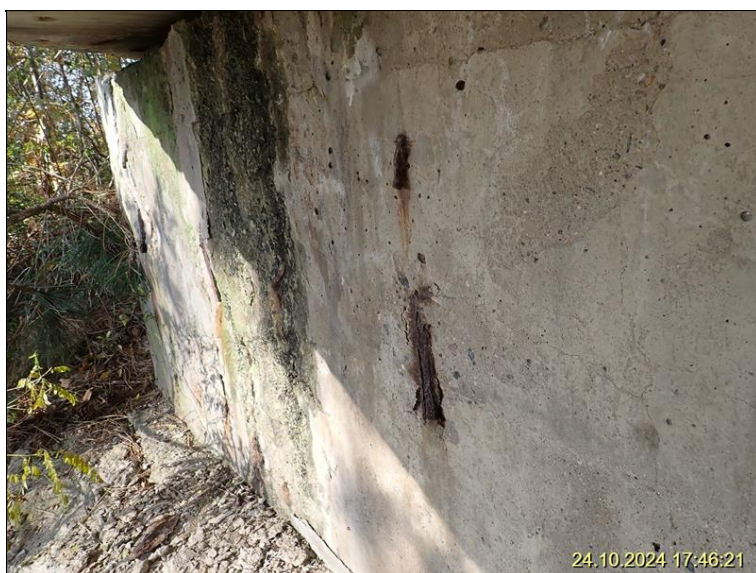
1.2 Opěra O1 - zatékání z úložného prahu koroze obnažené výztuže.JPG
