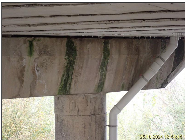
1.2 Pilíř P3 - zatékání na stativo výluhy pojava v trhlinách.JPG
