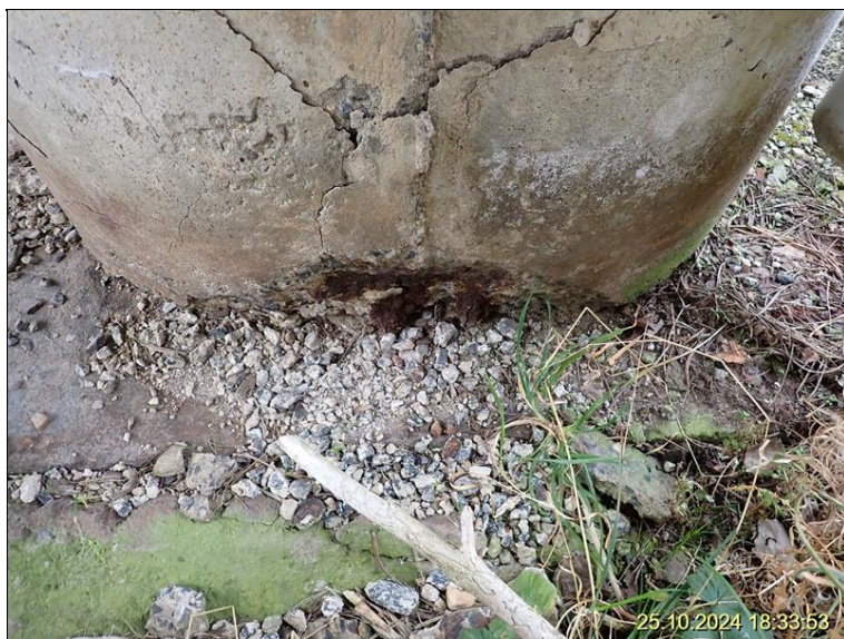
1.2 Pilíř P3 vlevo - separovaná krycí vrstva betonu v patě.JPG
