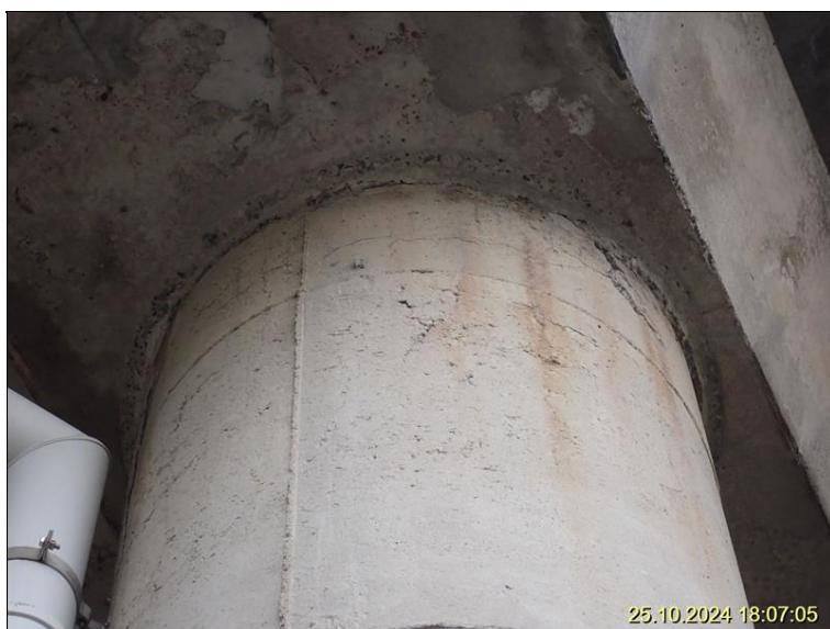
1.2 Pilíř P2 - trhliny a separace krycí vrstvy v hlavě.JPG
