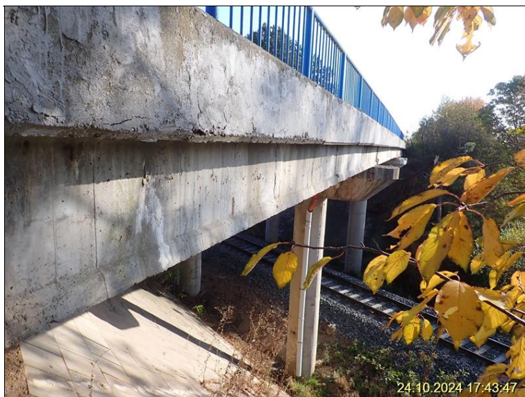
2.1 NK nad O1 vpravo - zatékání pod římsou.JPG
