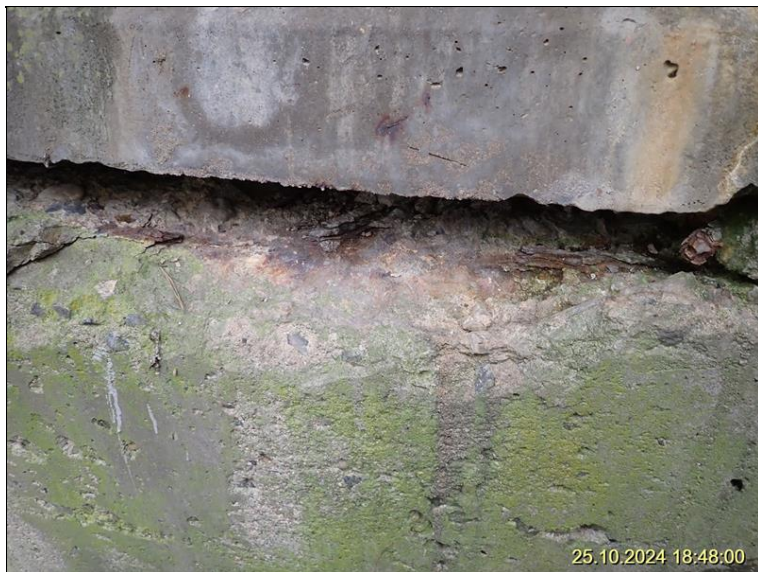
1.2 Opěra O4 - koroze obnažené výztuže na horní ploše úložného prahu.JPG
