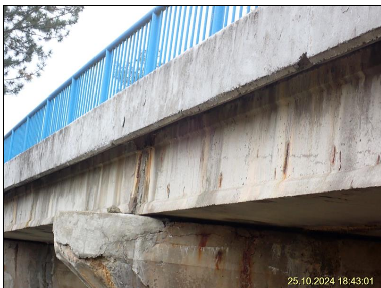
2.1 NK nad P3 vpravo - zatékání na boku nosníku výluhy koroze a koroze obnažené výztuže.JPG
