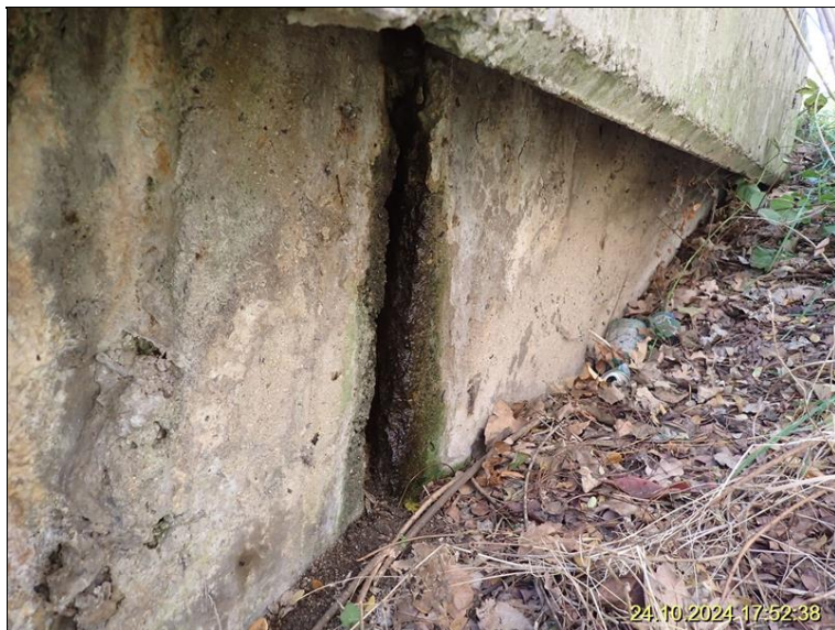
1.2 Opěra O1 vlevo - zatékání dilatační spárou.JPG
