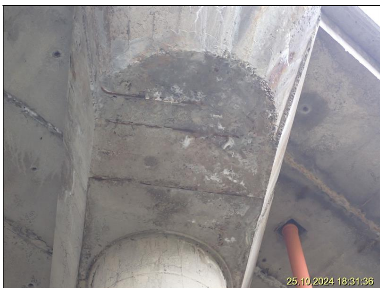
1.2 Pilíř P3 vlevo - krápníky a výluhy pojava na pohledu stativa koroze výztuže.JPG
