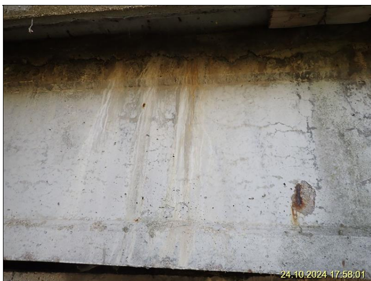
2.1 NK nad O4 vlevo - zatékání pod římsou 2.JPG
