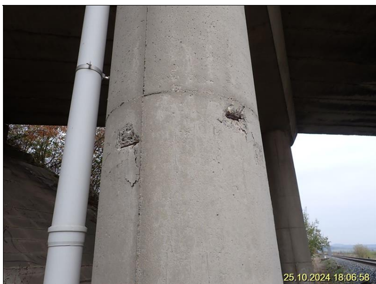
1.2 Pilíř P2 - lokálně odpadá krycí vrstva betonu.JPG
