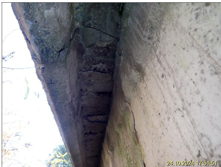
3.3 Římsy před opěrami - separace krycí vrstvy na pohledu.JPG
