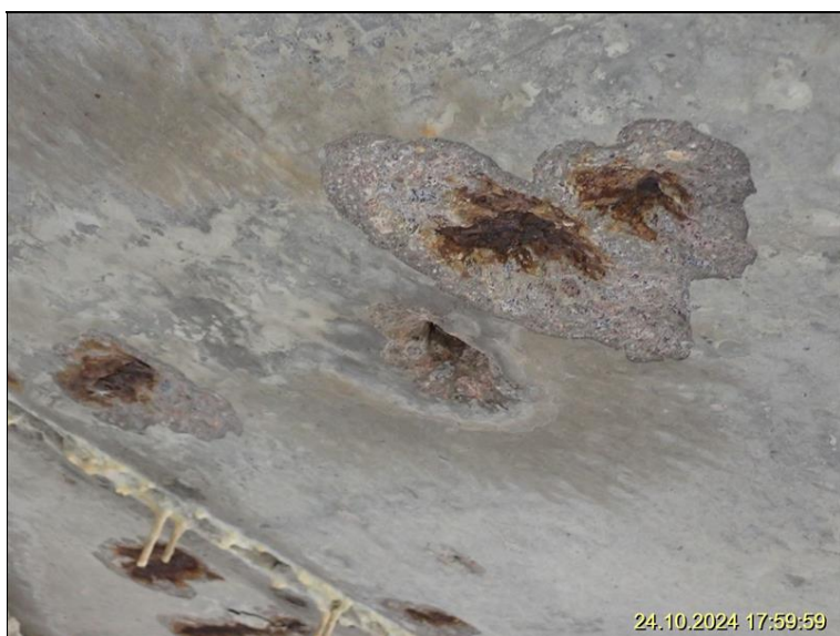
2.1 NK ve 3. poli u P3 - odpadlá krycí vrstva betonu koroze výztuže na podhledu.JPG
