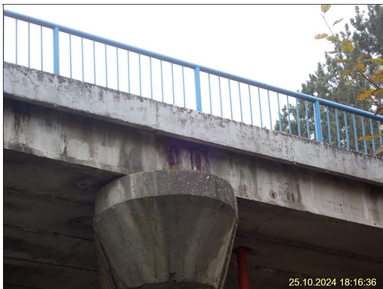
2.1 NK nad P3 vpravo - koroze výztuže na boku nosníku.JPG
