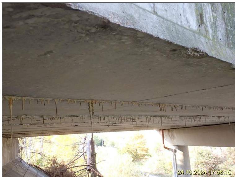
2.1 NK ve 3. poli vlevo - krápníky ve spárách mezi 1. až 4. nosníkem.JPG
