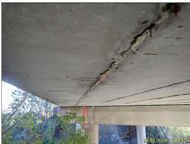
2.1 NK v 1. poli mezi 1. až 3. nosníkem vlevo - krápníky ve spárách mezi nosníky.JPG
