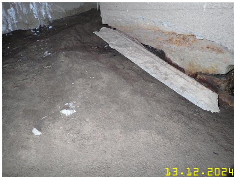
085 STOJKA ODPADÁVAJÍCÍ KRYCÍ VRSTVA.JPG
