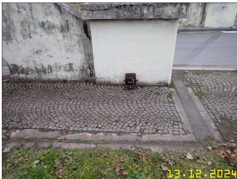
022 DILATACE NA PRAVÉ STRANĚ U OPĚRY O2.JPG
