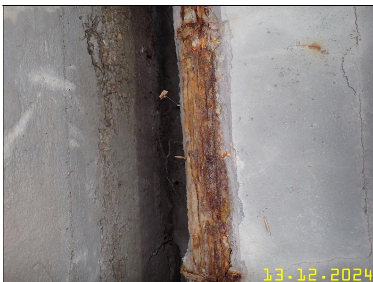
090 KOROZE NA O1 PŘÍČNÍKU.JPG
