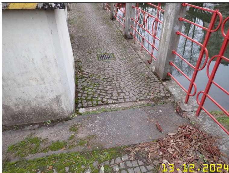
004 CHODNÍK NA PRAVÉ STRANĚ MOSTU DILATACE.JPG
