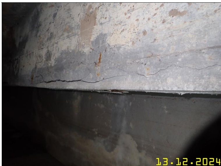
086 TRHLINY NA PŘÍČNÍKU.JPG
