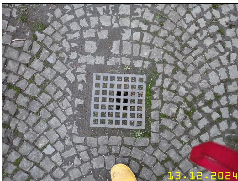
018 VPUŠŤ V CHODNÍKU NA PRAVÉ STRANĚ U OPĚRY O2.JPG
