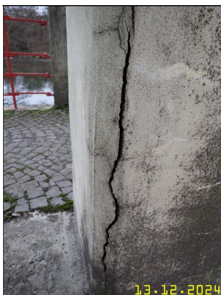
033 TRHLINY V ZÁVĚSECH.JPG
