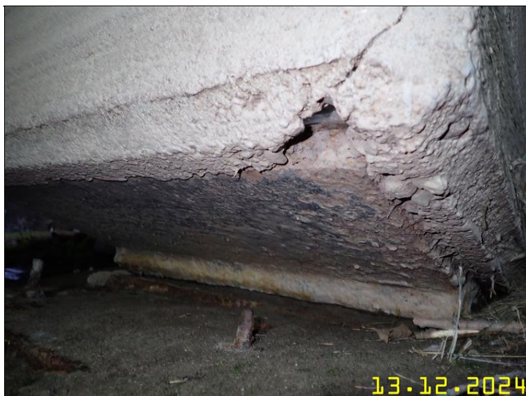
083 KOROZE KLOUBŮ NA O1.JPG
