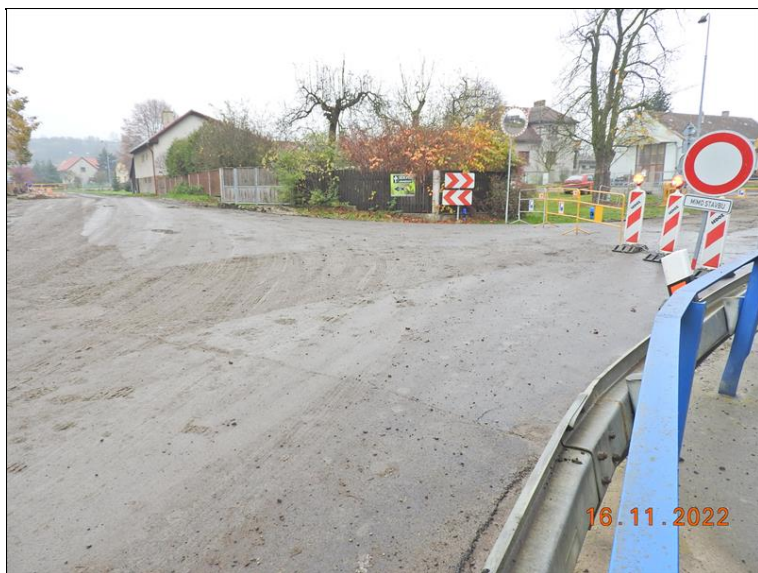
Vozovka - před opravou.
