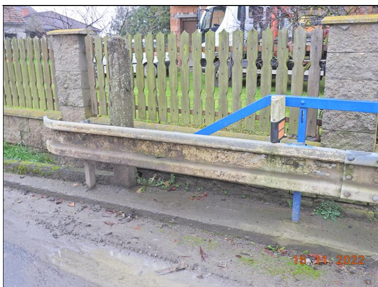
Levé svodidlo - deformace.
