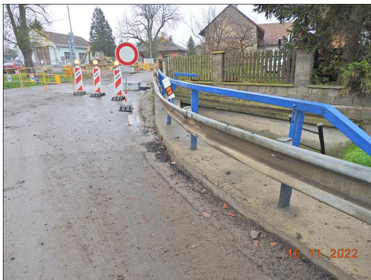
Levé svodidlo - deformace.
