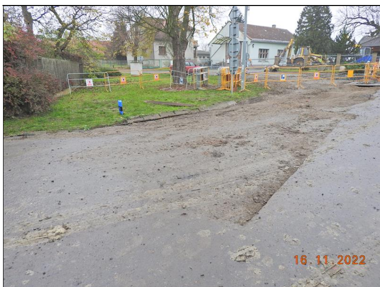
Vozovka - před opravou.
