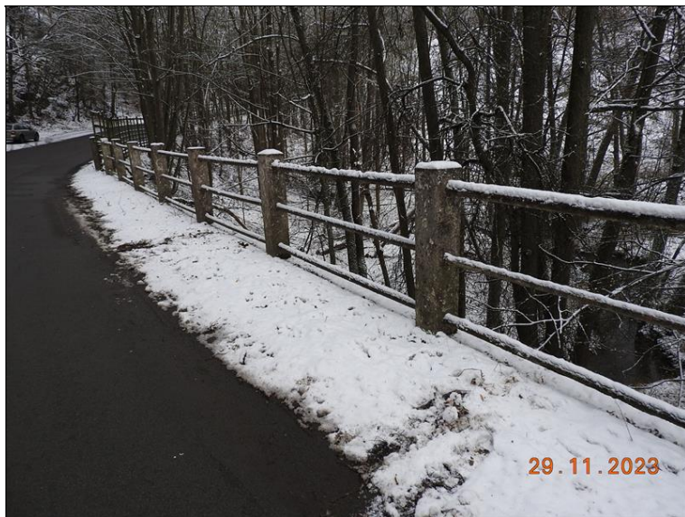
015_Zábradlí vpravo. Degradace betonu a madell.jpg
