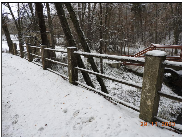
014_Zábradlí vlevo. Degradace betonu a madel.jpg
