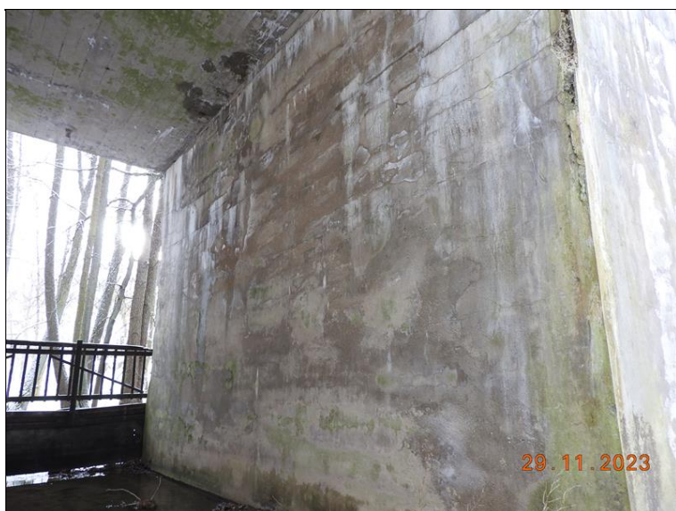
004_OP1. Degradace betonu, separace omítkové vrstvy v horní části, bionapadení.jpg
