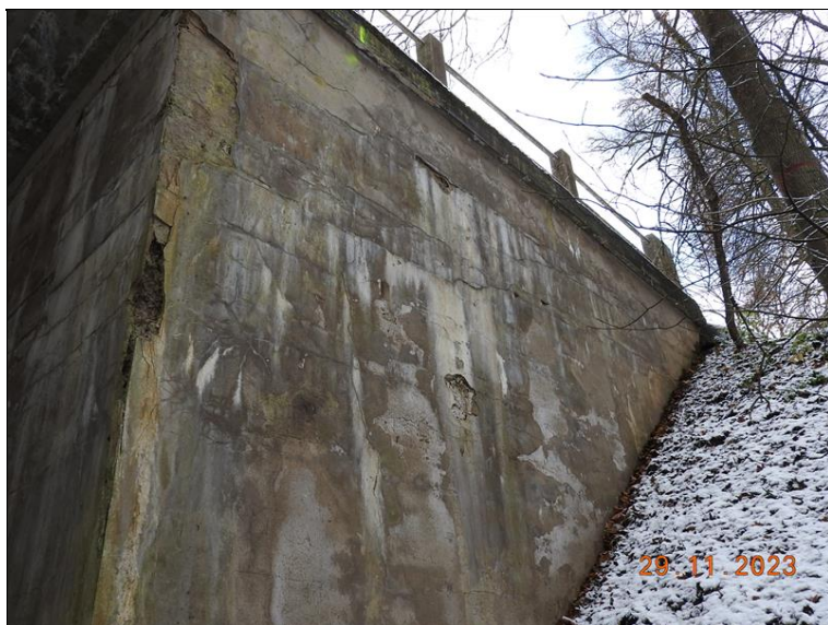
006_Levé křídlo OP1. Degradace betonu, separace omítkové vrstvy v horní části, bionapadení.jpg
