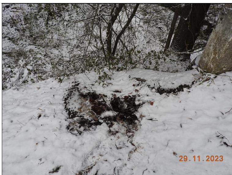
020_Odvodnění vlevo. Zanesený vegetací.jpg
