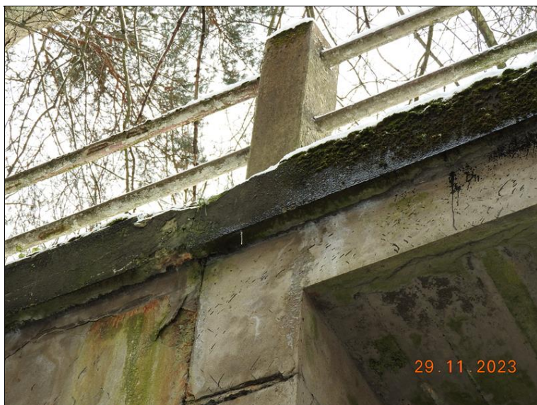
012_Levá římsa. Degradace betonu, separace krycí vrstvy, bionapadení.jpg
