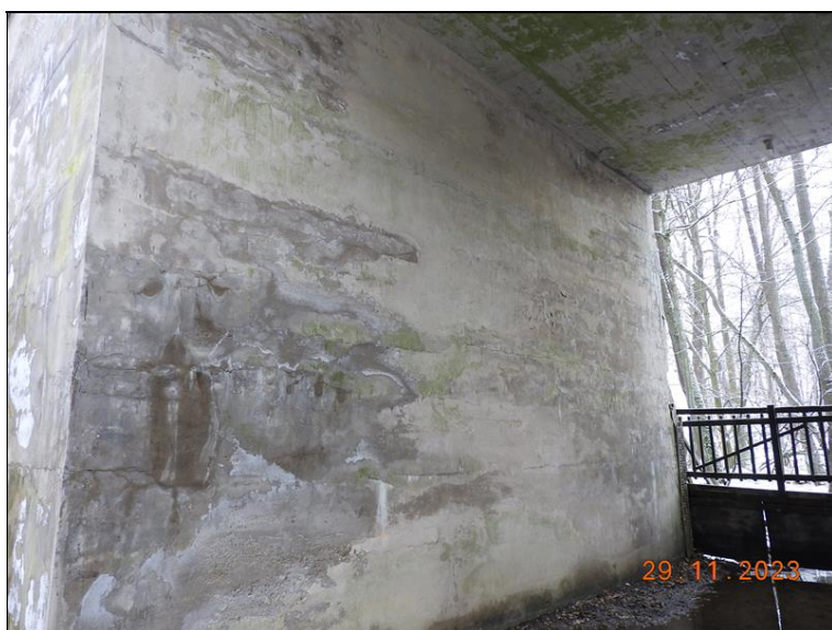
005_OP2. Degradace betonu, separace omítkové vrstvy v horní části, bionapadení.jpg
