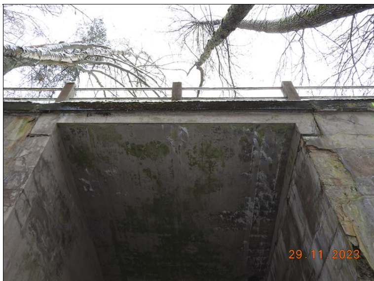
013_Levý bok NK. Degradace betonu.jpg
