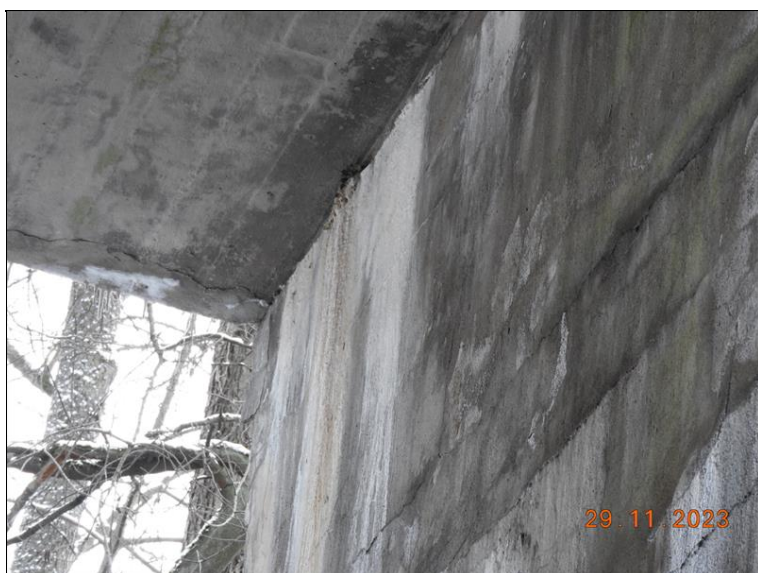
022_OP1 detail vpravo. Stopy po zatékání, výluhy.jpg
