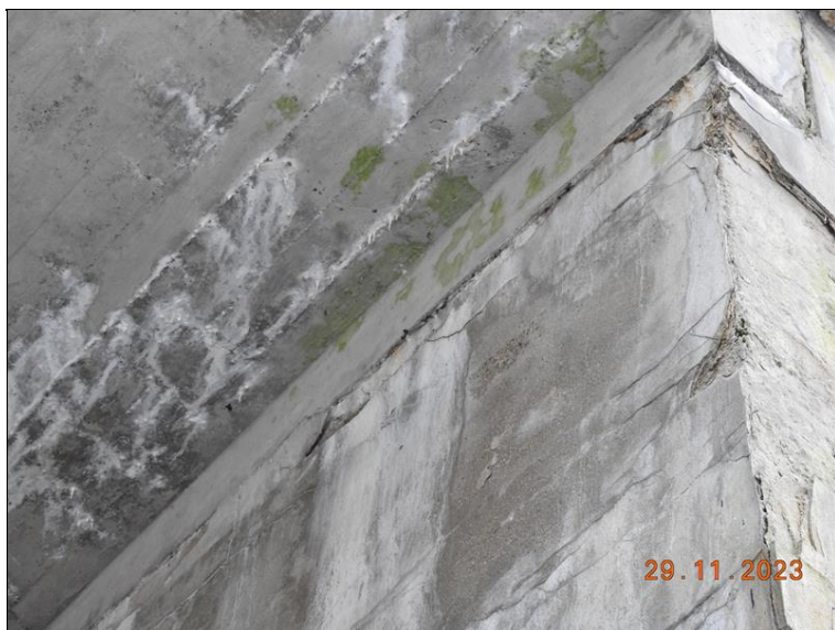
021_OP1 detail vlevo. Separace omítkové vrstvy.jpg
