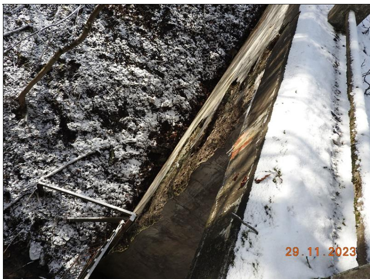
025_Pravé křídlo OP1 detail. Degradace betonu, separace omítkové vrstvy.jpg
