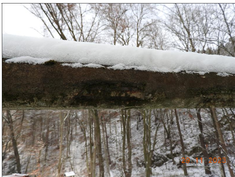
019_Zábradlí detail. Korozie výztuže.jpg
