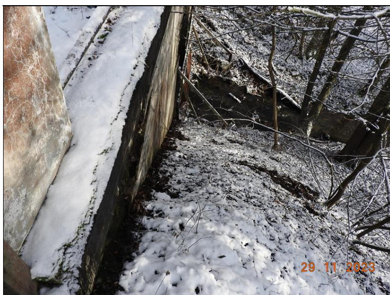
008_Pravé křídlo OP1. Degradace betonu, separace omítkové vrstvy, bionapadení.jpg
