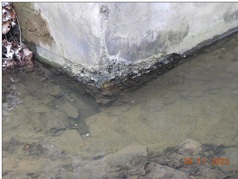
024_OP2 detail. Vymletí betonu ve spodní části.jpg
