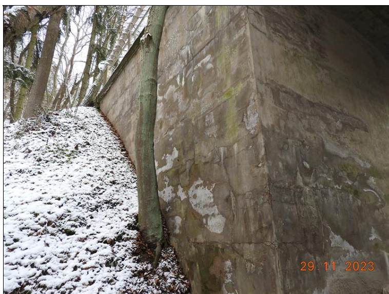
007_Levé křídlo OP2. Degradace betonu, separace omítkové vrstvy v horní části, bionapadení.jpg
