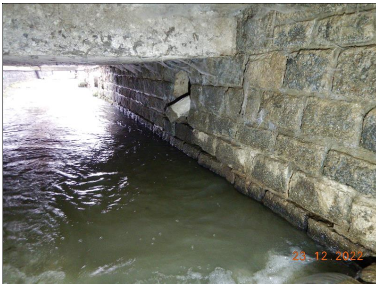
Degradace zdiva opěry 01 cca 10 m od čela na výtoku.
