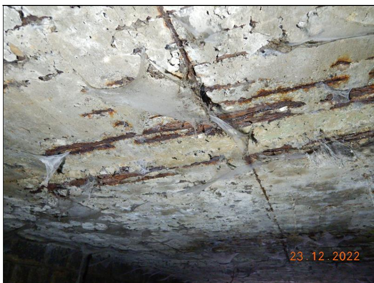
Degradace betonu nosné konstrukce a silná koroze výztuže na levé straně mostu - cca na 1/3 přemostěné délky toku.
