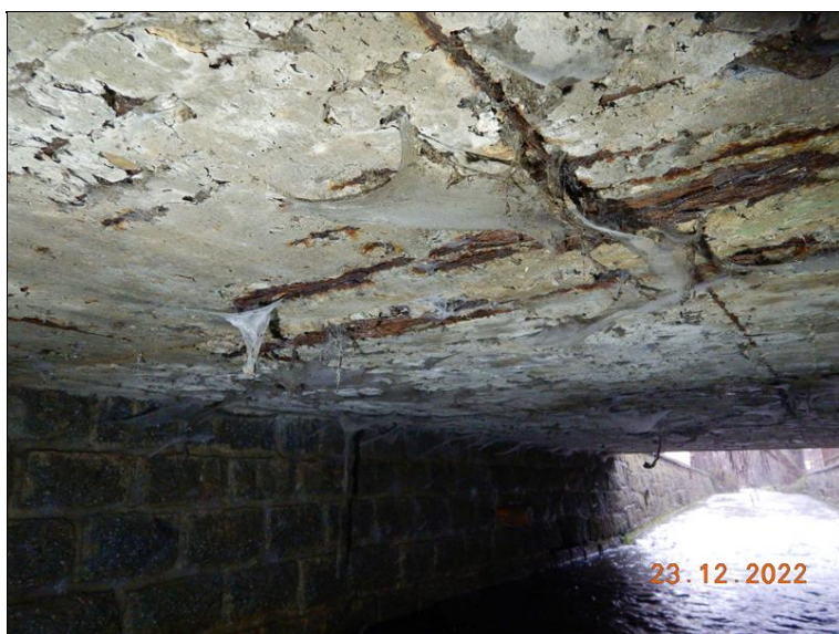
Degradace betonu nosné konstrukce a silná koroze výztuže na levé straně mostu - cca na 1/3 přemostěné délky toku.
