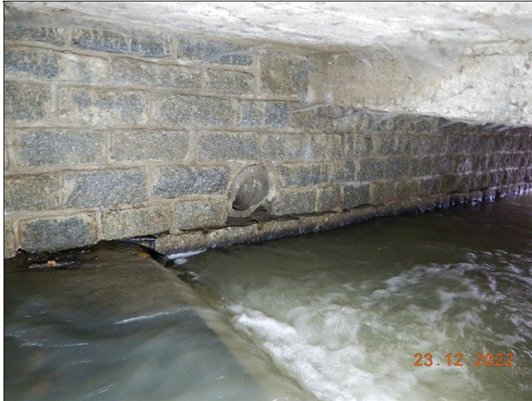
Degradace zdiva opěry 02 cca 10 m od čela na výtoku.
