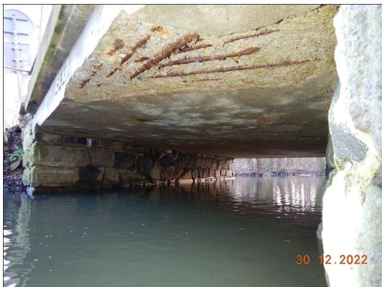
Podhled NK z levé strany od O1. Ve velké ploše odpadlá krycí vrstva, odhalená korodující výztuž.
