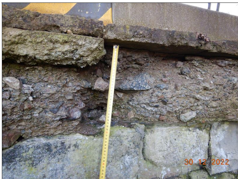
Silná hloubková degradace římsy na levé straně nad O2.
