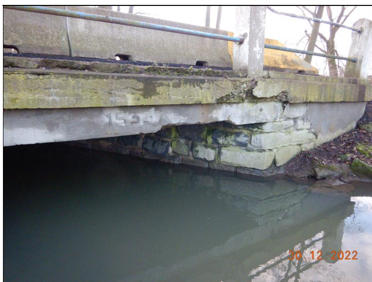
Silná degradace římsy na levé straně.
