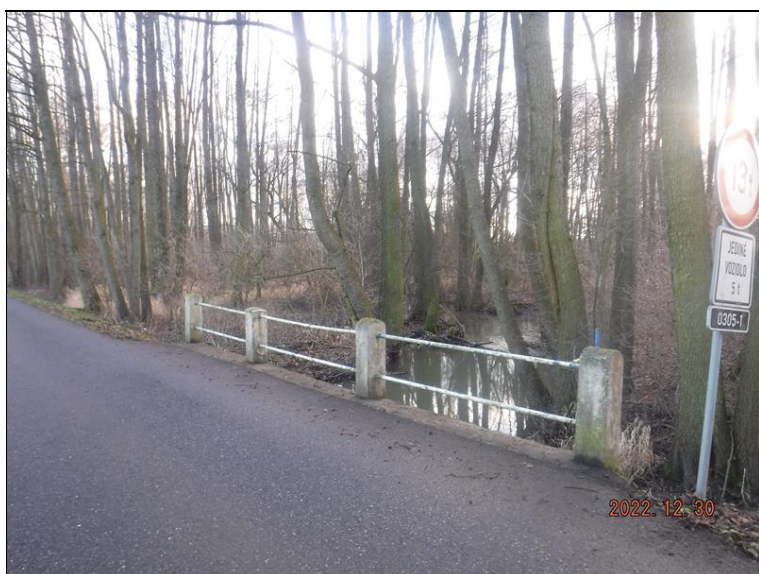
Pohled na pravé zábradlí. Poruchy PKO.
