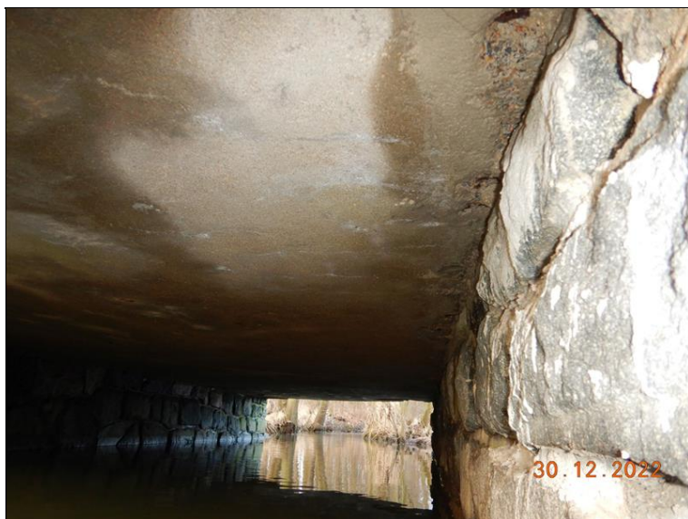
Podélné trhliny ve spodním líci betonové desky, vyplněné výluhy.
