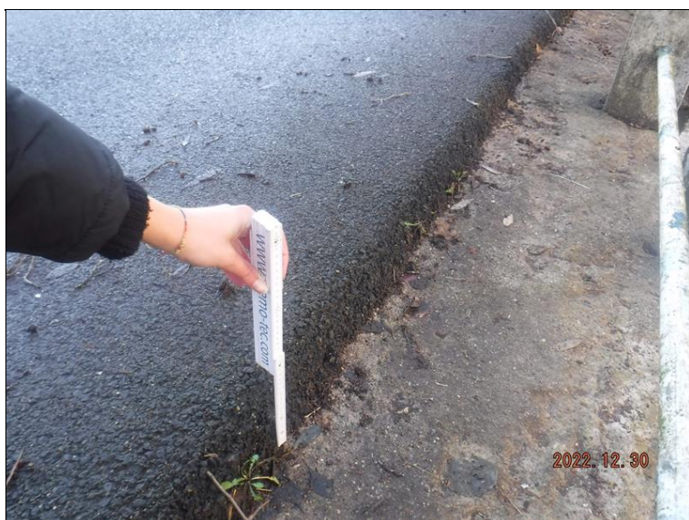
Vozovka na mostě převýšená o cca 70 mm.
