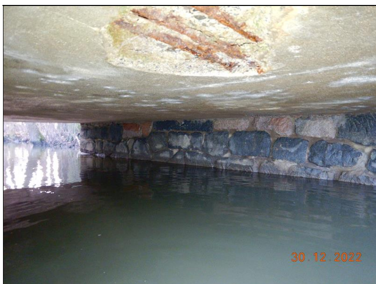
Podhled NK z levé strany od O2. V ploše odpadá krycí vrstva, odhalená korodující výztuž.
