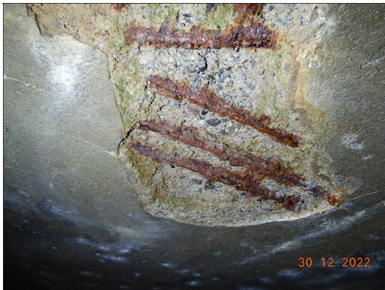
Detail korodující výztuže.
