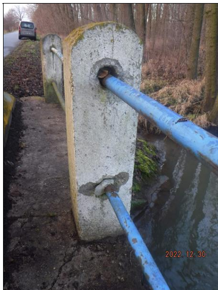
Detail uchycení vodorovných trubek na do sloupků na levé straně (trubky se volně hýbají), prostor za betonovým svodidlem.
