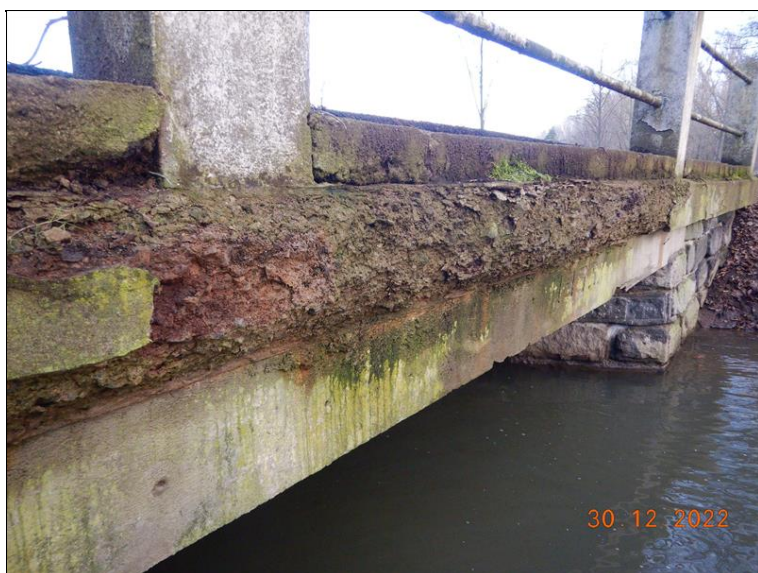
Silná degradace římsy na pravé straně.
