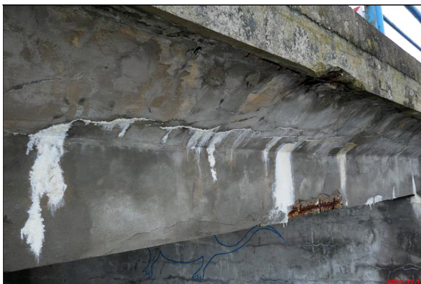
14_vyluhy na NK_koroze vyztuze_degradace rimsy.JPG
