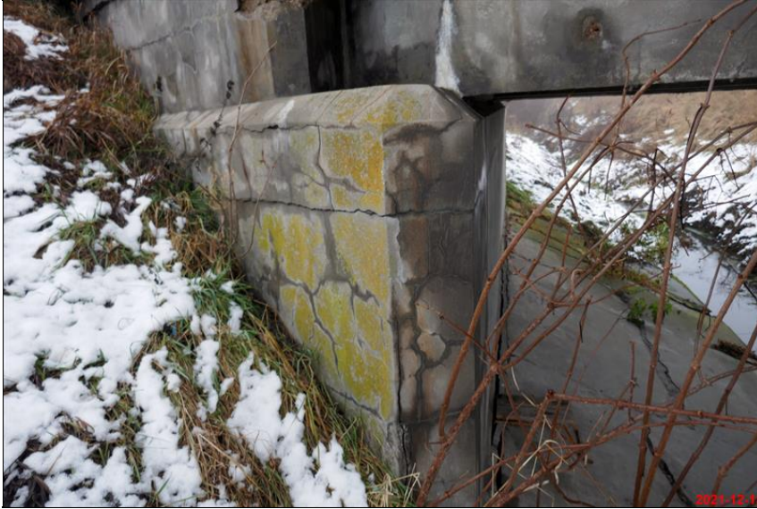
16_trhliny v opere.JPG
