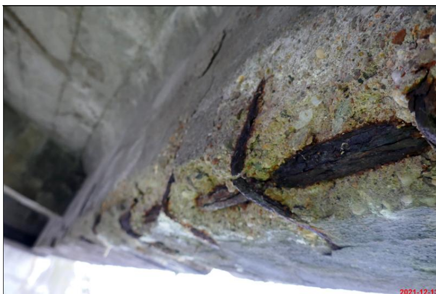
24_koroze vyztuze_prerezly trminek.JPG
