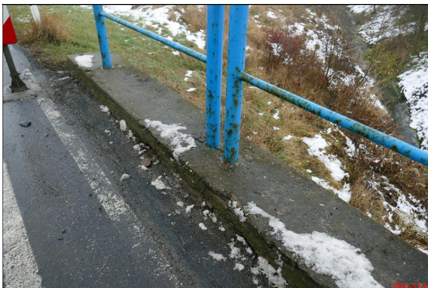
06_trhliny v rimse.JPG
