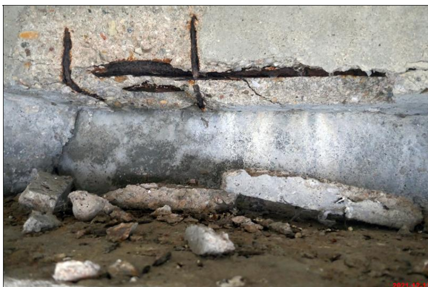
27_prokorodovany trminek pricniku_koroze vyztuze.JPG
