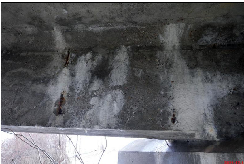
18_koroze vyluhy na NK.JPG
