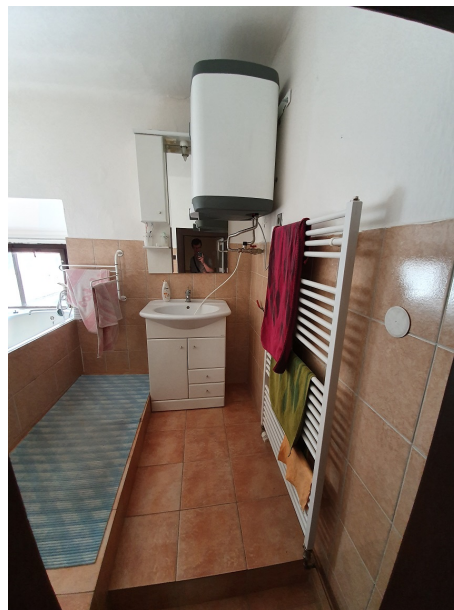
Obrázek 5 – Elektrický bojler v koupelně ve 2. NP
