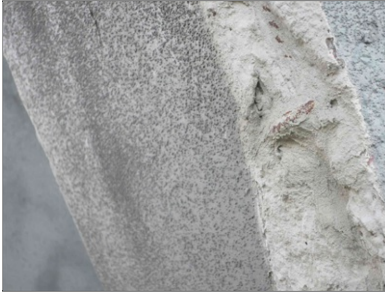
nekvalitně provedená sanace vzpěry P3
