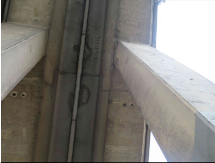
stopy po průsacích mezi nosníky
