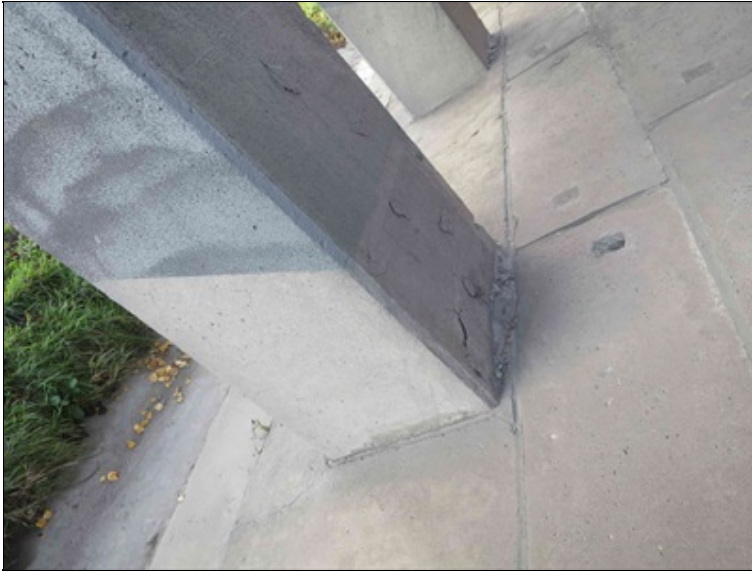
separace krycí vrstvy nad korodující výztuží u vzpěry P2
