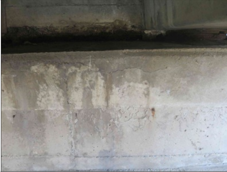
trhliny v hraně ÚP O4 jsou charakteristické pro separaci krycí vrstvy nad korodující výztuží.
