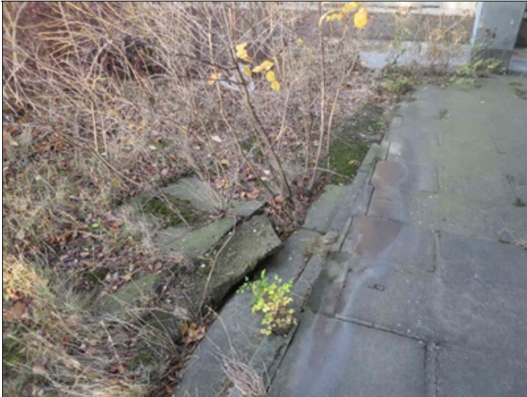
rozpad odvodňovacích skluzů
