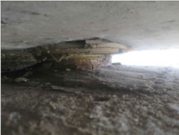
totální koroze ložiska
