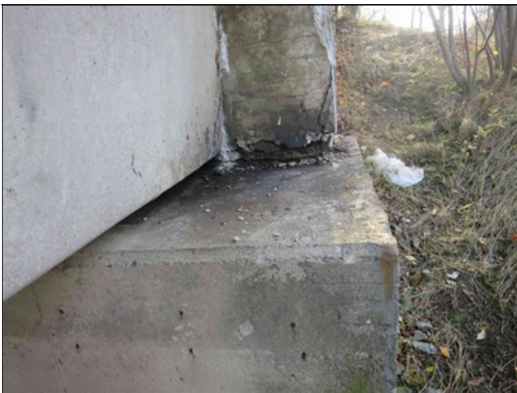
stopy po průsacích na ÚP O4
