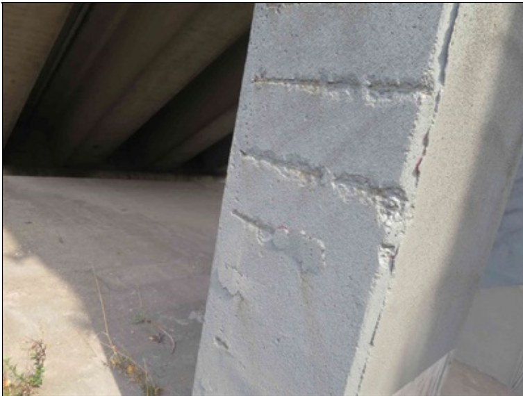
nekvalitně provedená sanace vzpěry v místě obnažené korodující smykové výztuže
