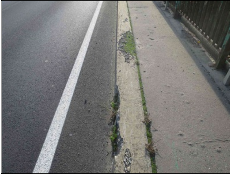
rozpad betonu obruby
