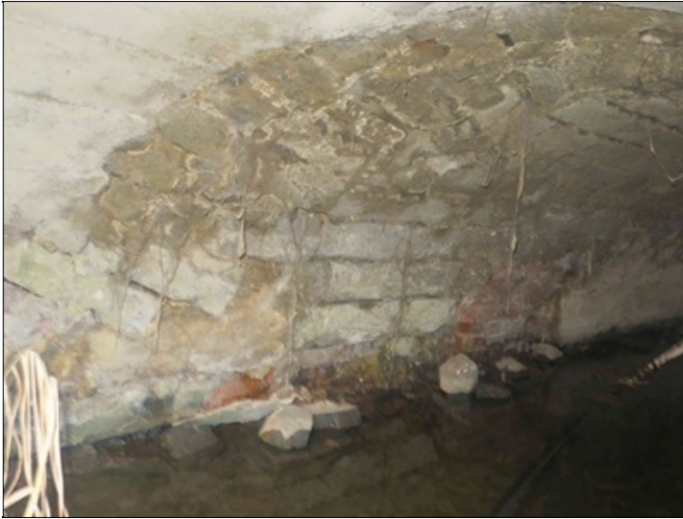
rozpad zdiva opěry 1
