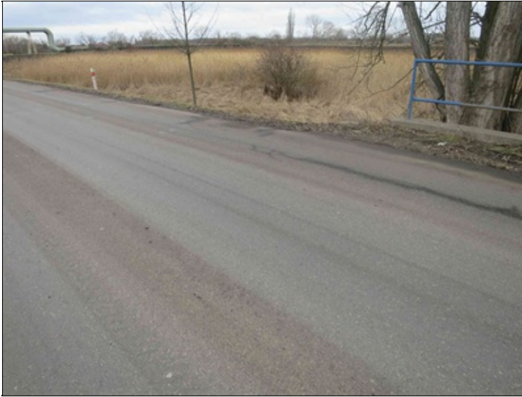
deformace krytu vozovky
