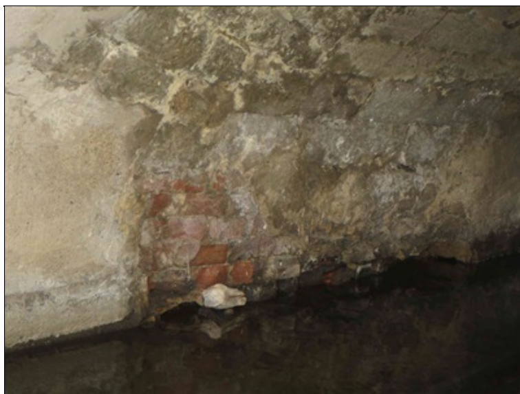
rozpad zdiva původní části opěry 2 v úrovni kolísání hladiny vodoteče
