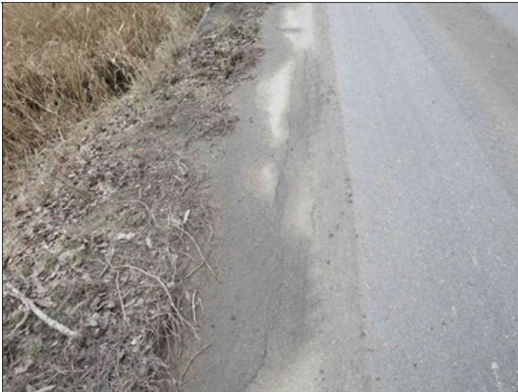
deformace krajnice vozovky
