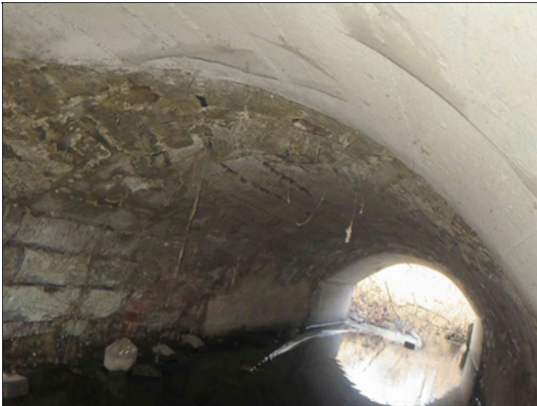
otevřené spárování a deformace původní klenby ve vrcholu
