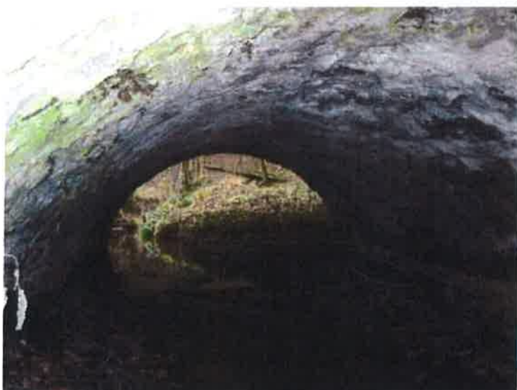
336-006 Podhled NK. Lokální výluhy.
