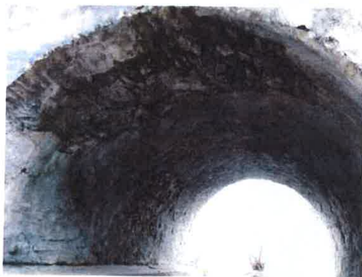
336-007 Odpadlý torkret na klenbě L.
