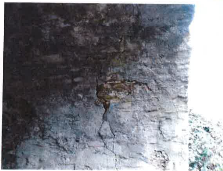
336-007 Trhlina v klenbě cca 0,8m od P okra
