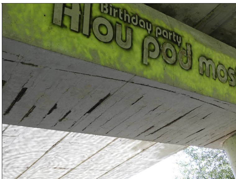
Podhled staviva Pi9 - zkorodovaná betonářská výztuž prokreslená na povrchu konstrukce
