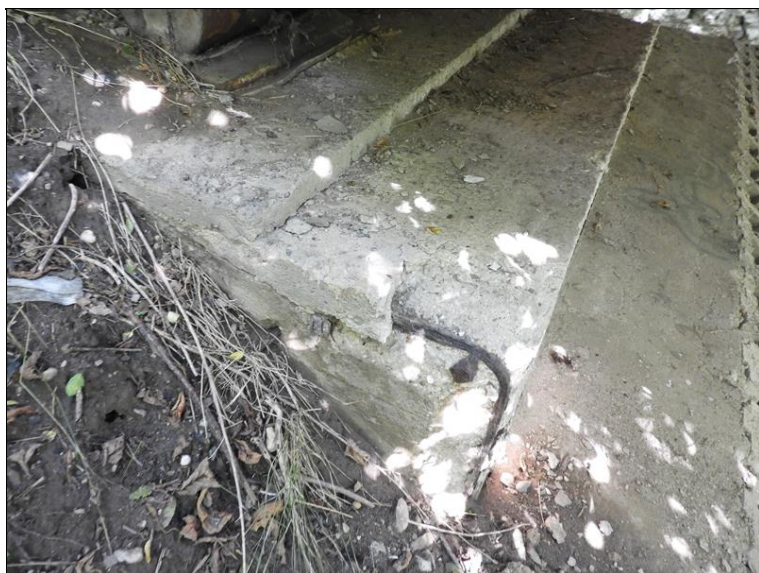
Úložný práh OP11 - rozpad betonu, odhalení a koroze výztuže
