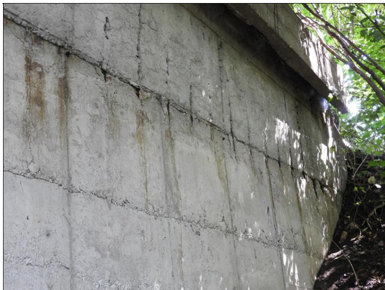
Detail křídla OP1 vlevo - degradace betonu s odhalením a korozí výztuže, stopy po zatékání a bionapadení
