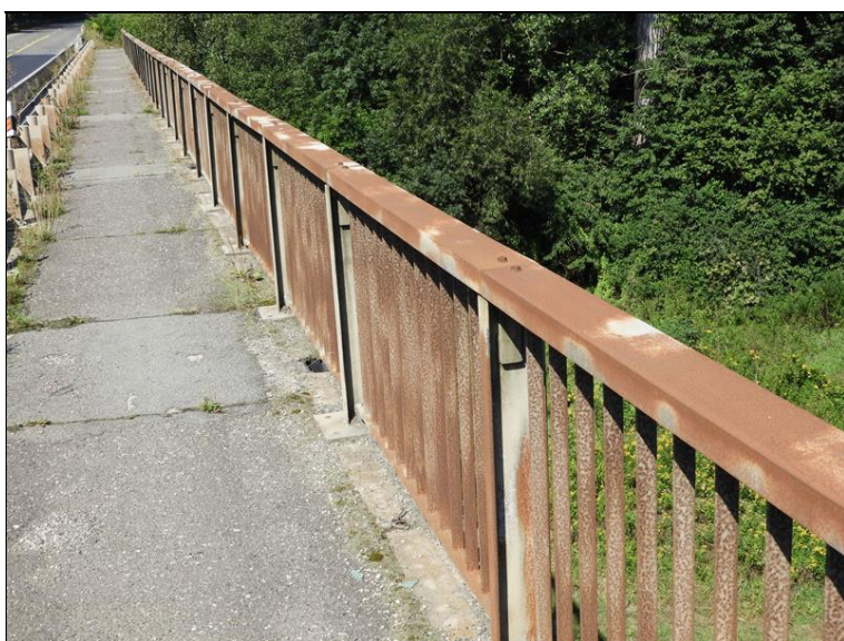
Pohled na zábradlí vpravo - degradace nátěru a koroze
