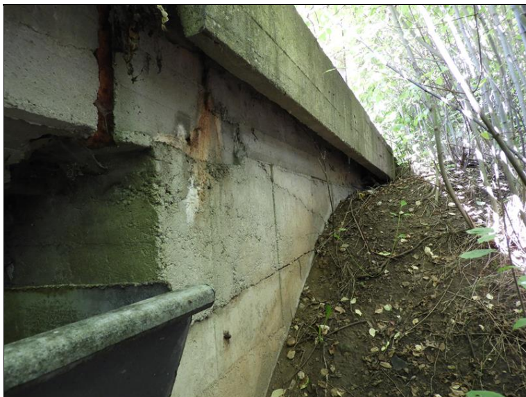
Pohled na křídlo OP11 pravé
