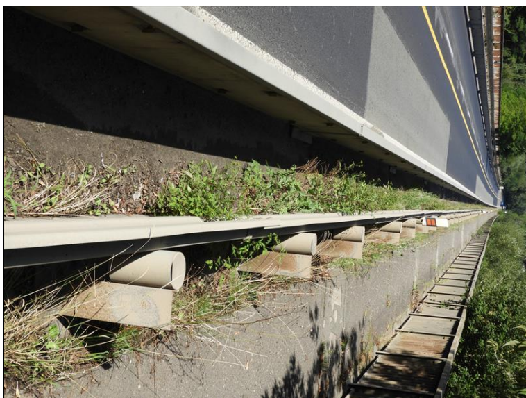
Pohled na krajnici zprava - prorůstající vegetace a nánosy podél krajnice
