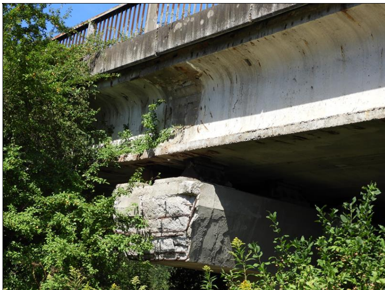
Pohled na stativo Pi3 vlevo - hloubková degradace betonu a koroze výztuže, zatékání do kotevní oblasti nosníků
