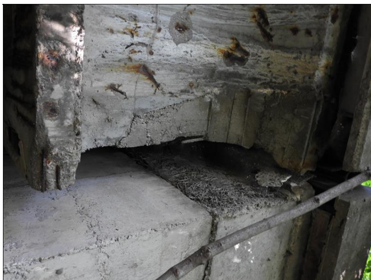
Uložení NK na OP1 - zatékání do kotevní oblasti nosníků, degradace betonu a koroze výztuže
