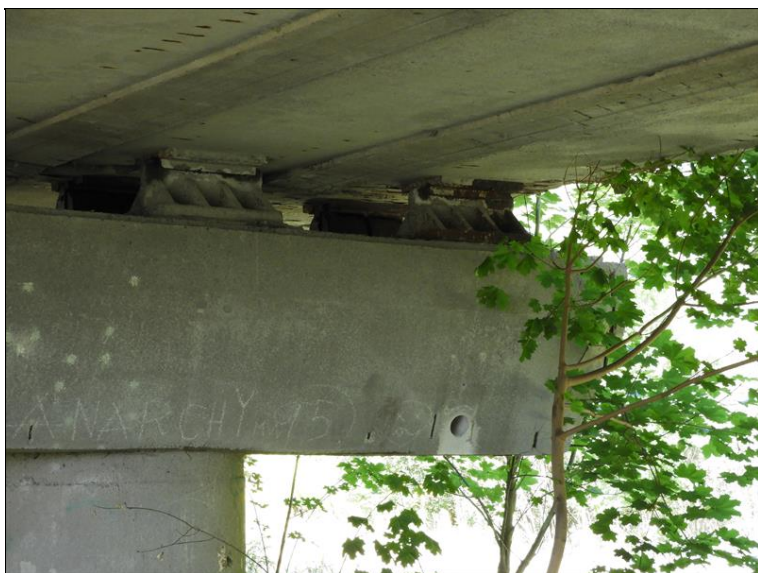
Stolicové ložisko na Pi3 - rovnoměrná povrchová koroze
