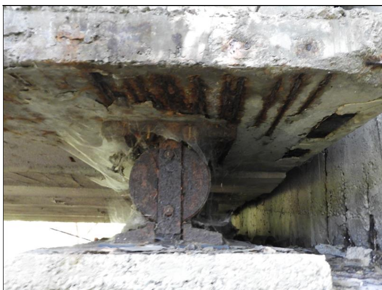
Válcové ložisko na OP1 - plátková koroze
