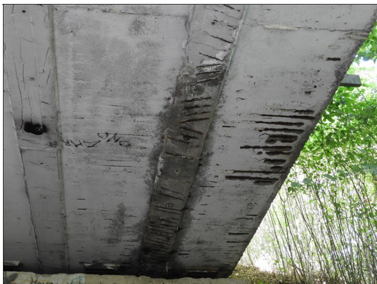
Podhled NK10 vpravo - odtržení krycí vrstvy výztuže v důsledku zvětšování objemu korozních produktů výztuže, stopy po zatékání
