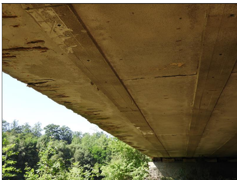
Pohled NK2 vlevo - odtržení krycí vrstvy výztuže v důsledku zvětšování objemu korozních produktů výztuže, stopy po zatékání
