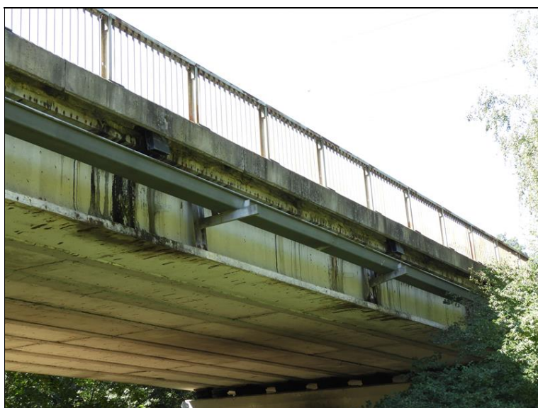
Pohled na bok NK9 - odtržení krycí vrstvy výztuže v důsledku zvětšování objemu korozních produktů výztuže, zatékání pod římsou
