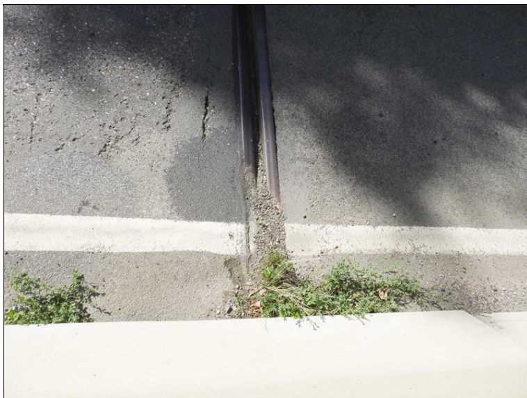
Detail mostního závěru - trhliny podél lamel MZ, těsnící profil zanesený nečistotami, prorůstající vegetace
