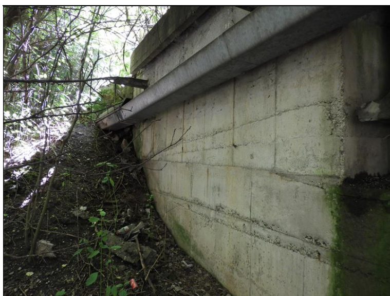
Pohled na křídlo OP1 pravé
