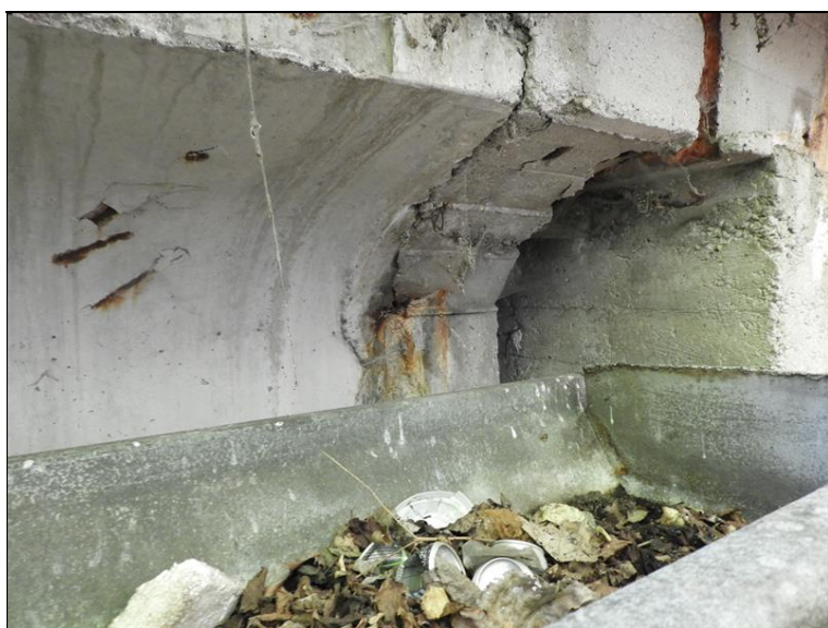
Uložení NK na OP11 - zatékání do kotevní oblasti nosníků, degradace betonu a koroze výztuže
