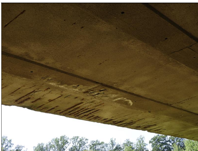
Podhled NK3 vlevo - odtržení krycí vrstvy výztuže v důsledku zvětšování objemu korozních produktů výztuže, stopy po zatékání
