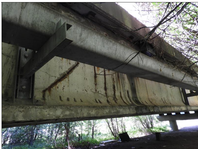
Pohled na bok NK1 - odtržení krycí vrstvy výztuže v důsledku zvětšování objemu korozních produktů výztuže, zatékání pod římsou
