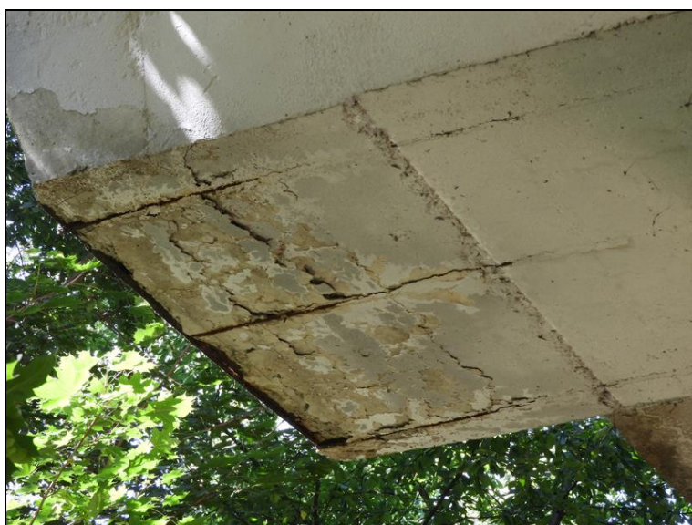
Detail staviva Pi10 - odtržení krycí vrstvy výztuže v důsledku zvětšování objemu korozních produktů výztuže
