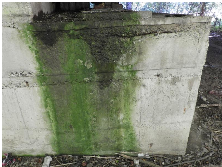
Úložný práh OP1 - hloubková degradace betonu, masivní zatékání a nazelenalý povlak
