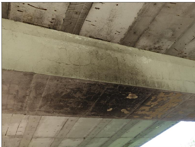
Podhled staviva Pi10 - kouřové zplodiny
