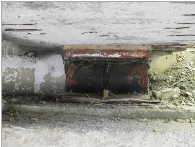
Válcové ložisko na OP11 - plátková koroze
