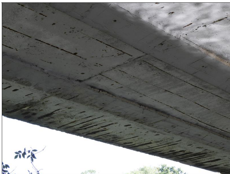
Podhled NK8 vlevo - odtržení krycí vrstvy výztuže v důsledku zvětšování objemu korozních produktů výztuže, stopy po zatékání
