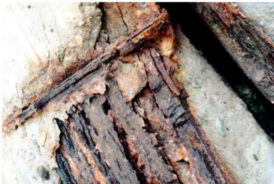
Vrstevnatá koroze výztuže konzoly.
