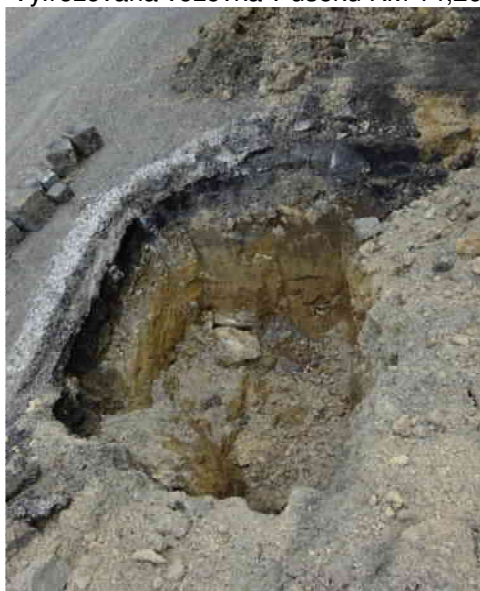
Sonda v krajnici km 14,500
