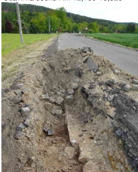
Sonda v krajnici km 12,800
