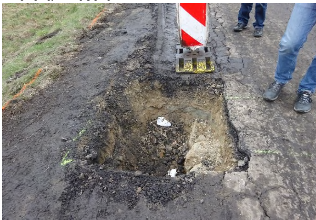
Sonda na krajnici - neúnosné, chybějící štět
