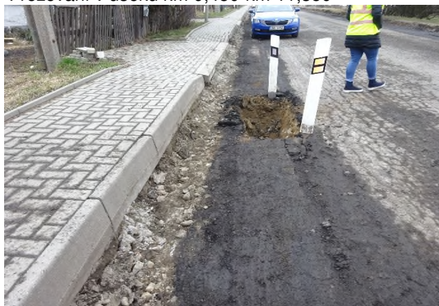
Sonda na krajnici - neúnosné, chybějící štět
