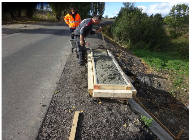
Povádění římsy propustku v KM 11,738
