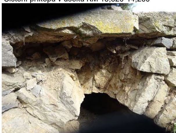
Poškození čela propustku v KM 11,738
