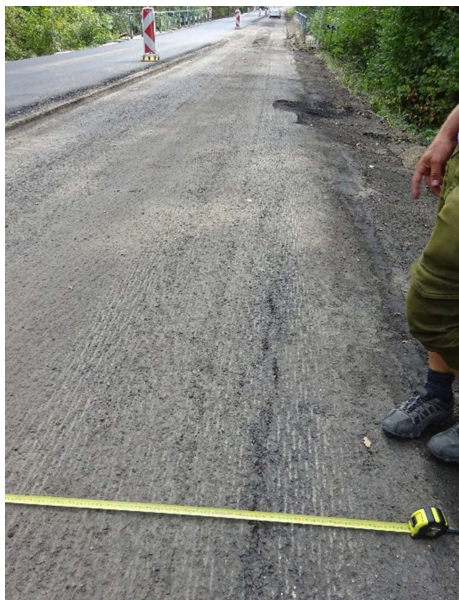
Trhliny v místě nestabilní krajnice v KM 13,320-14,260
