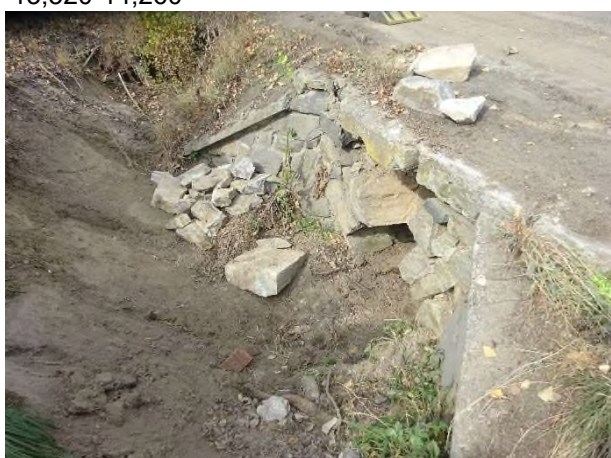
Poškození čela propustku v KM 11,738
