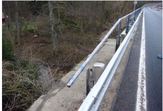
Zcela zkorodované zábradlí na mostu ev.č. 112-011
