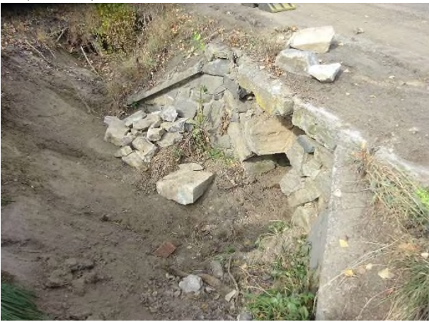
Poškození čela propustku v KM 11,738
