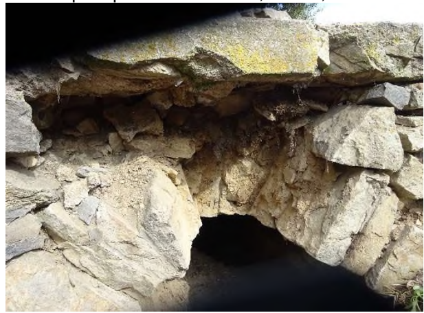
Poškození čela propustku v KM 11,738
