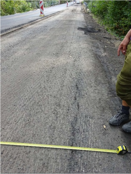
Trhliny v místě nestabilní krajnice v KM 13,320-14,260
