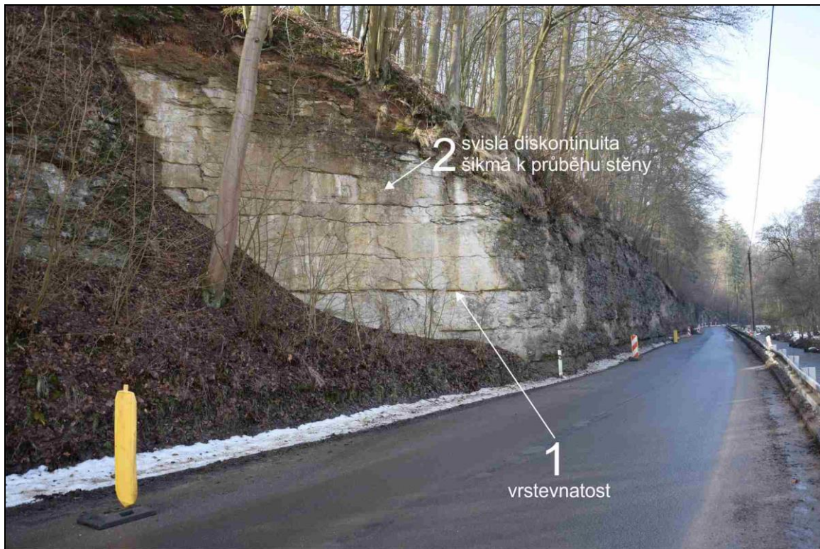
Foto 1 Výrazná stěna na jihovýchodním okraji nestabilního území kopírující systém diskontinuit 2. Dobře patrná je lavičovitá vrstevnatost označená jako systém diskontinuit 1. Dále směrem k severozápadu pokračuje nestabilní stěna odřezu silnice II/277 paralelní s jejím průběhem. Na fotografii je dobře patrné, že před patou stěny zůstává jen nepatrný nebo dokonce vůbec žádný prostor pro akumulaci úlomků skalních řícení.
