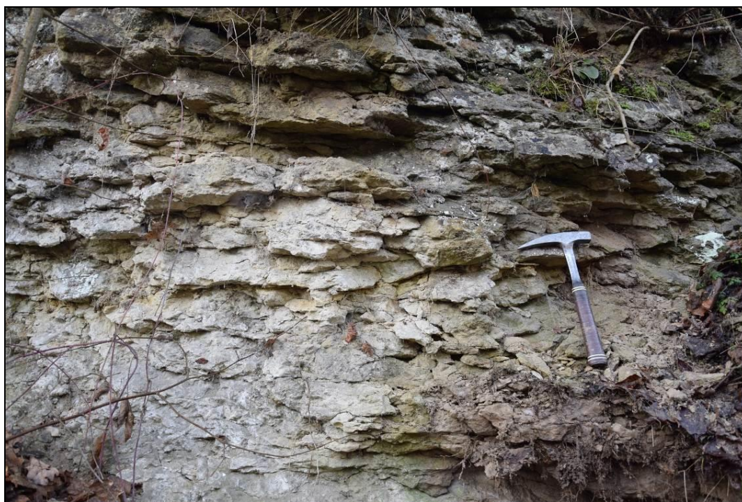
Foto 10 Ukázka nestabilního silně rozvolněného líce stěny. Dobře patrná je hustá síť diskontinuit, které vyčleňuje dílčí bloky, v dané pozici velmi nestabilní a bezprostředně hrozící pádem.
