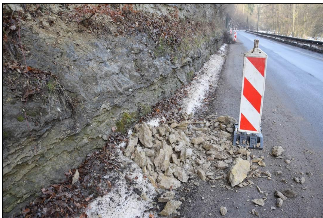
Foto 12 Ukázka akumulace úlomků pískovců po řícení dílčí části stěny (odlišná od foto 11). Dobře patrný je nedostatek akumuláčního prostoru, který se projevuje dopadem úlomků až do prostoru samotné silnice II/277.
