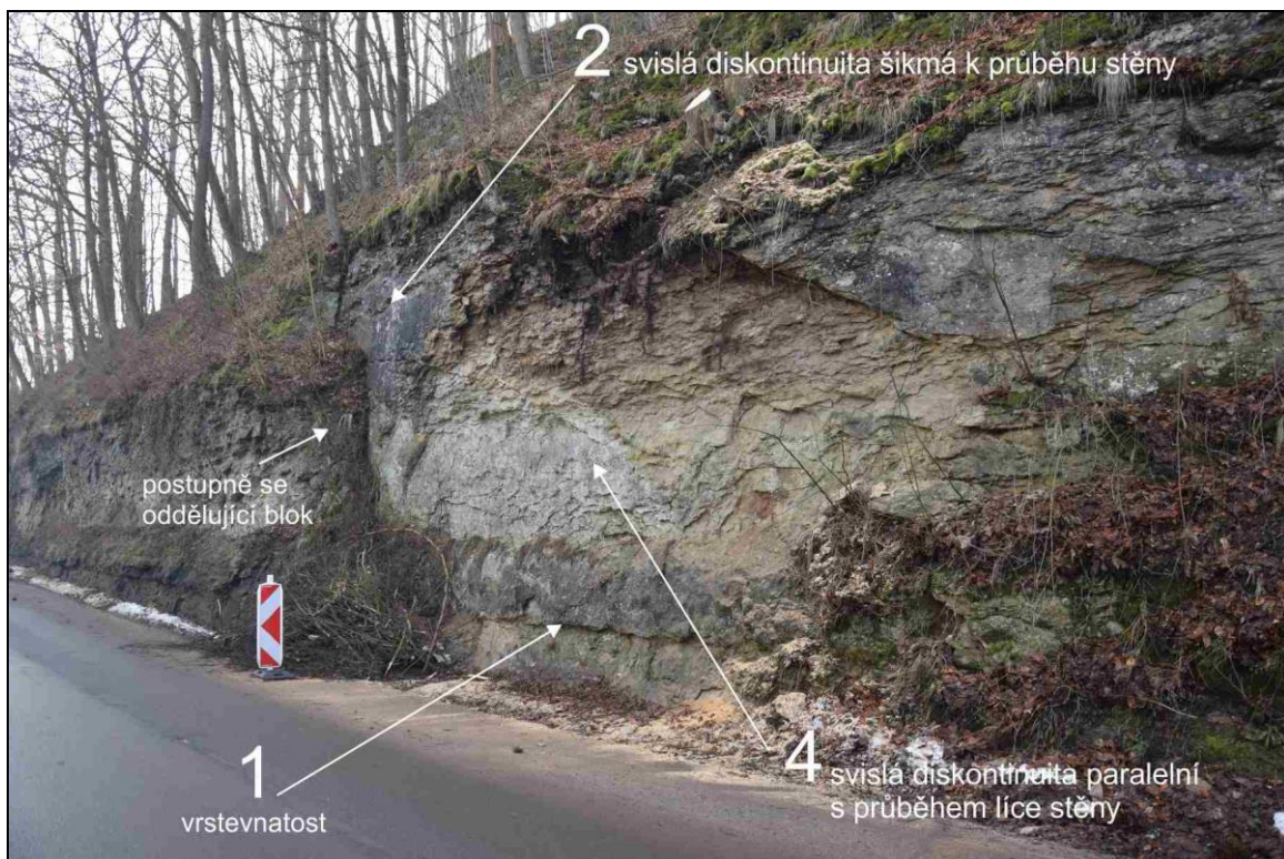
Foto 2 Odlučná oblast řícení části stěny (dle ústního sdělení pana Petra Valkouna k řícení došlo 6. února 2021 v 16:30). Zřetelné jsou diskontinuity, reprezentující dílčí systémy diskontinuit 1, 2 a 4, které se uplatnily při nestabilitě stěny.
