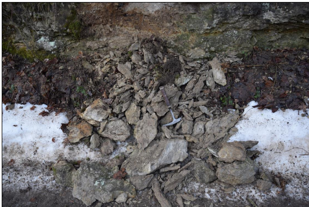
Foto 11 Ukázka akumulace úlomků pískovců po řícení dílčí části stěny.
