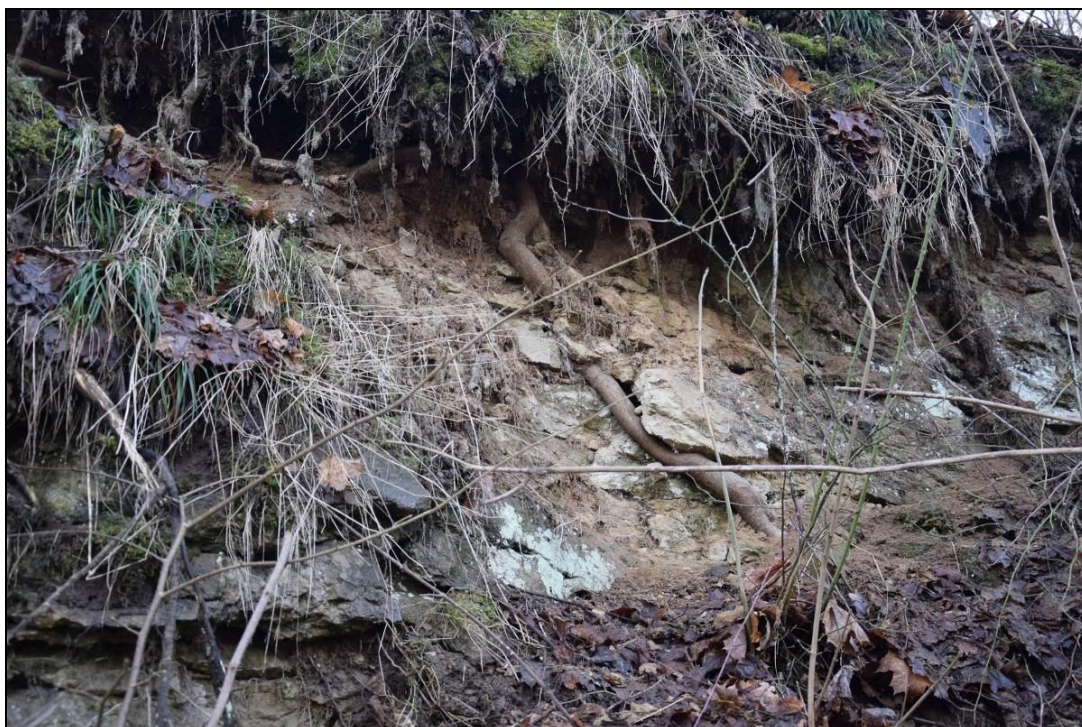
Foto 14 Obdobně jako na foto 13, obnažený kořen po dílčím opadu nestabilní části, dobře patrné jsou dílčí nestabilní úlomky v okolí obnaženého kořenu.
