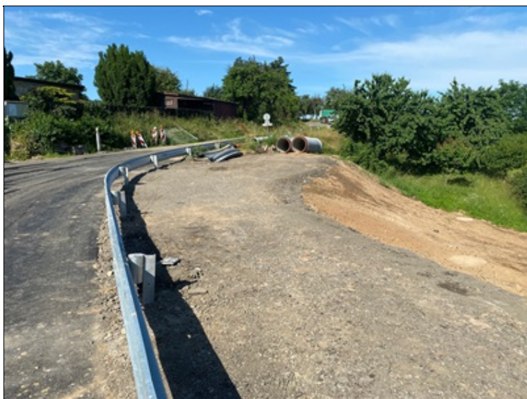
Rozšířená krajnice vpravo za svodidlem (prostor pro budoucí veřejný chodník), zpevněná asfaltovým recyklátem
