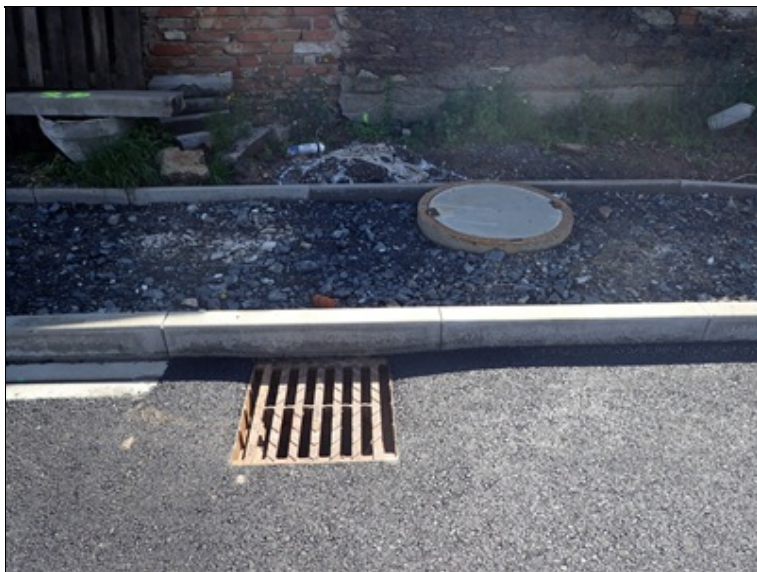
Revizní šachta ŠP2 DN 1000 v chodníku s poklopem DN 600 třídy D400
