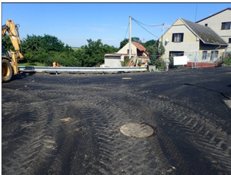
Revizní šachta ŠP1 DN 1000 ve vozovce s poklopem DN 600 třídy D400
