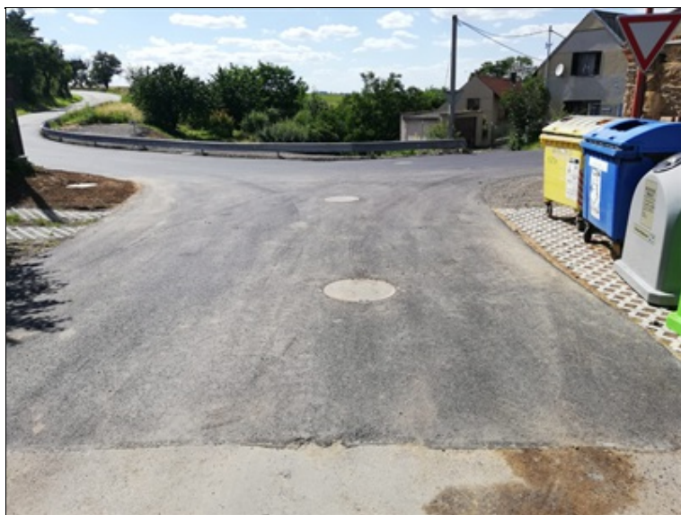
Pohled od připojované místní komunikace po směru toku v ose propustku (stoky "1")
