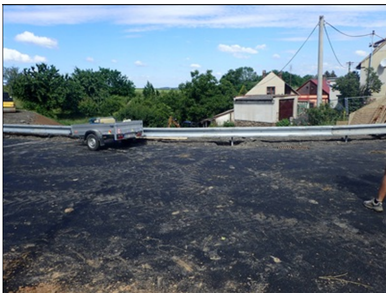
Ocelové svodidlo na vnitřním okraji III/12550 - pohled z vnitřní strany (z vozovky)
