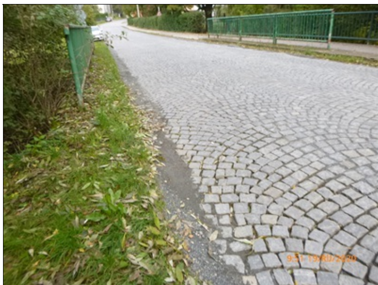
Stav vozovky na mostě, římsy jsou v úrovni terénu.
