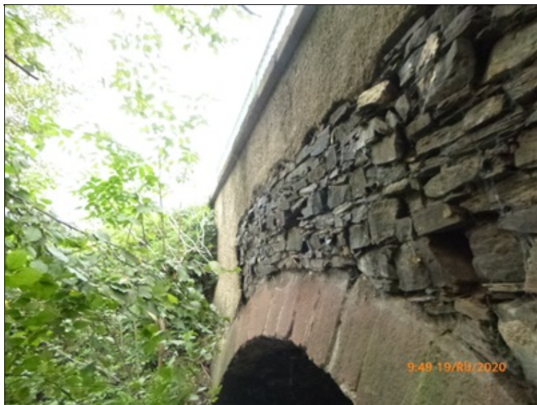
Poruchy, ztráta stability čelní zdi vpravo.
