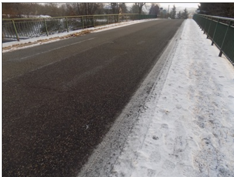
Vozovka na mostě - opakovaně příčné trhliny, podélná u obrubníku
