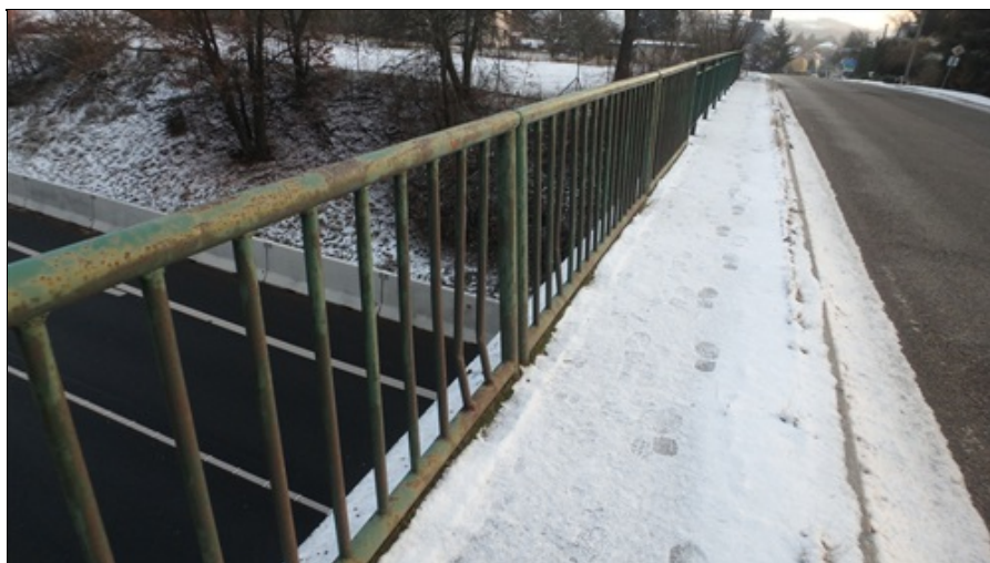
Deformovaná část náhradního zábradlí na levé římse
