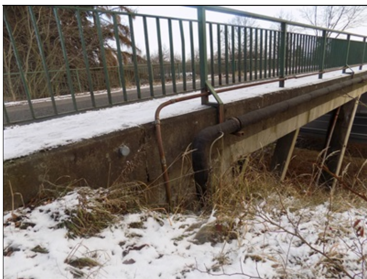
Potrubí a zkorodovaná, rozpojená chránička na pravé straně
