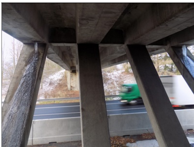
Chybějící svody odvodnění na pilíři P3
