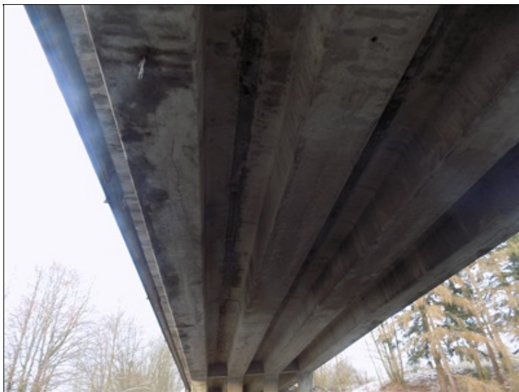
Pole 2 od pilíře P3, průsaky, voda v krajním nosníku
