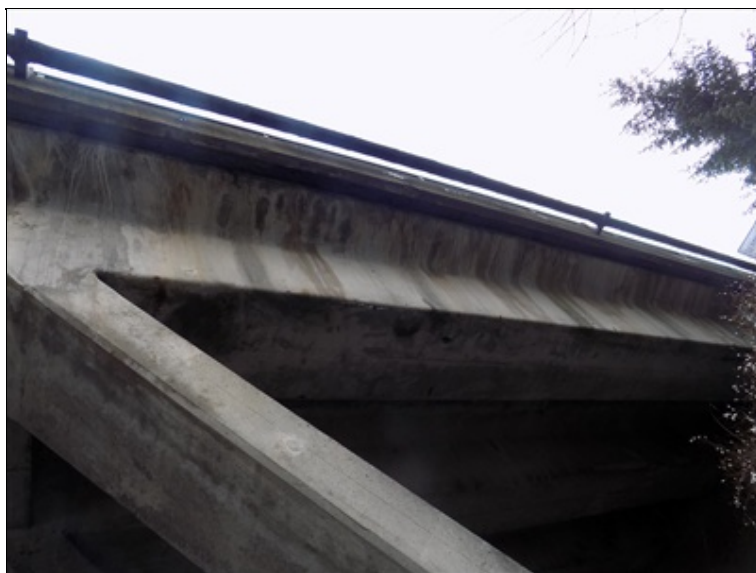
Pole 3 -podélná trhlina s výluhy na vnější hraně krajního nosníku
