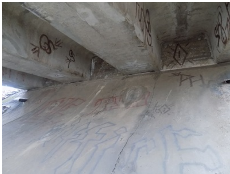
Koncový příčník nad opěrou OP4, průsaky, narušený beton
