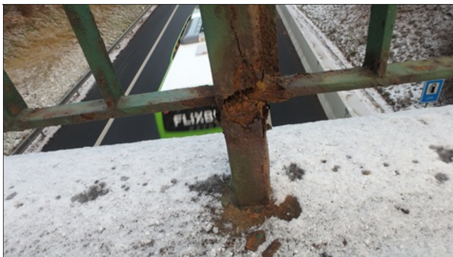
Zkorodovaný sloupek zábradlí a dolní madlo výplně
