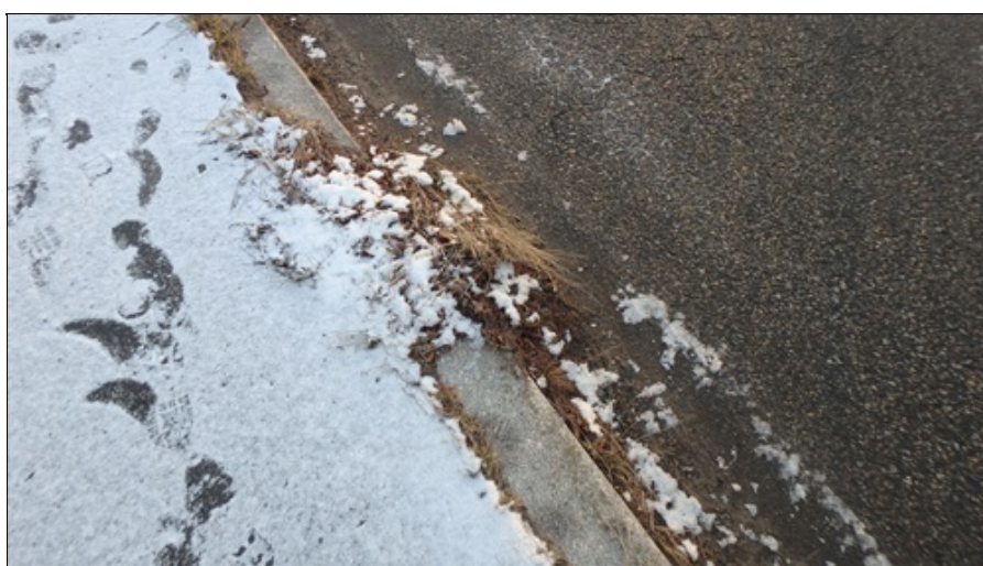
Zanesený a zarostlý odvodňovač
