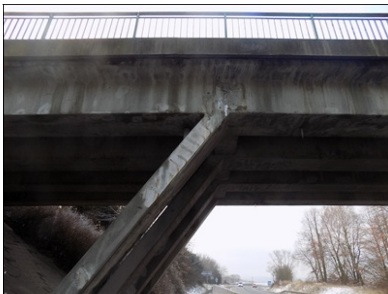
Levý bok pilíře P3, zatékání, odstřelující krycí vrstva betonu
