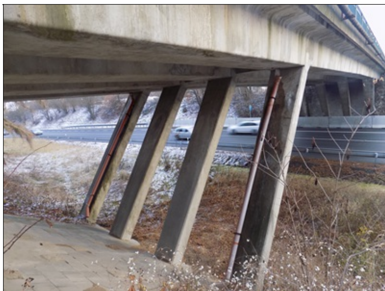
Pilíř P2, rozpojené svody odvodnění, zatékání na krajní stojky
