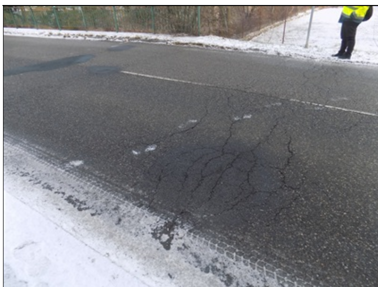
Trhliny ve vozovce za opěrou OP4, příčné trhliny a počínající výtluk ve vysprávce nad opěrou OP4
