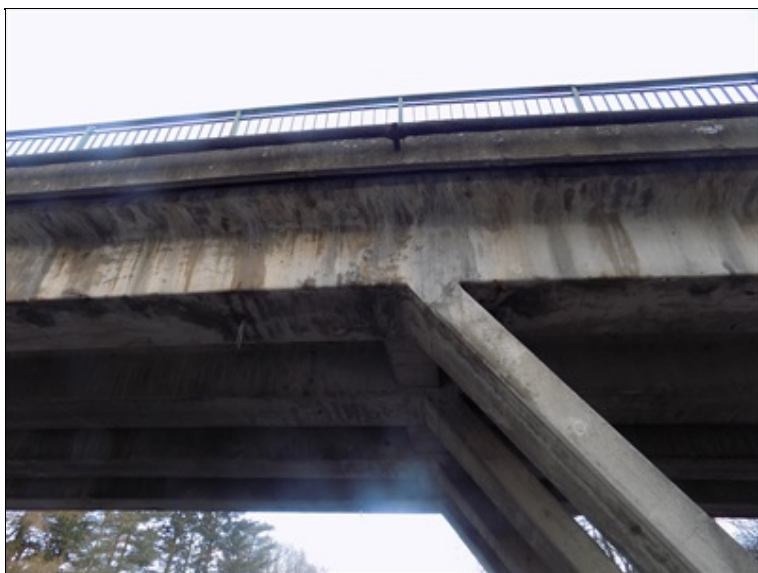
Zatékání pod římsou na bok nosné konstrukce
