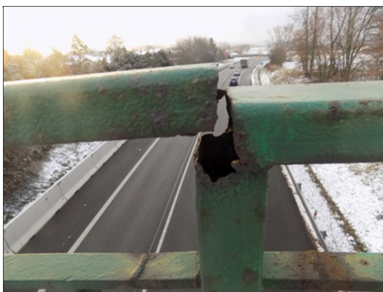
Překorodované horní madlo pravého zábradlí
