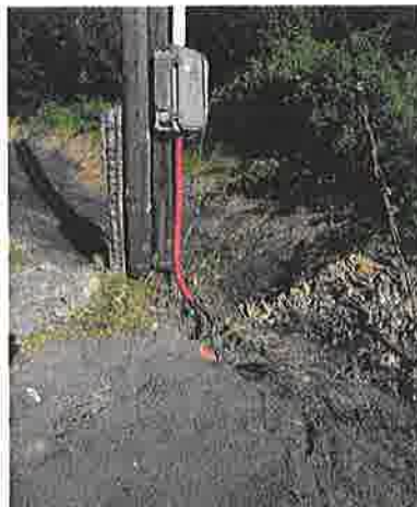
Nenormově uložený a opravený kabel CETIN
