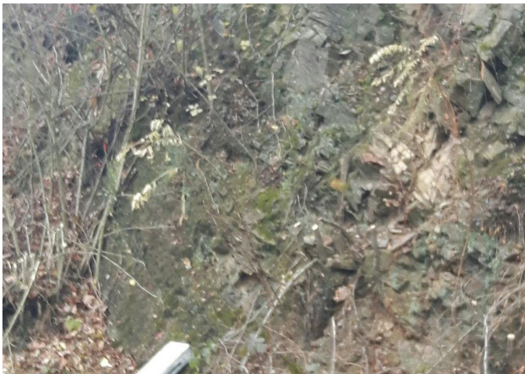
Obrázek 4 - Zcela zvětralý povrch skalní stěny
