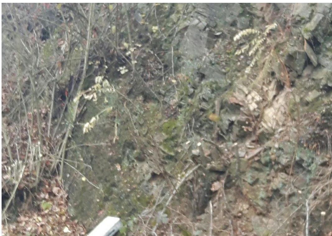
Obrázek 4 - Zcela zvětralý povrch skalní stěny
