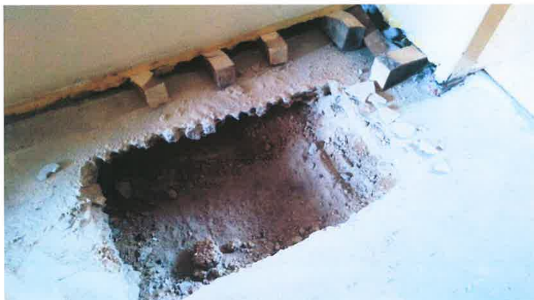
52.Porucha P – propad podlahy na chodbě a v pokoji v přízemí, zajištění příčky proti poklesu dřevěnými klíny, sondou bylo prokázáno, že pod podlahou není dutina
