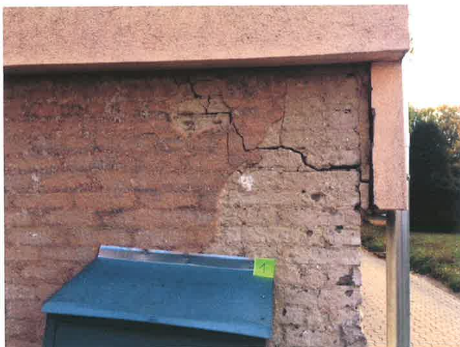
2.Porucha č.1 – poračování v západním štítu
