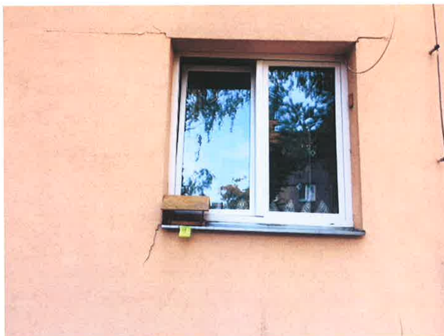
12. Porucha č.9 - trhliny v zateplovacím plášti
