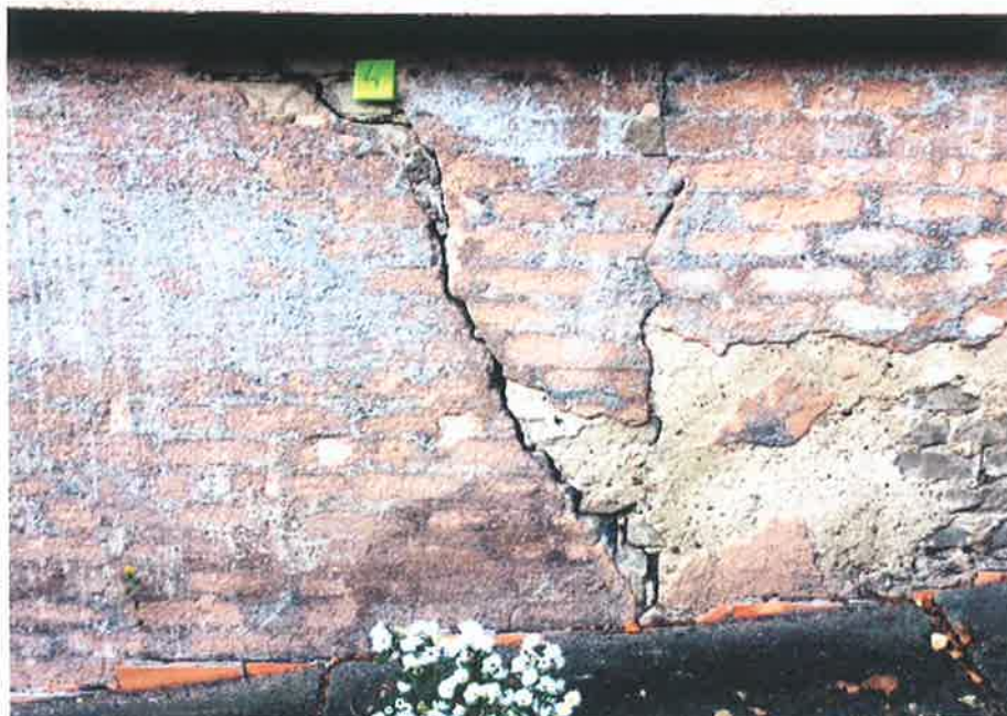
5.Porucha č.4 e východním štítu
