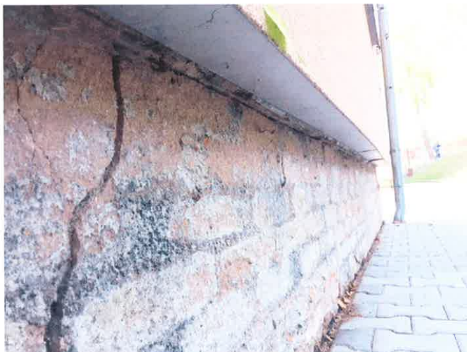
10.Porucha č.8 – pokračování trhliny ve vodorovné spáře
