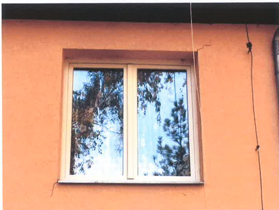
11.Porucha č.9 - trhliny v zateplovacím plášti
