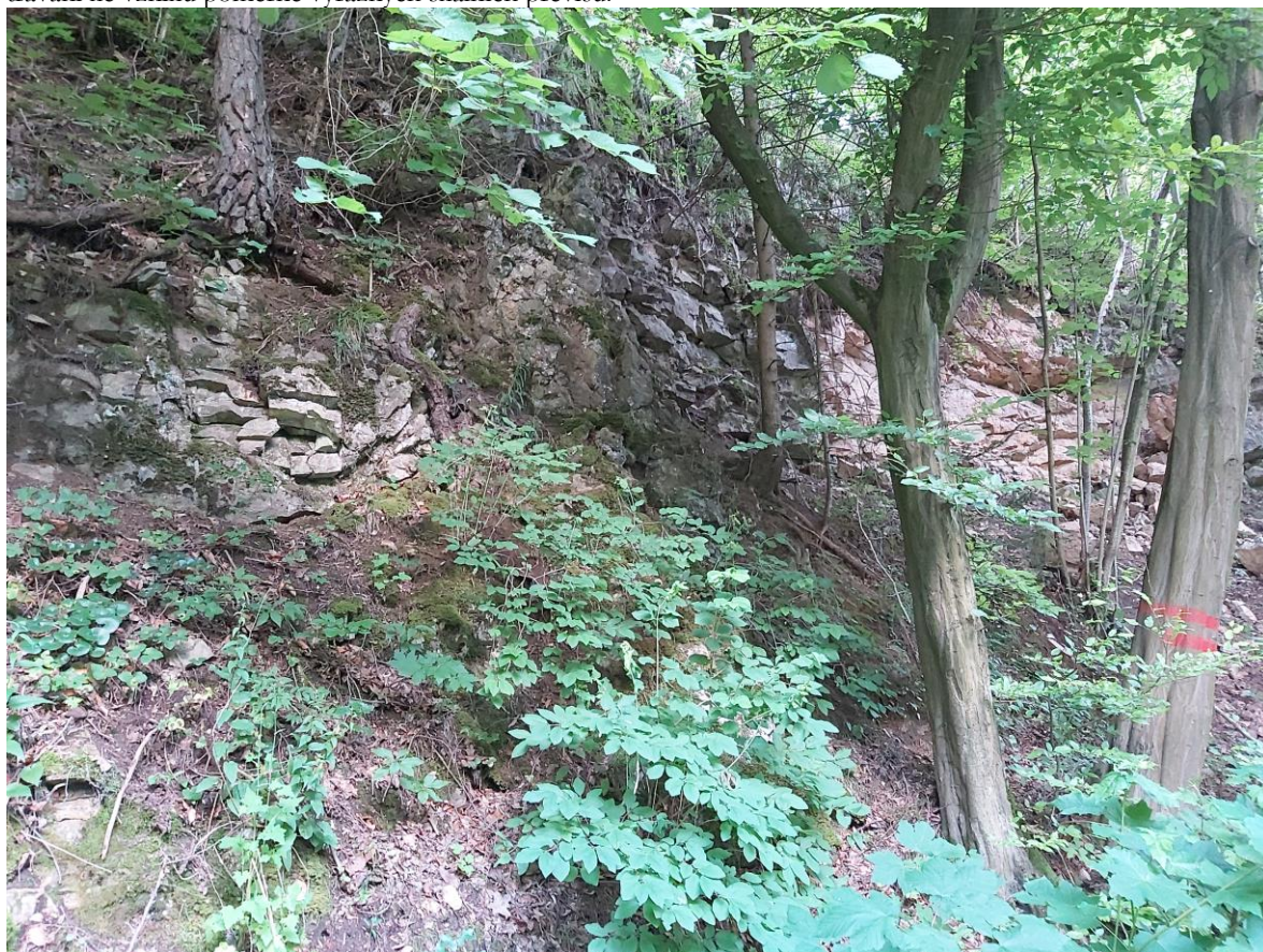
Foto 5 Skalní svah je v hojné míře porostlý náletovou vegetací, jejíž kořenový systém má na stabilitu masivu negativní vliv.
