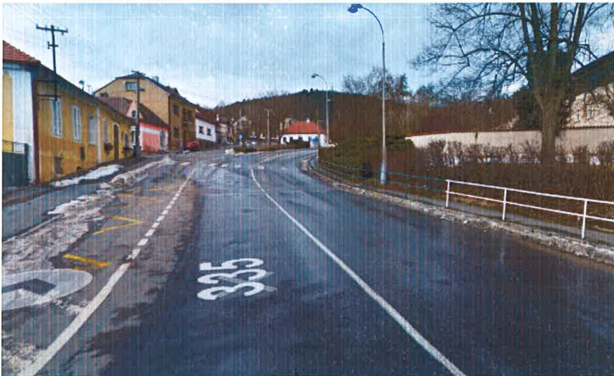
Etapa 3 – II/335 – ztráta protismykových vlastností, deformace, síťové trhliny
