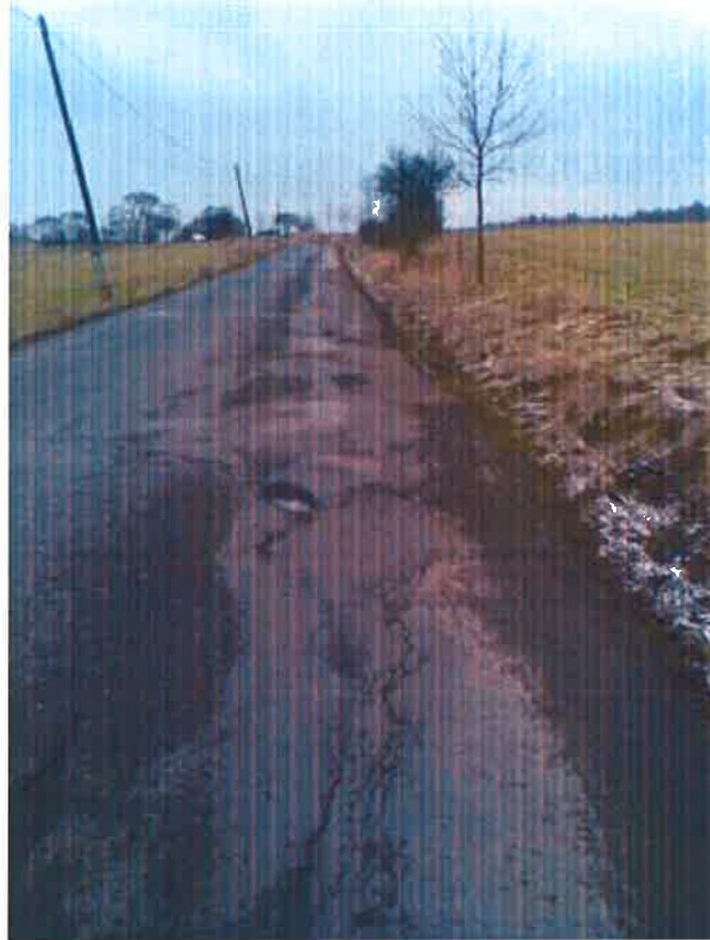
Etapa 1 před Dojetřicemi – deformace krajnic, síťové trhliny, vysprávkky
