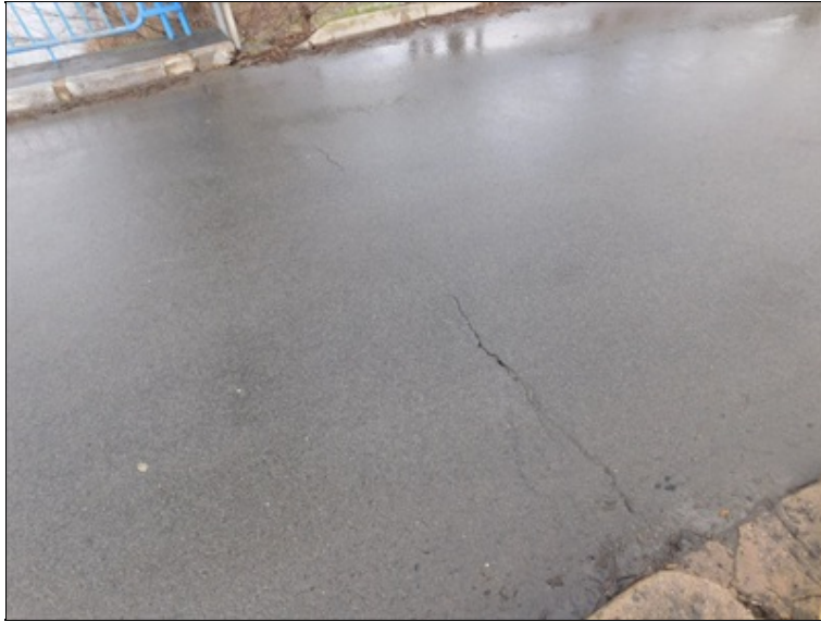
Trhlina ve vozovce za opěrou 4.
