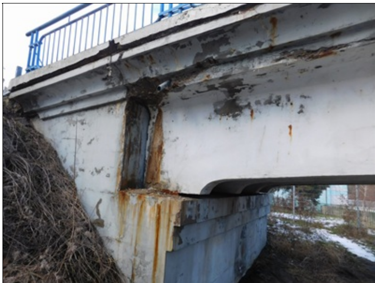
Zatékání na pravém boku opěry 1.
