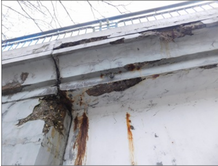
Degradace betonu konzoly a hrany závěrné zídky vlevo na opěře 4.
