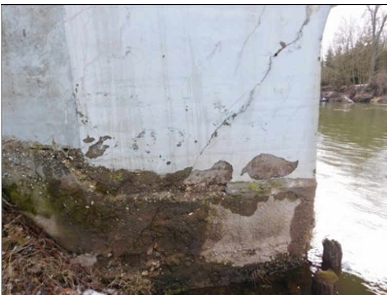
Trhlina v pilíři 3 vlevo.
