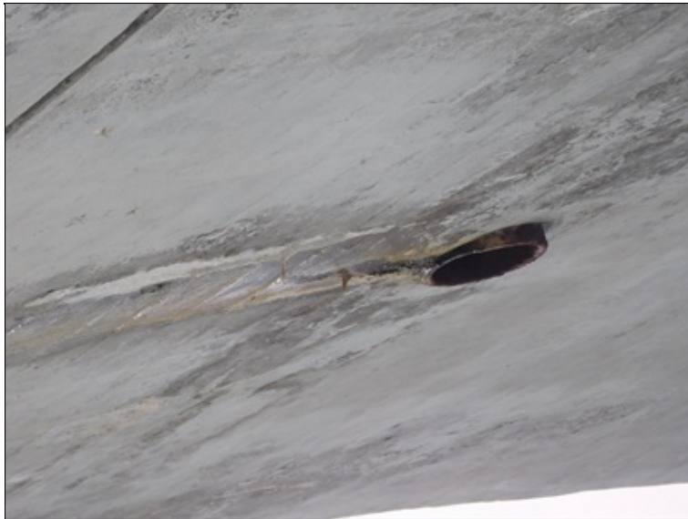
Zatékání a výluhy v okolí odvodňovače na pohledu oblouku v poli 2.
