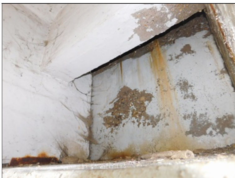
Zatékání na úložný práh, resp. závěrnou zídku na opěře 4.
