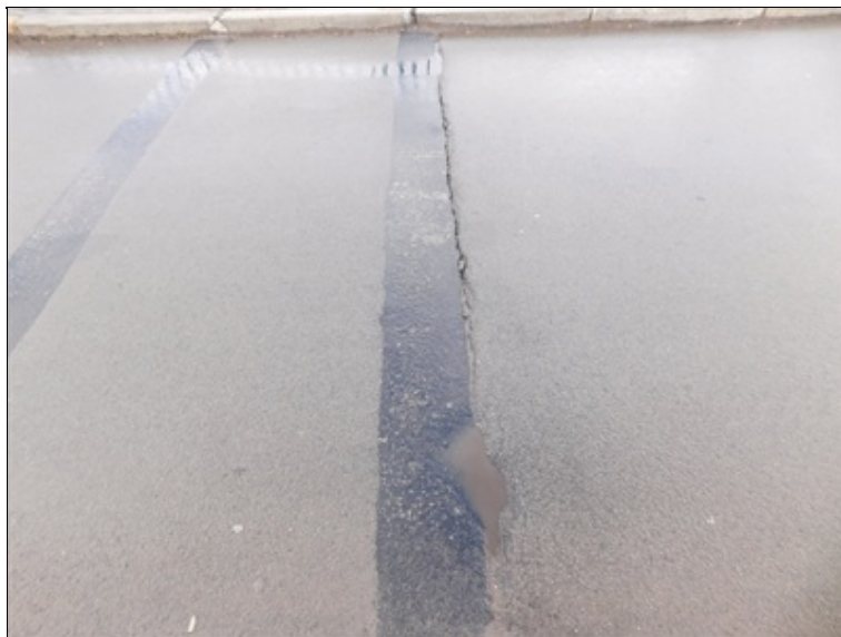
Trhlina v elast. mostním závěru.
