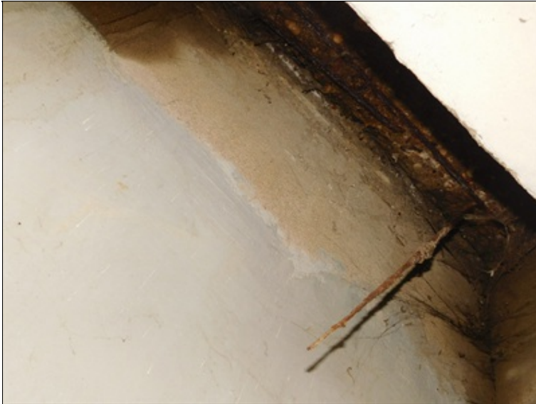
Zatékání dilatační spárou nad opěrou 1.
