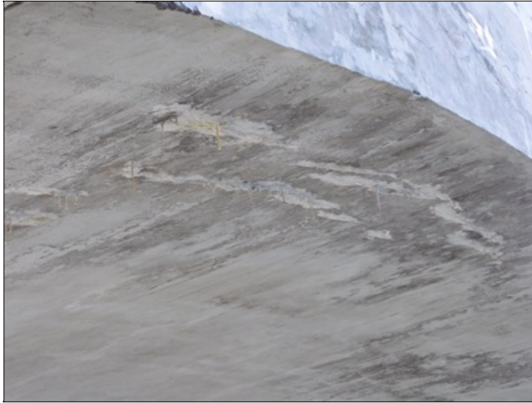
Výluhy na pohledu nosné konstrukce v poli 2.
