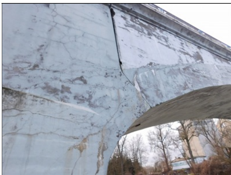
Pohled na uložení oblouku na pilíř 3. Trhliny s výluky na boku nosné konstrukce.
