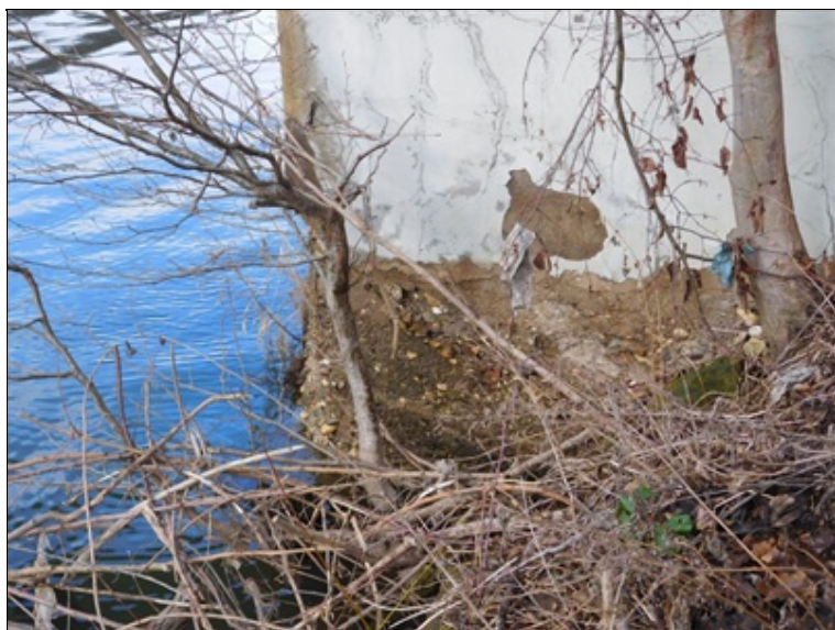
Degradace betonu pilíře 3 v úrovni hladiny vody.
