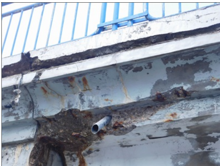
Dtto. Degradace betonu konzoly - koroze odhalené výztuže.
