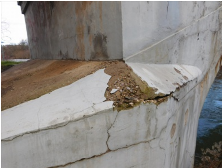
Degradace betonu patky pilíře 2.
