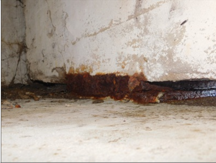
Koroze plechu uložení.
