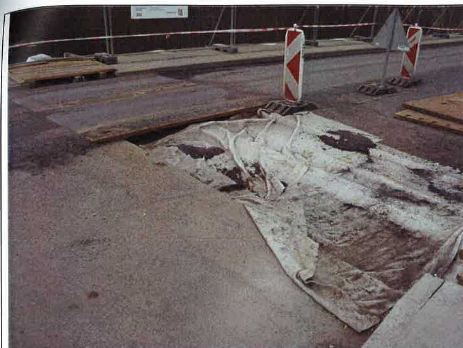
osazený MZ na opěře 1
