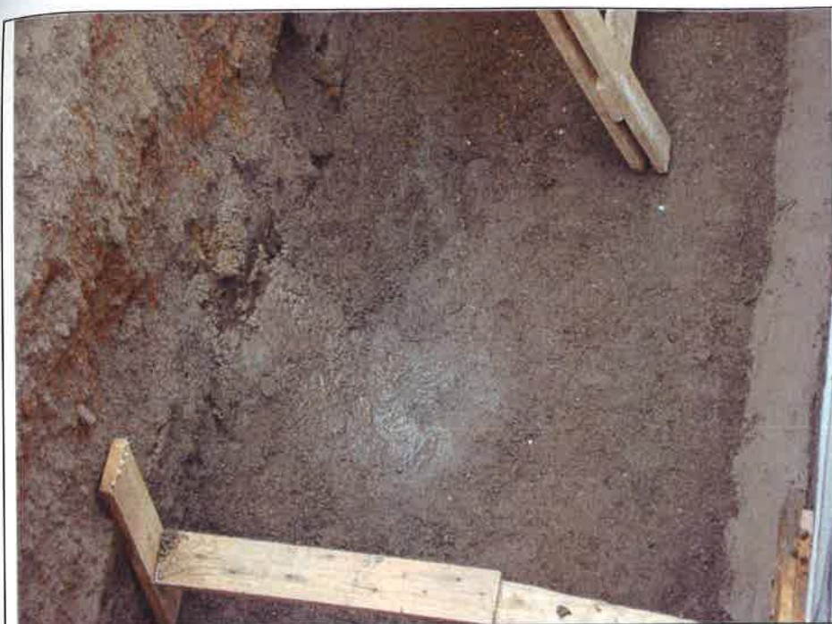
spodní voda prosakující do výkopu za opěrou 2
