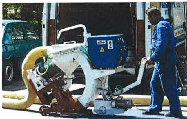
Celkový pohled na otryskávací zařízení
