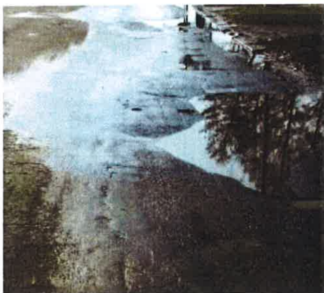
Místní pokles většího rozsahu, ve kterém se drží voda.
