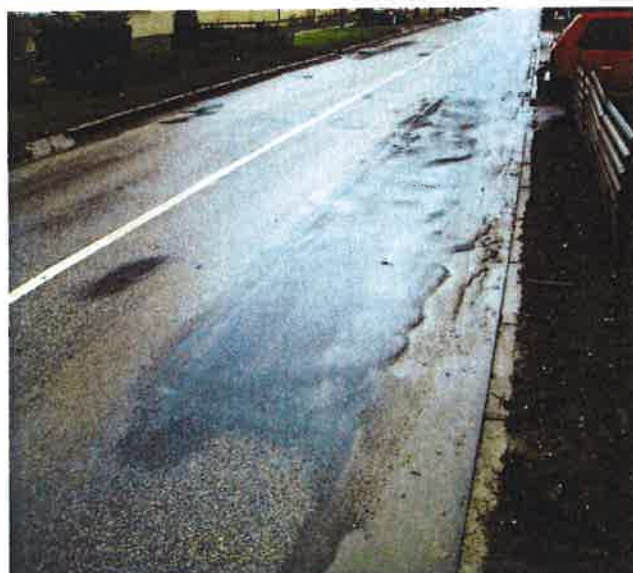
Deformace v jízdní stopě vozidel.
