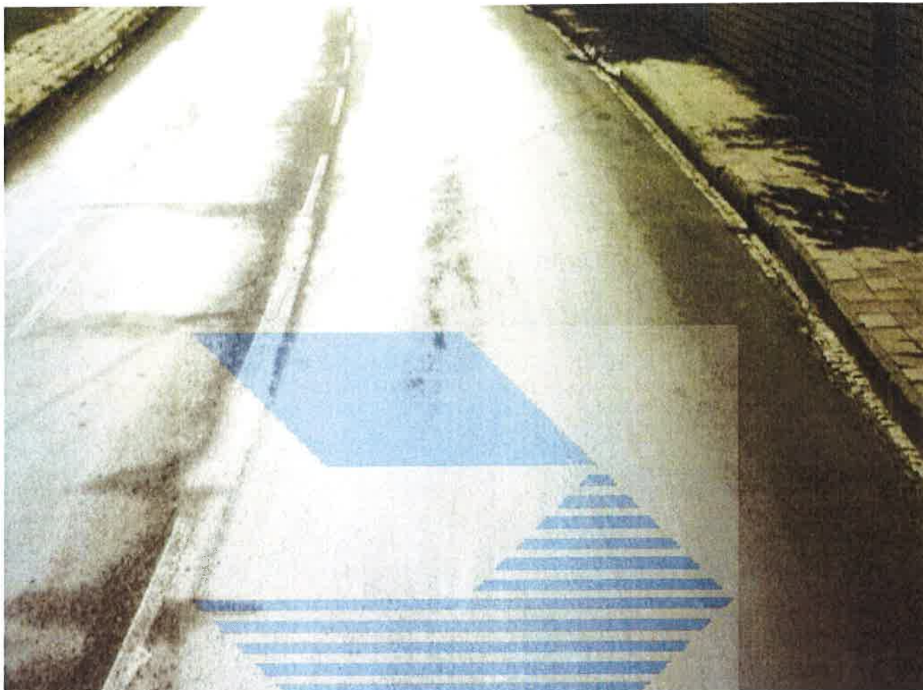
Uzavřený a vyhlazený povrch vozovky způsobený vystoupením asfaltového tmelu.
