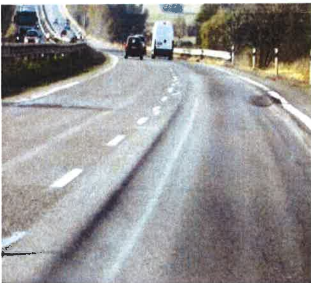
Extrémní výskyt vyjetých kolejí v pravém jízdním pruhu.
