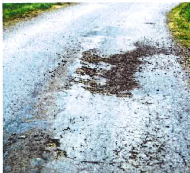
Prolomení uprostřed konstrukce vozovky.
