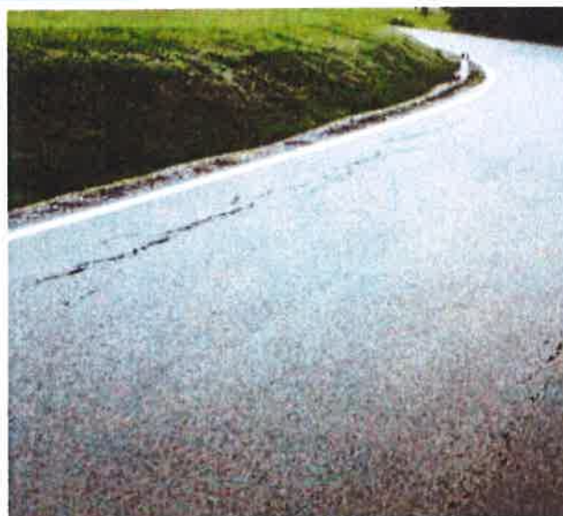
Podélná trhlina v jízdní stopě vozidel.
