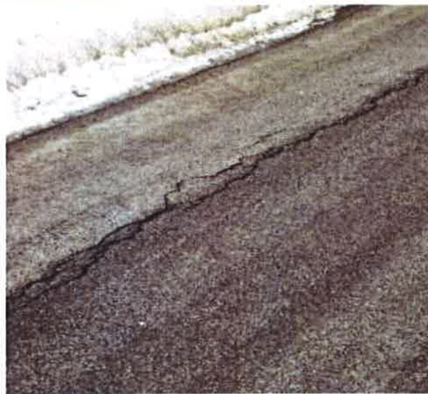
Rozvětvená podélná trhlina způsobená mrazem.
