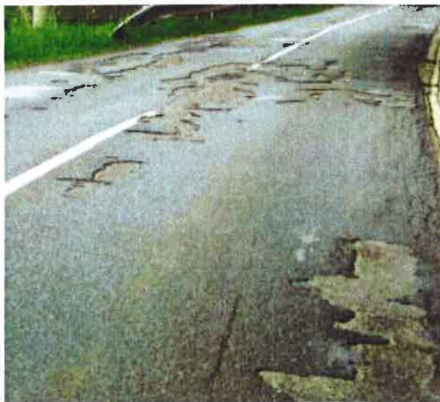
Barevně odlišená místa s oloupanou emulzní kalovou vrstvou.
