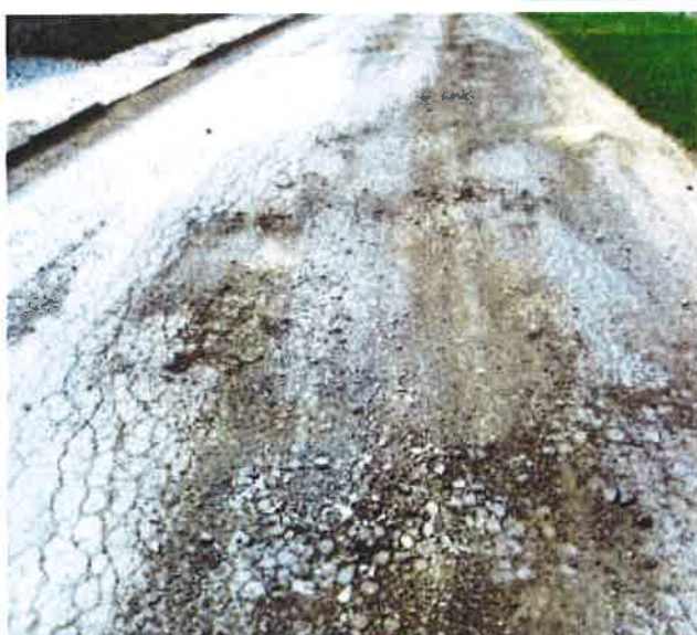
Povrch vozovky je téměř celý tvořen rozbředlým podložím.
