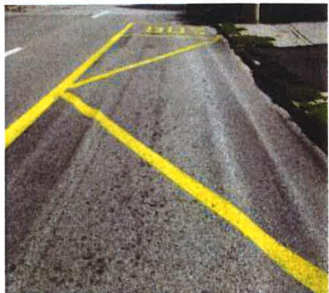
Vyjeté koleje způsobené zastavujícími autobusy na zastávce.
