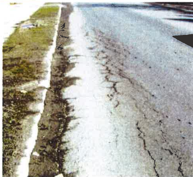
Lokální výskyt síťových trhlín v jízdní stopě vozidel.
