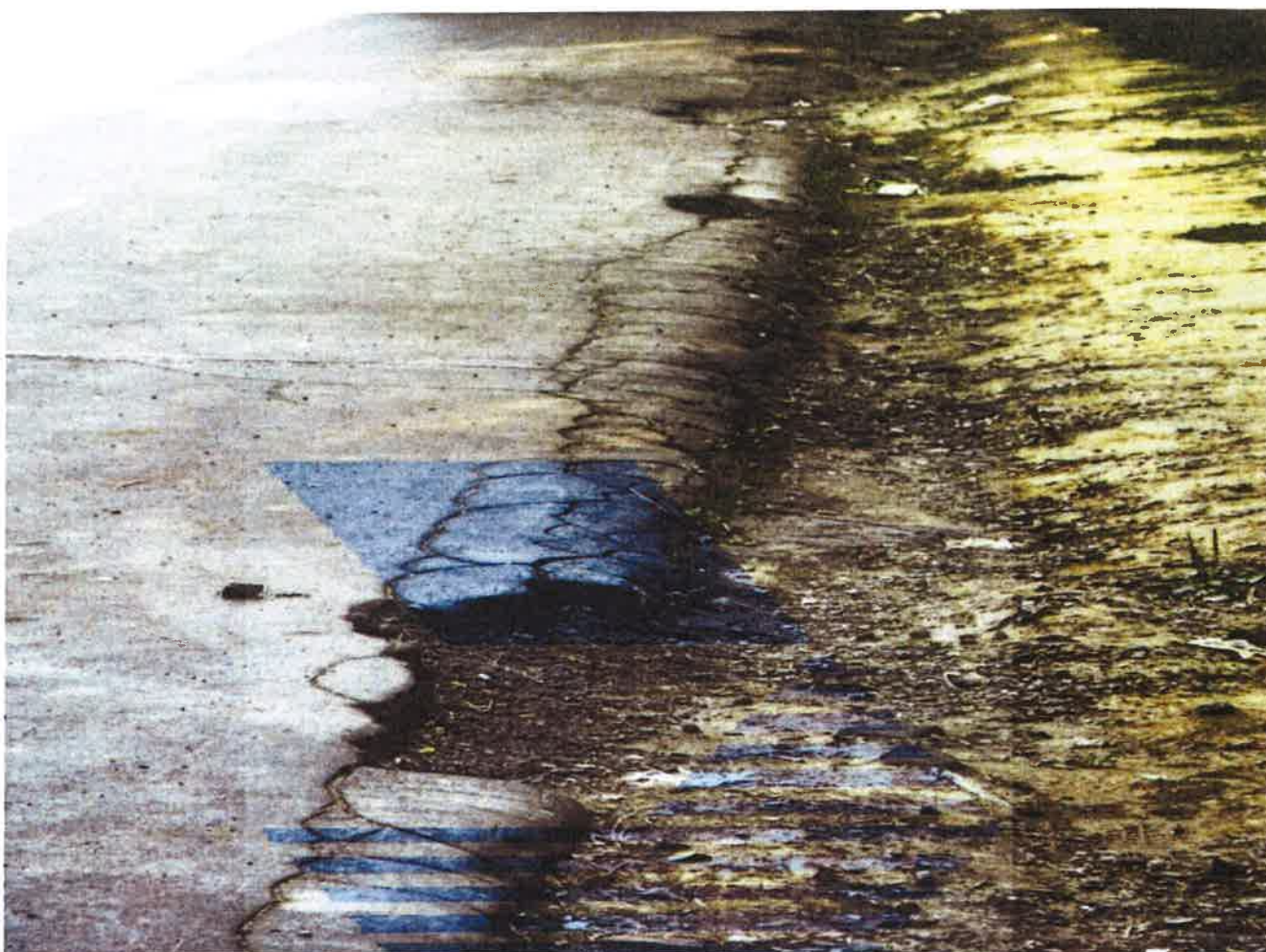
Olamování způsobené podmáčením okraje vozovky.
