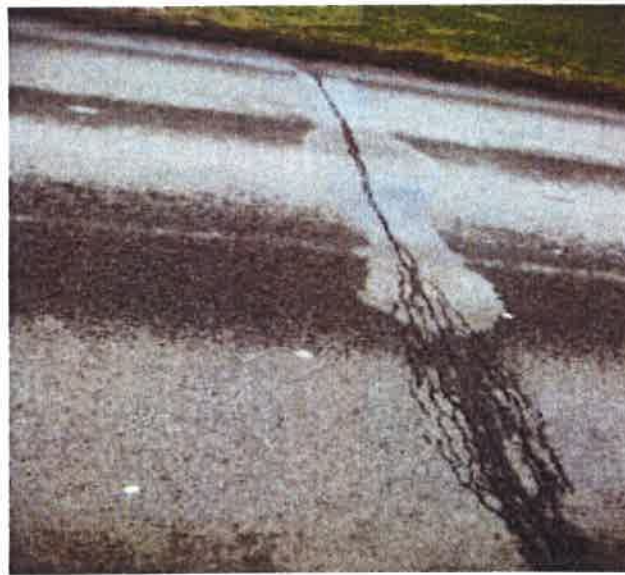
Příčná trhlina s přidruženými trhlinami, které se dále rozšiřují.
