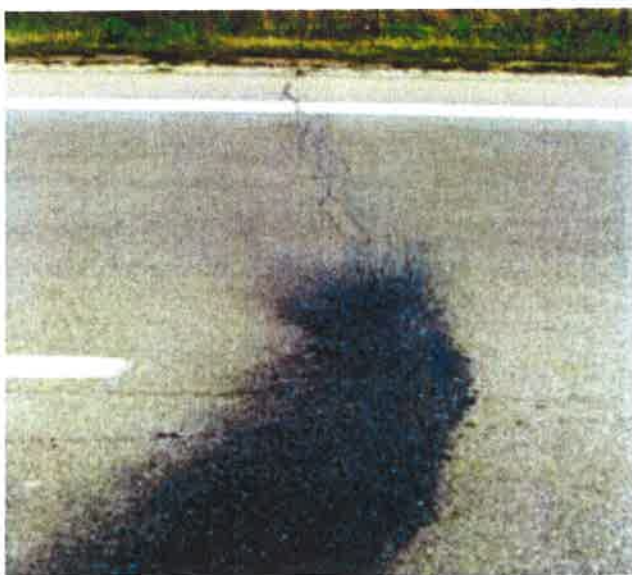
Překrytí rozvětvené příčné trhliny nevhodně použitou tryskovou metodou.
