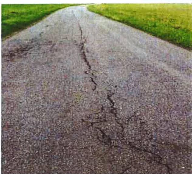
Rozvětvená trhlina na podélné spáře.
