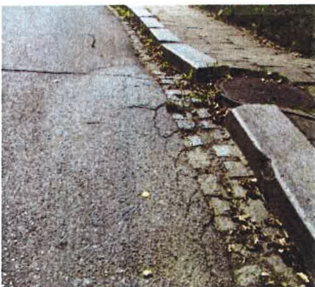
Hrbol u okraje vozovky vzniklý objemovou změnou podkladních vrstev.
