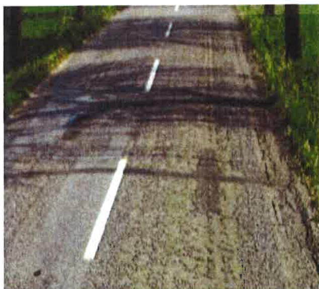
Barevně odlišené místa se ztrátou kameniva z nátěru.
