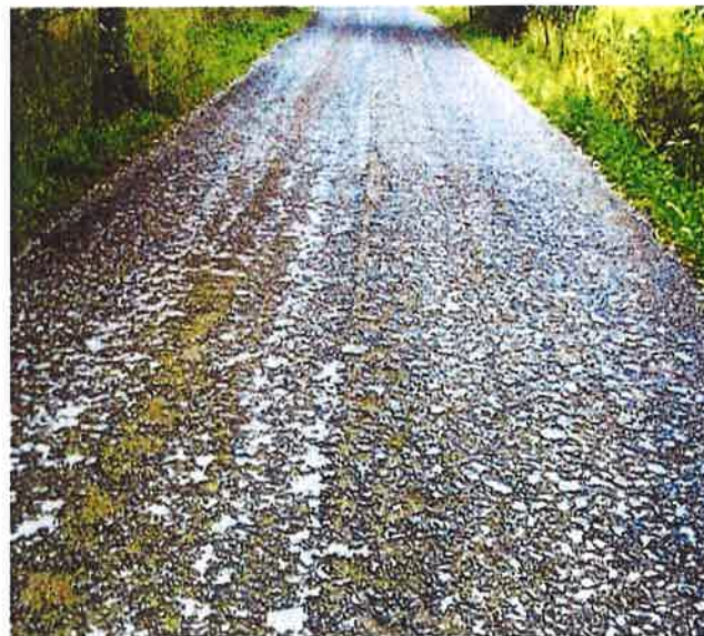
Hlubková koroze téměř přes celou šířku vozovky.
