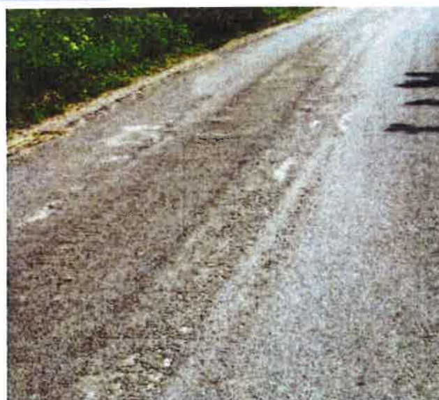
Postupná ztráta kameniva z nátěru.
