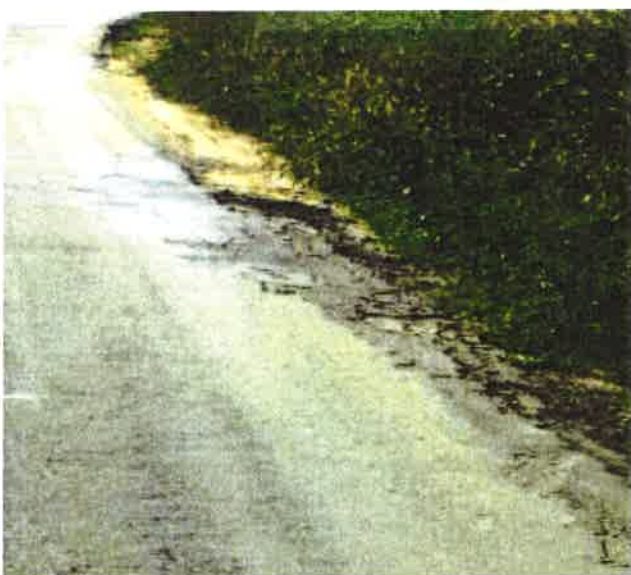
Zanesení příkopu rostlou vegetací způsobuje podmáčení podloží a olamování okraje vozovky.
