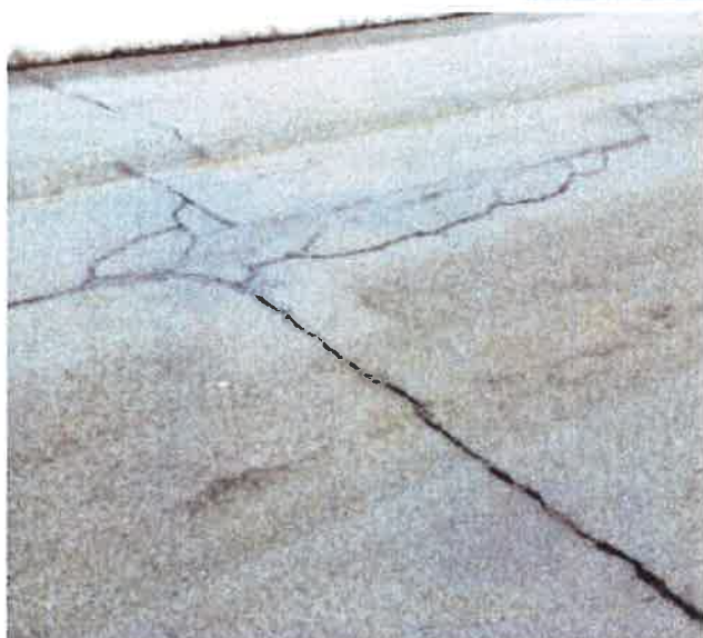
Kombinace široké příčné trhliny s rozvětvenou podélnou.
