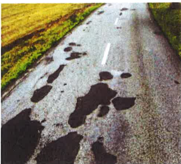
Vysprávký působí jako nerovnosti na vozovce.
