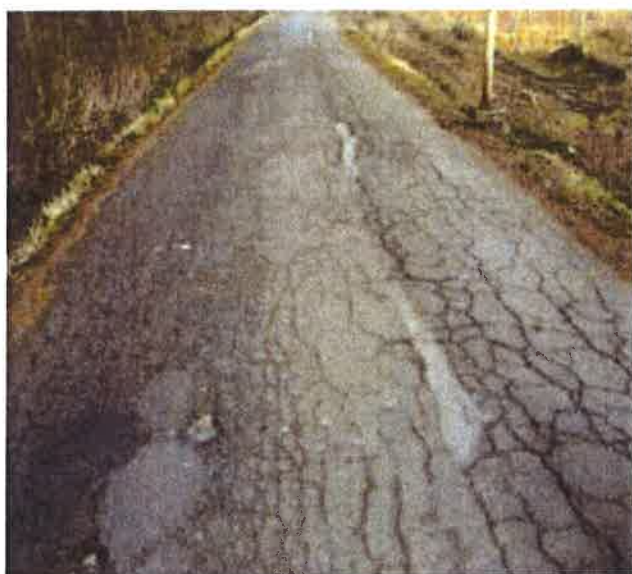
Síťové trhliny s deformací vozovky.
