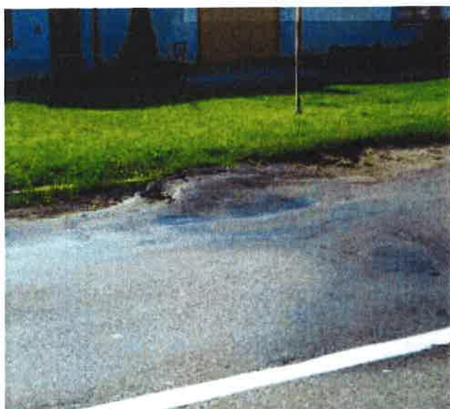
Hrbol vzniklý vytlačení asfaltové směsi mimo vozovku.
