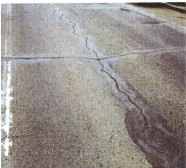
Trhlina široká na podélné spáře v kombinaci s širokou příčnou trhlinou.
