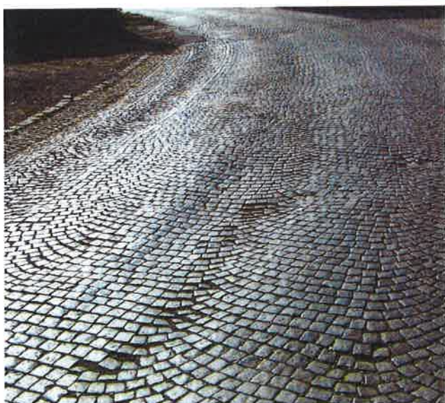
Plošná deformace dlážděné vozovky.
