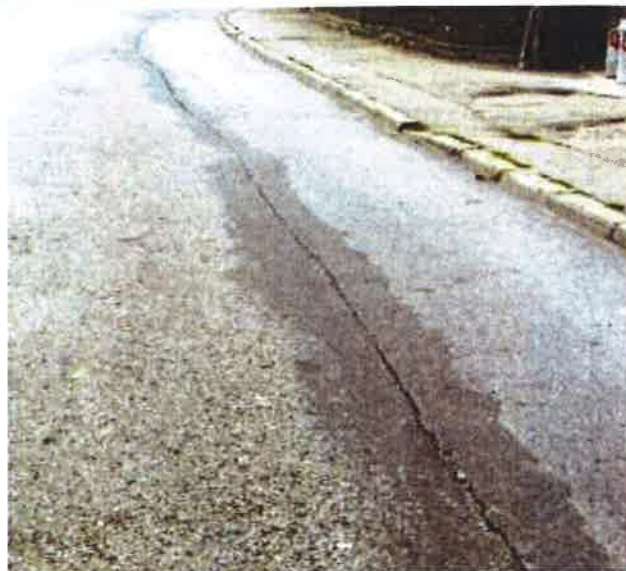
Trhlina na podélné spáře prokopírovaná přes nátěr.
