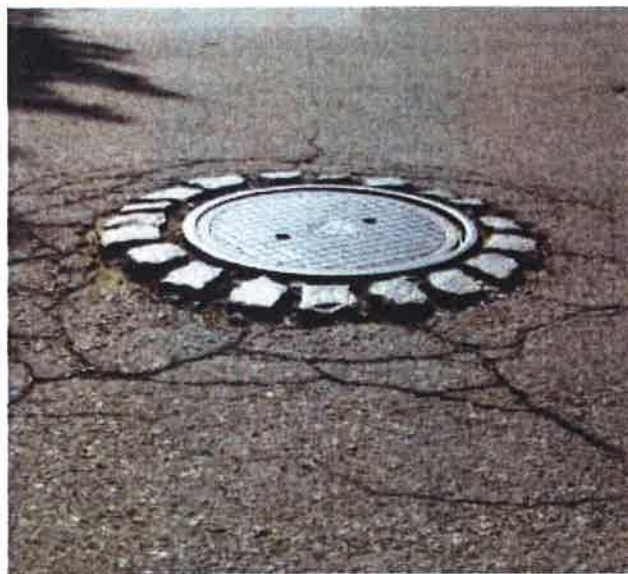
Hrbol se síťovými trhlinami uprostřed vozovky způsobený vyvýšeným kanalizačním poklopem.
