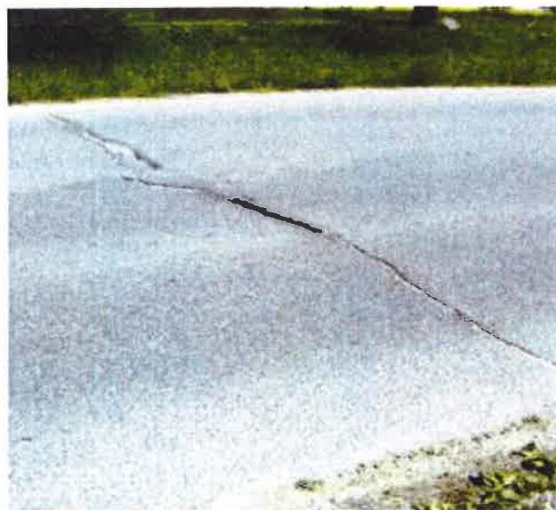
Široká trhlina procházející celou šířkou vozovky.
