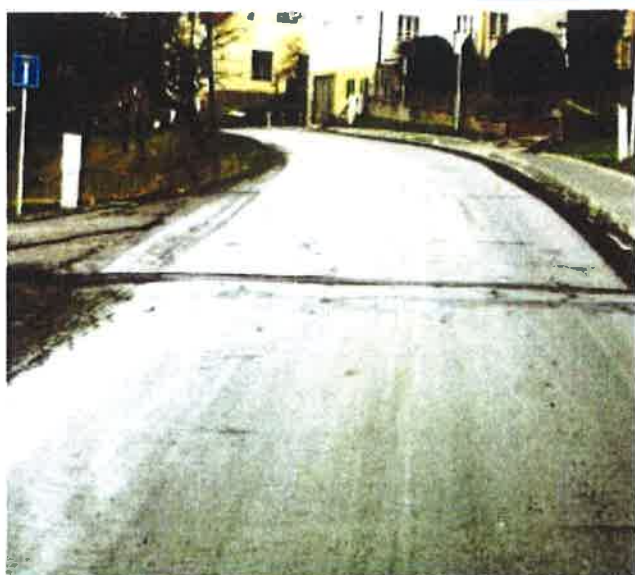
Prohlubeň vzniklá nedostatečným zhuťněním záspy rýhy.
