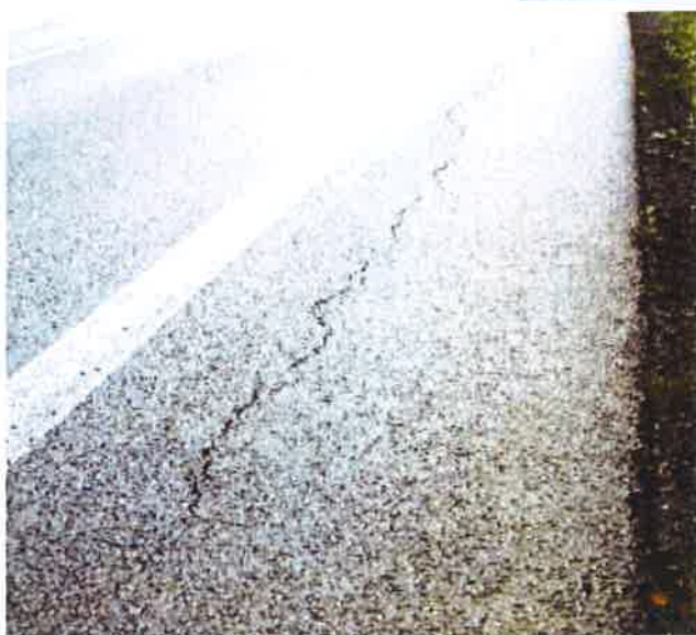
Úzká trhlina u okraje vozovky.
