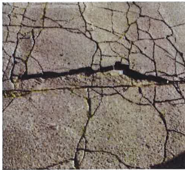
Výtluk vzniklý z mozaikových trhlin.
