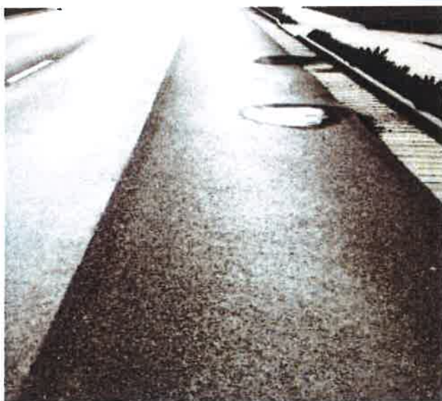
Nekvalitně zhutněná asfaltová směs projevující se zvýšenou mezerovitostí.
