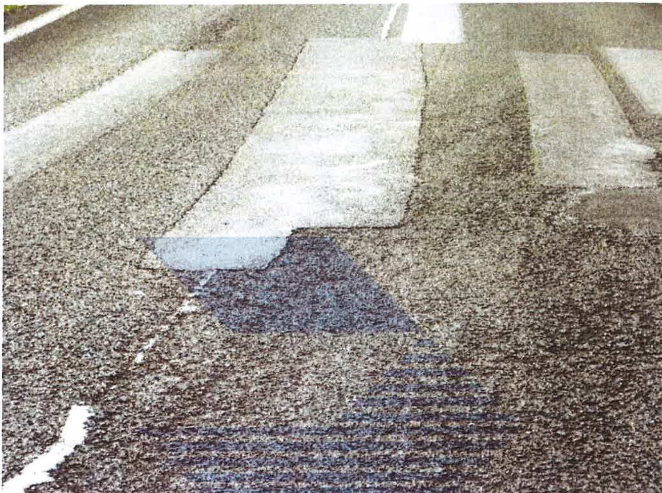
Hlubková koroze v AB krytu.
