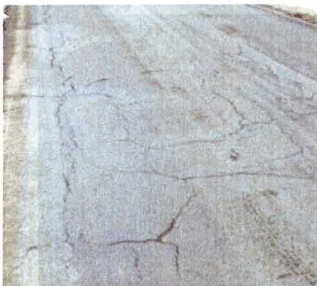
Mozaikové trhliny vzniklé z rozvětvených trhlin.
