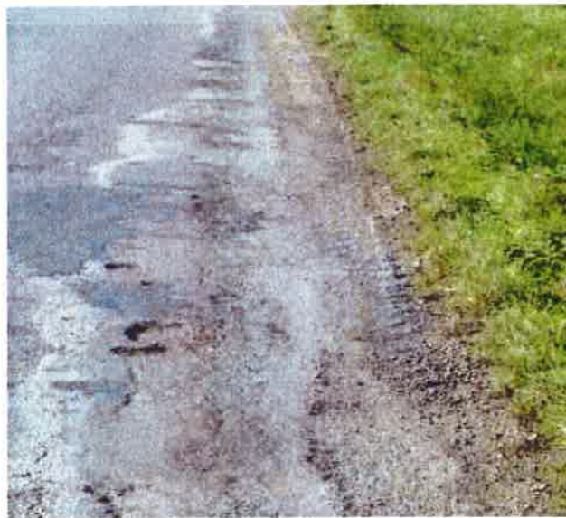
Zvýšená krajnice způsobila podmáčení okraje vozovky a její deformaci.
