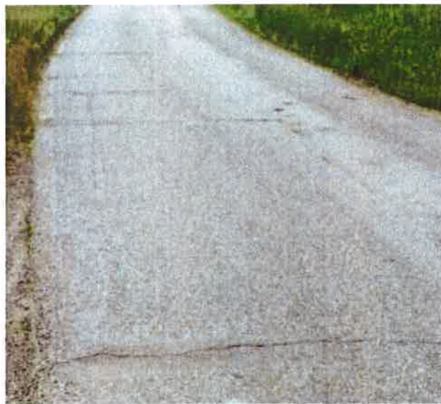
Několik uzkých příčných trhin jdoucích za sebou.
