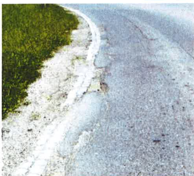
Olamování vozovky při napojení asfaltové vrstvy na přídlažbu s tvorbou výtluků.
