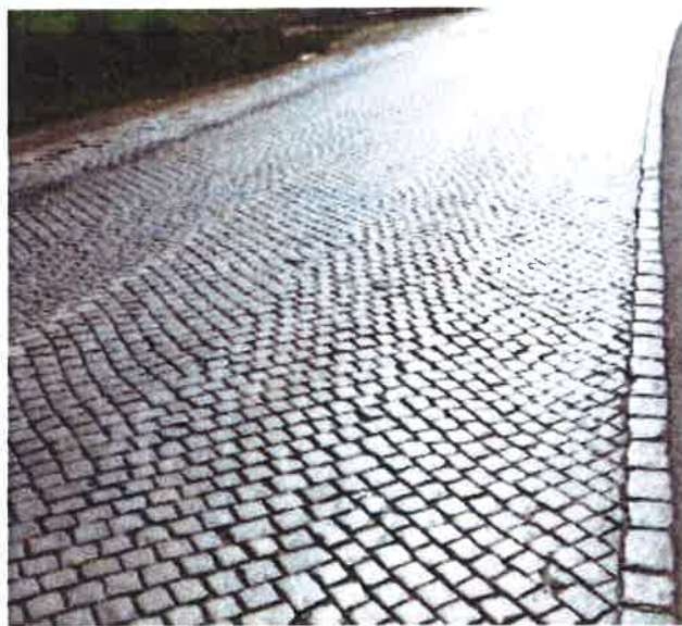
Ztráta mikrotextury na dlážděné vozovce.
