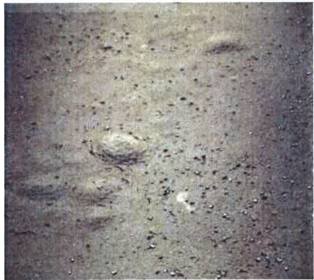
Puchýře v litém asfaltě.
