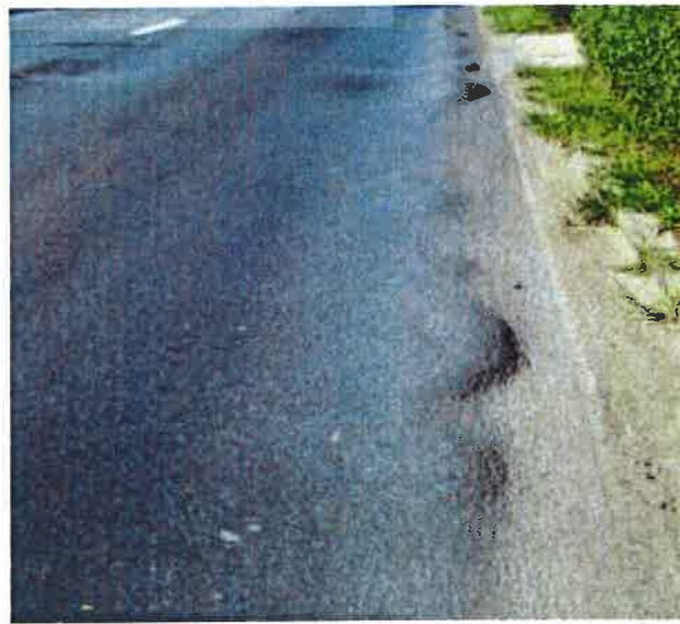
Nepravidelné hrbole vzniklé vytlačení asfaltové směsi z jízdní stopy vozidel.
