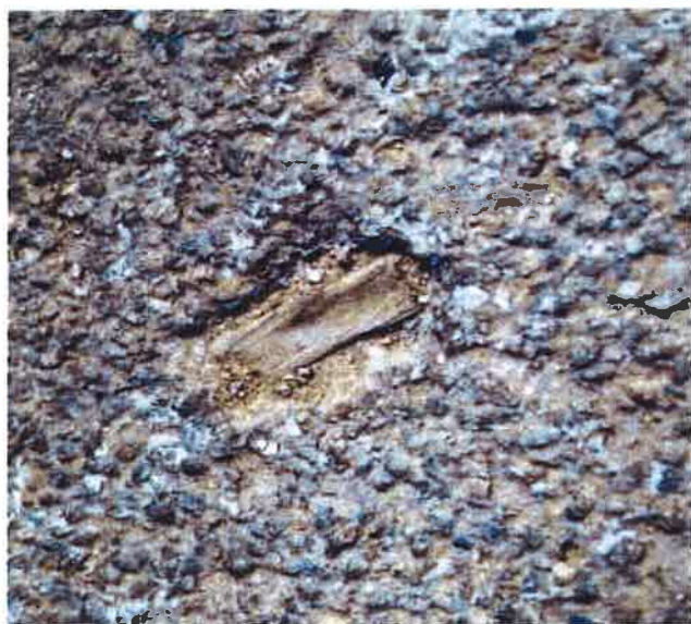
Cizí těleso v asfaltovém krytu způsobující velkou kavernu.
