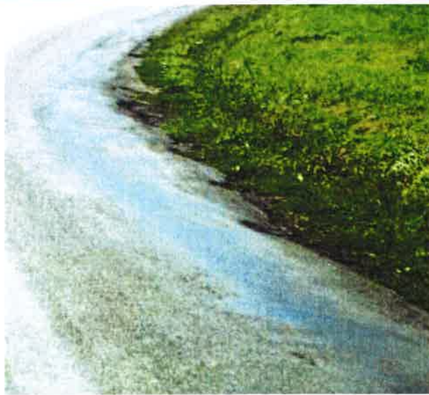
Postupné olamování krajů vozovky způsobené zanesením příkopů.
