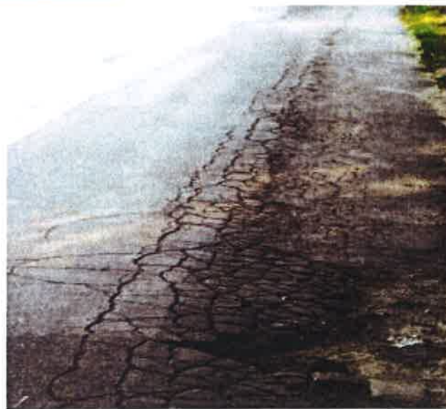
Olamování okraje vozovky a následná tvorba síťových trhlin vlivem špatného odvodnění.
