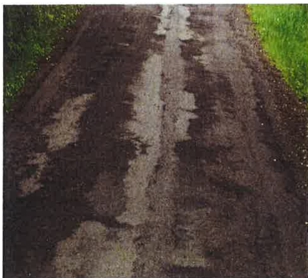
V místech hlubkové koroze se při osychání povrchu vozovky drží vlhkost.
