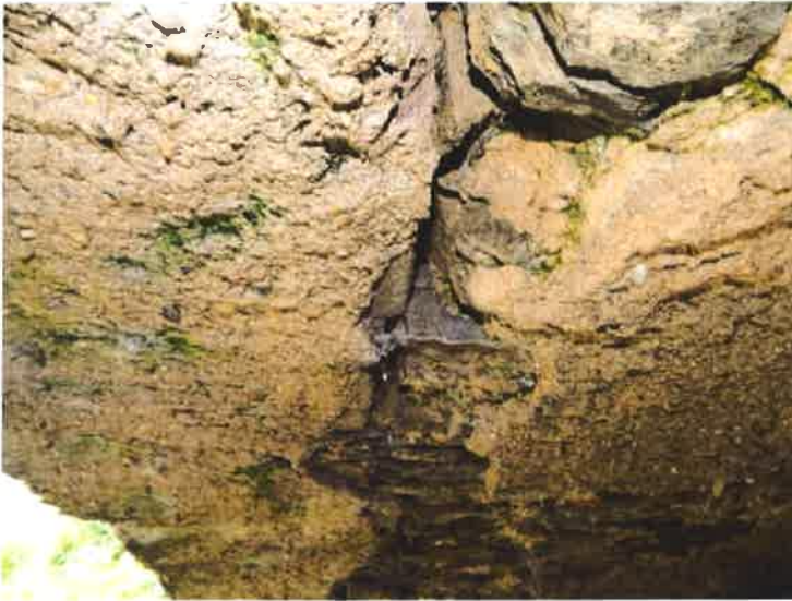
Otevřená trhlina na pravém boku nosné konstrukce.
