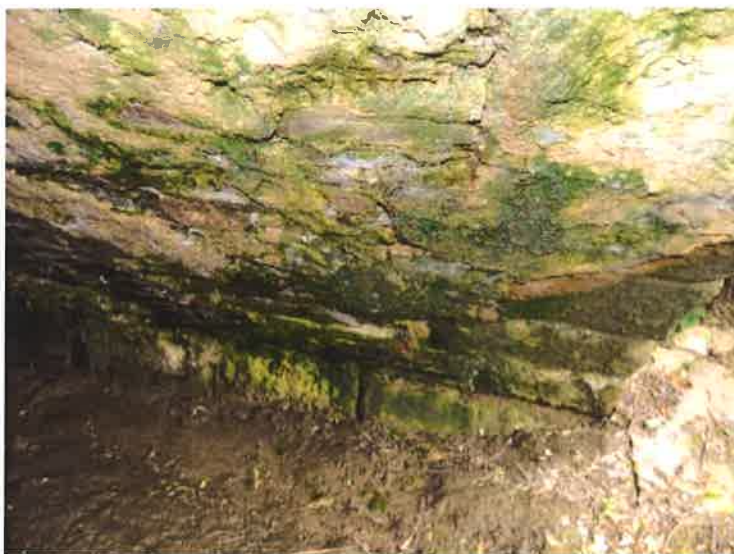
Silné zatékání na pravý bok nosné konstrukce.
