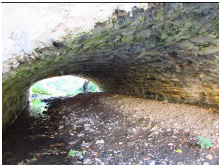
Spodní líc nosné konstrukce, 1. pole. Kamenné zdivo klenby : vypadlá malta, uvolněné kameny, lokálně vypadlé kameny.
