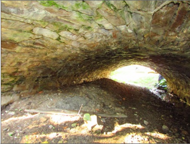
Spodní líc nosné konstrukce, 1. pole. Kamenné zdivo klenby : vypadlá malta, uvolněné kameny, lokálně vypadlé kameny. Pohled na P2
