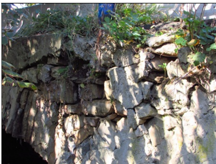
Čelní zídka, 1. pole vpravo : rozpadlé kamenné zdivo
