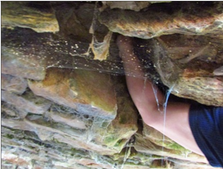
Spodní líc nosné konstrukce, 2. pole, kamenné zdivo klenby : vypadlé kameny, kaverna.
