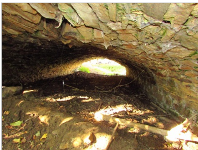
Spodní líc nosné konstrukce, 2. pole. Kamenné zdivo klenby : vypadlá malta, uvolněné kameny, na mnoha místech vypadlé kameny.
