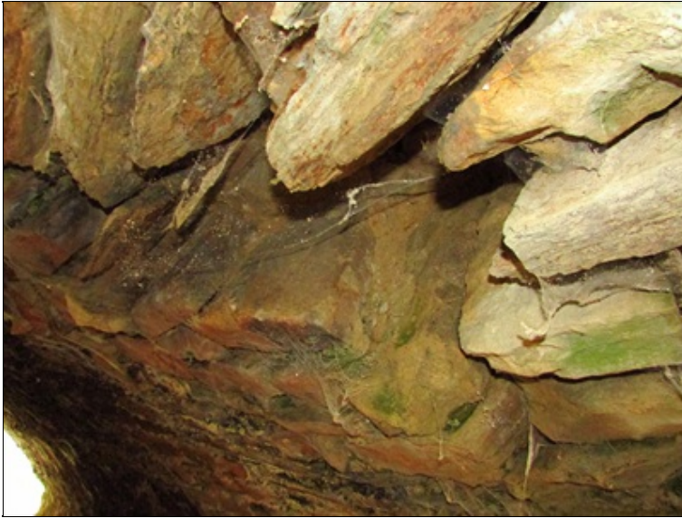
Spodní líc nosné konstrukce, 2. pole, kamenné zdivo klenby : vypadlé kameny, kaverna.
