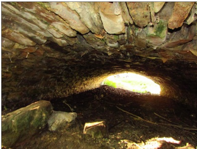
Spodní líc nosné konstrukce, 2. pole. Kamenné zdivo klenby : vypadlá malta, uvolněné kameny, vypadlé kameny. Pohled na OP3.
