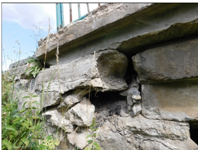
Rozpadlé a vysunutě pravé křídlo OP1
