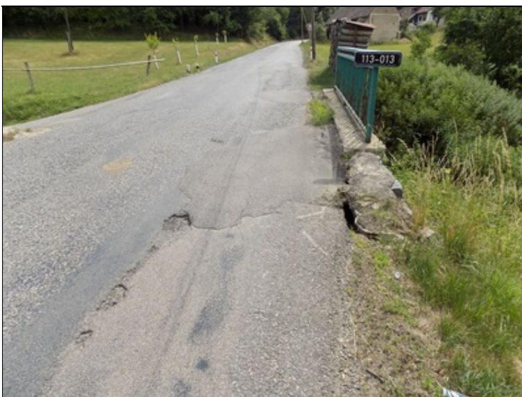
Stav vozovky nad pravým křídlem OP1, kaverna za rubem křídla
