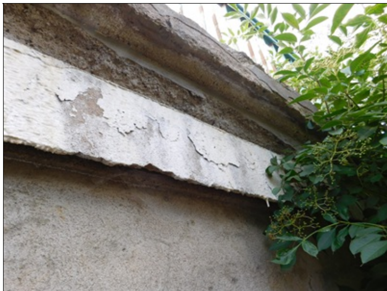
Výluhy na boku levé římsy, rozpad betonu nabetonované části
