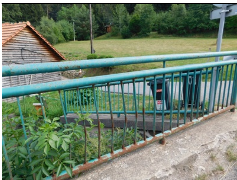
Rozpad římsy, deformace zábradlí
