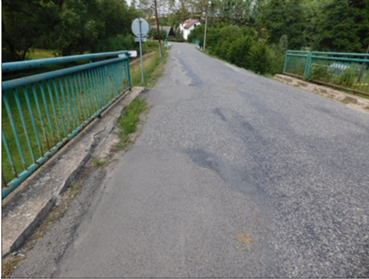
Pravá krajnice, stav vozovky na mostě
