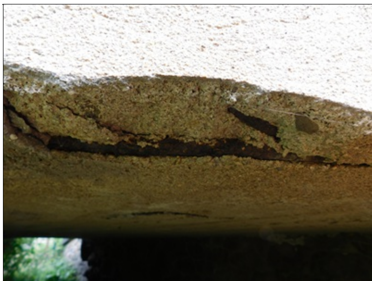
Odpadlý beton a koroze výztuže, pravá strana NK
