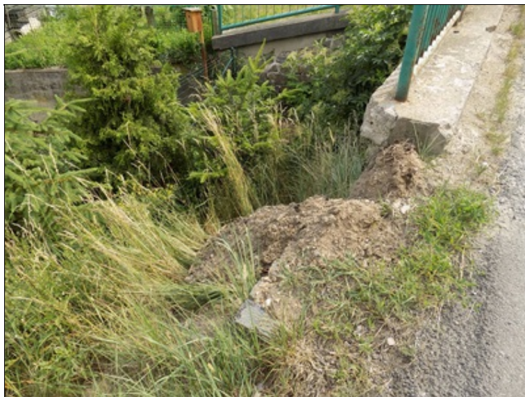
Kypřý zásyp rozpadlého zpevnění krajnice vlevo u OP1
