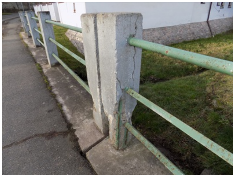
Závady betonového sloupku na pravé straně mostu
