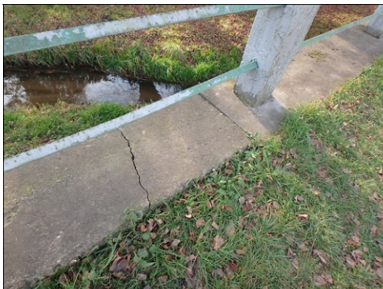
Trhlina v levé římse
