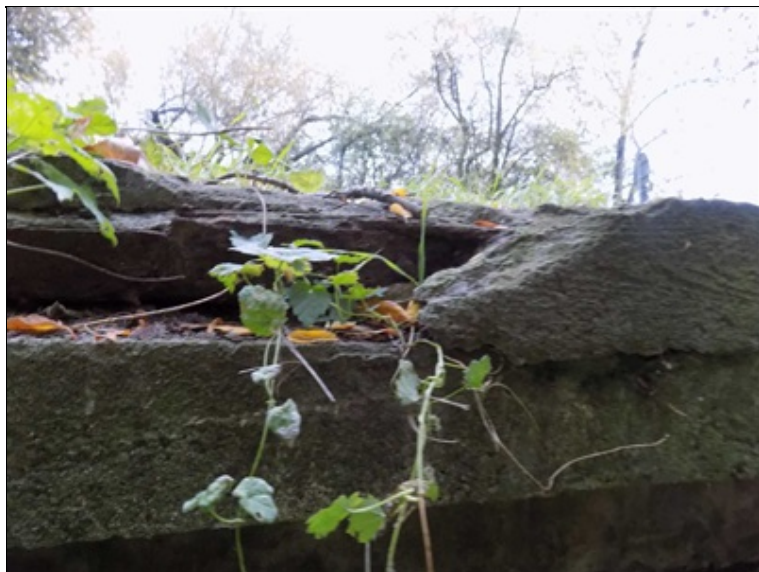
Pravá římsa - odpadlé kusy betonu.
