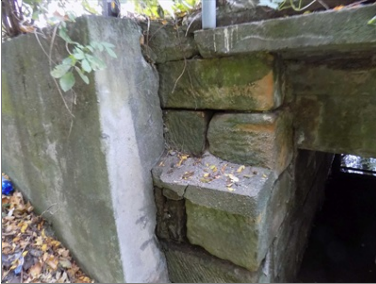
OP1 vpravo - chybí spárování -> rozvolněné zdivo.
