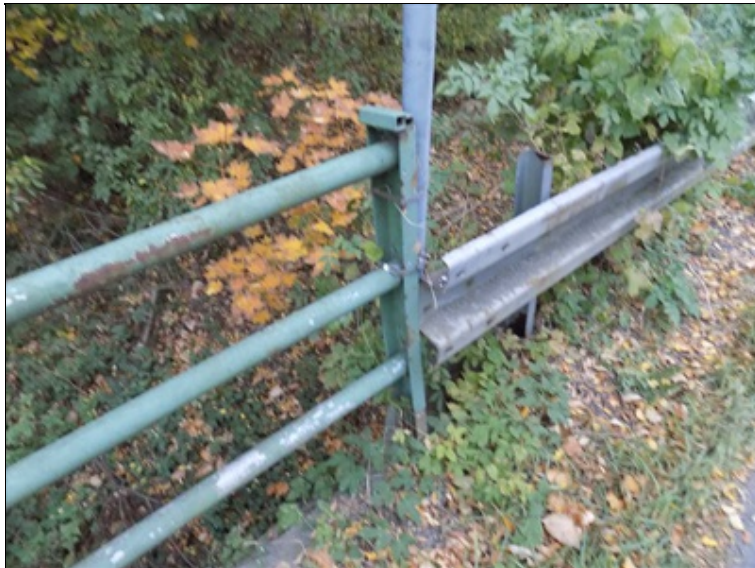
Nenormový přechod svodidla na zábradlí na mostě.
