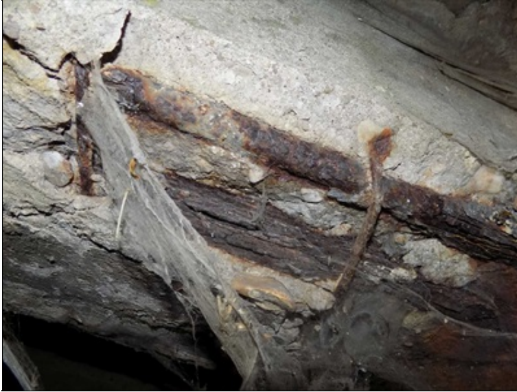
Odhalená výztuž levého trámu.
