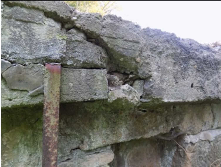
Římsa nad OP1 vlevo - trhlina, rozpad.
