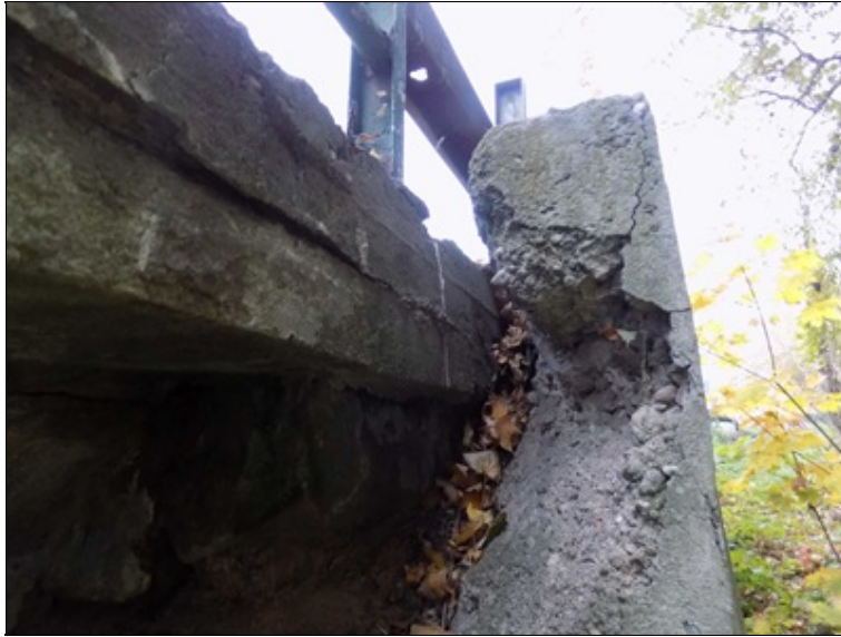
Přibetonávka křídla OP2 vlevo - rozpad.
