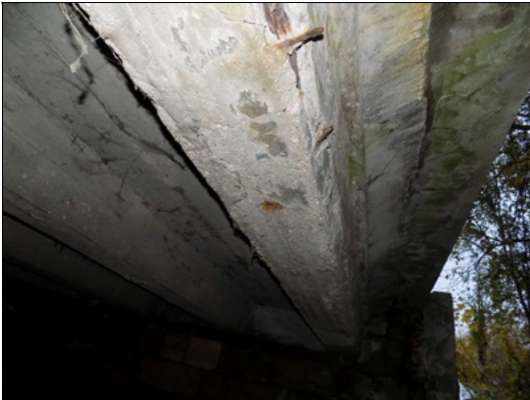
Pravý trám - koroze výztuže.
