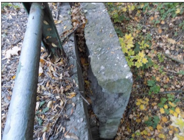
Přibetonávka křídla OP2 vlevo - rozpad.
