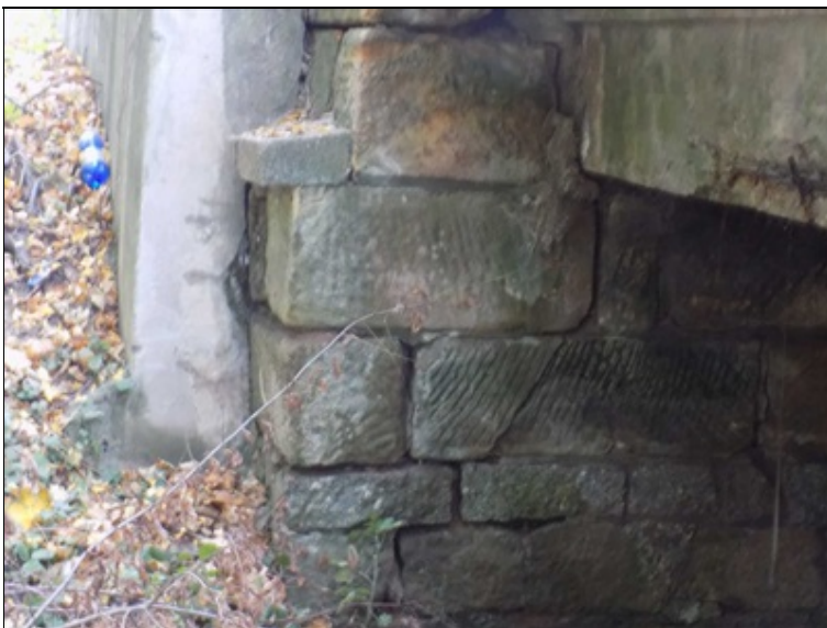
OP1 vpravo - trhlina -> rozvolněné zdivo.
