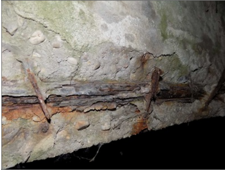
Odhalená výztuž pravého trámu.
