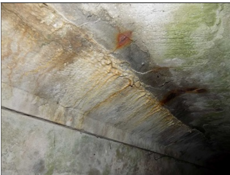
Výluhy na pravém trámu.
