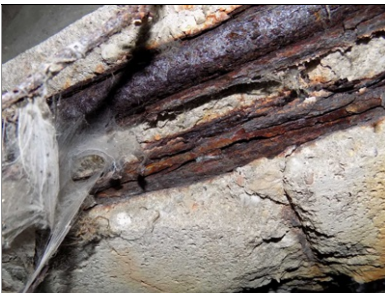
Odhalená výztuž levého trámu.
