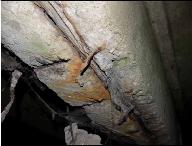
Odhalená výztuž levého trámu.
