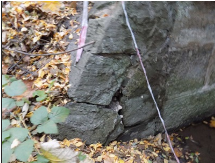
OP2 vlevo vydrolené spárování do hloubky až 200 mm
