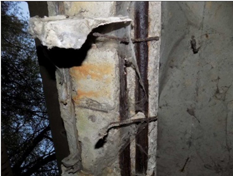
Odhalená výztuž levého trámu.
