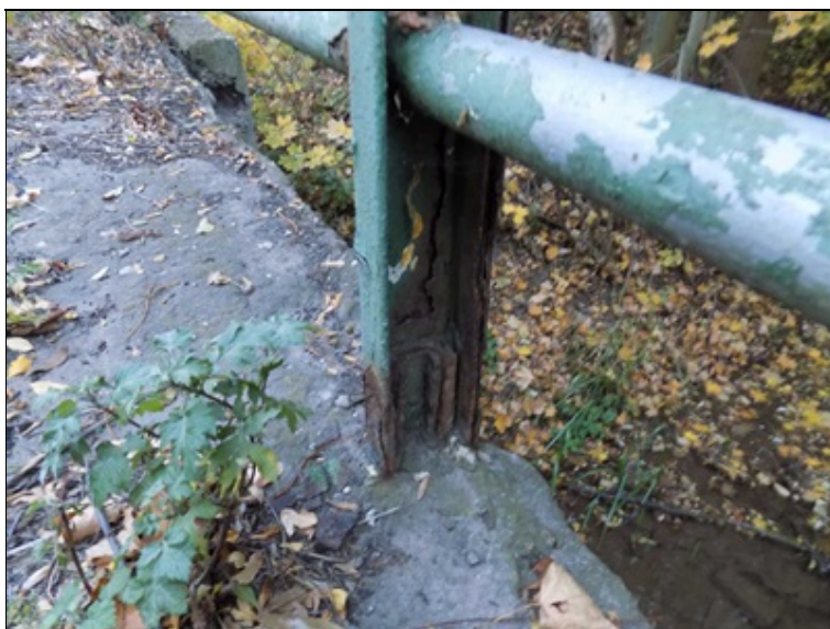
Vrstevnatá koroze zábradlí.
