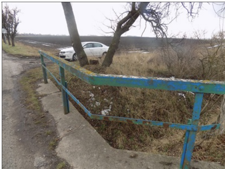
Levé zábradlí na mostě. Protikorozní ochrana je na konci životnosti, zábradlí koroduje, na horním madlu uchycené lišejníky.
