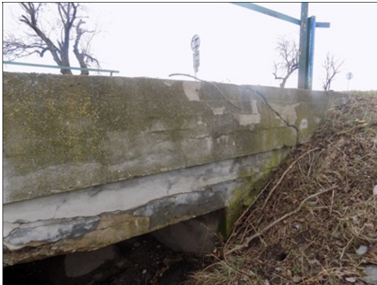
Trhlina v levé římse nad opěrou OP1.
