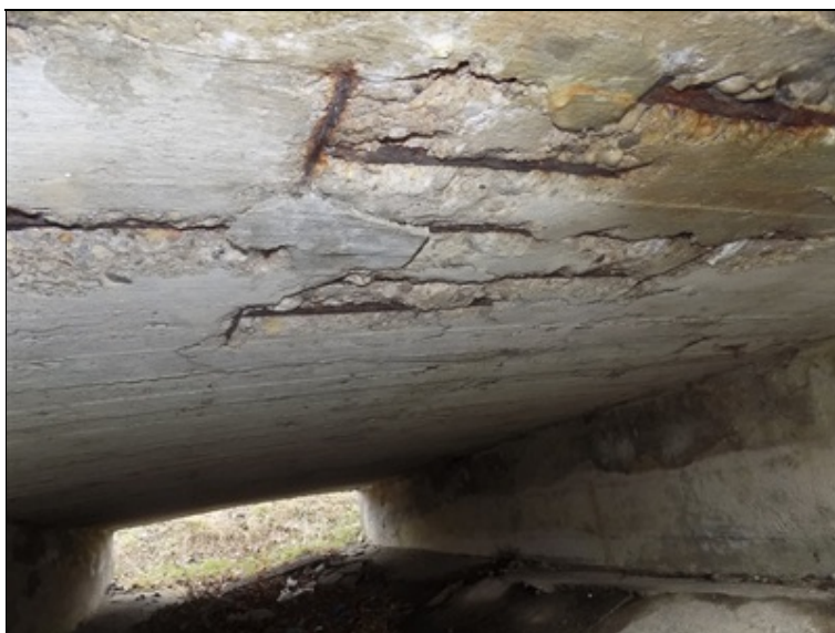
Odpadlé krytí vlivem korodující výztuže na dolním líci levé části železobetonové desky.
