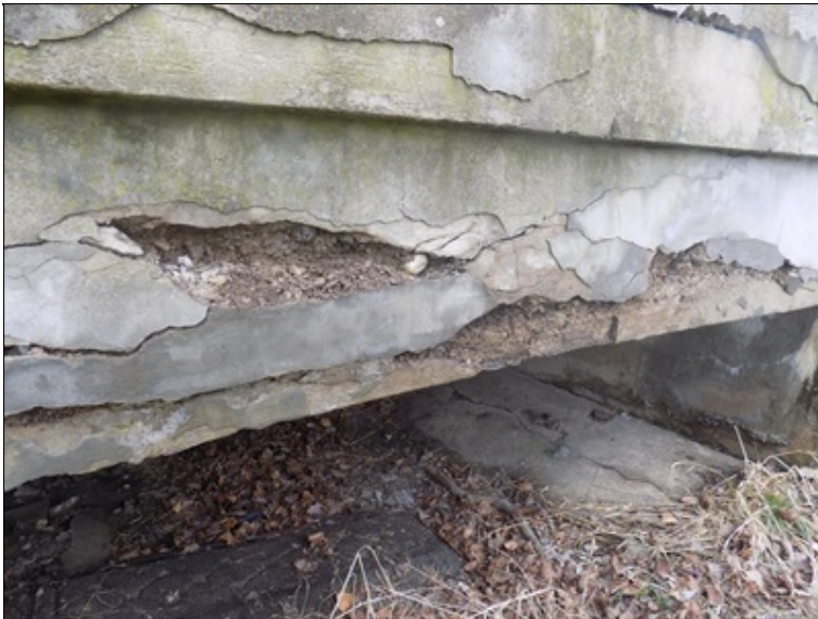
Rozpad pravé hrany nosné konstrukce.
