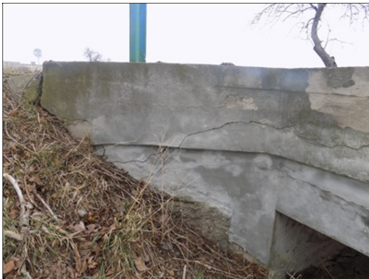
Trhlina v levé římse nad opěrou OP2. Trhlina pokračuje až do křídla mostu.
