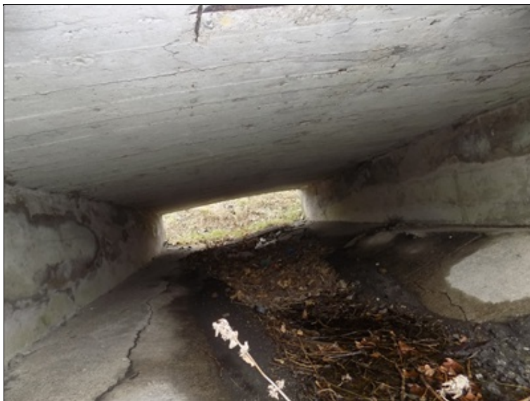
Pohled do mostního otvoru z levé strany. Viditelné stopy po zatékání na obou opěrách, široké trhliny v betonu opevnění dna.
