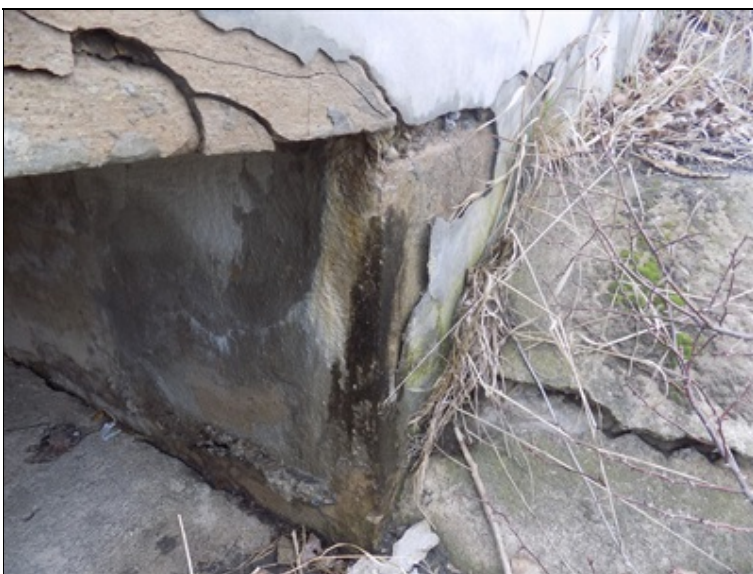
Zatékání v místě uložení desky nosné konstrukce na pravou část opěry OP2.
