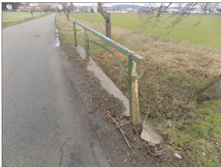
Pohled na pravé zábradlí na mostě. Sloupky a dolní madlo jsou značně deformované.
