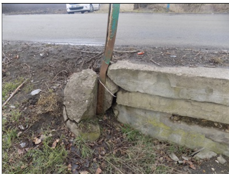
Detail krajního sloupku pravého zábradlí. Beton v okolí sloupku je rozpadlý, zábradlí nemá zádržnou funkci.
