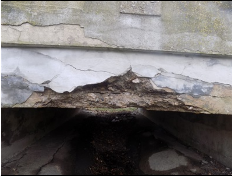
Rozpad levé hrany nosné konstrukce.
