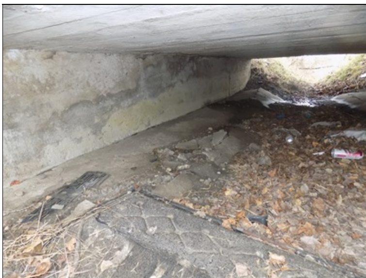
Rozpad vybetonování dna mostu u opěry OP1.
