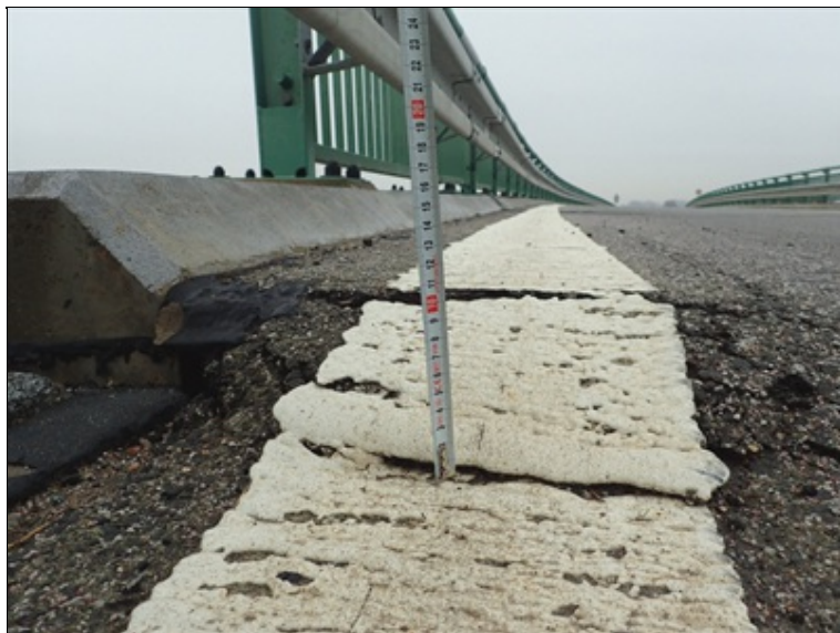
Předpolí O1, detail cca 9 cm propadu vozovky u konce L křídla.
