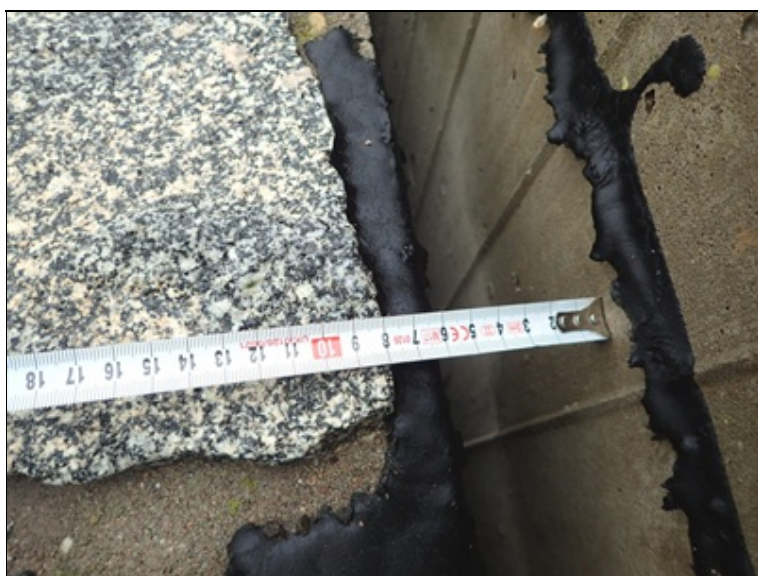
Detail z výše uvedené foto, římsa + dlažba na konci L křídla O1, šířka volné mezery cca 65 mm.
