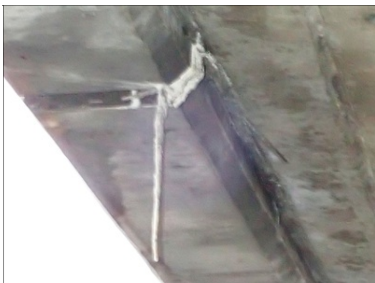
Pole 4, smršťovací spára na podhledu okapního nosu P římsové.
