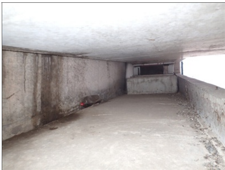
Opěra O1, zatéká na závěrnou zeď, úložný práh, kotevní čelo NK.
