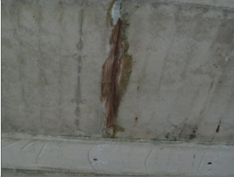
1. pole : v příčné spáře mezi díly nosníku I-73 je zbytek překližky
