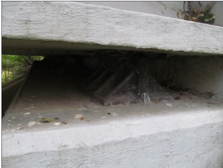
Ložisko na OP1
