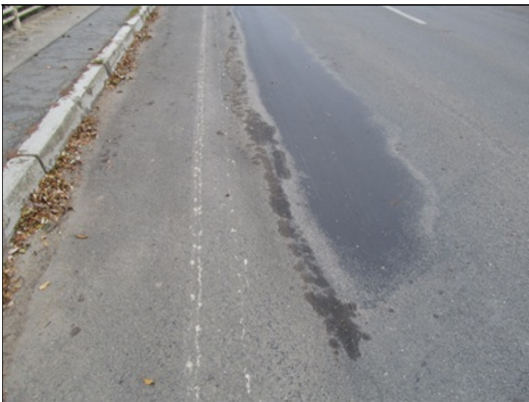
Povrch vozovky : vyjeté koleje
