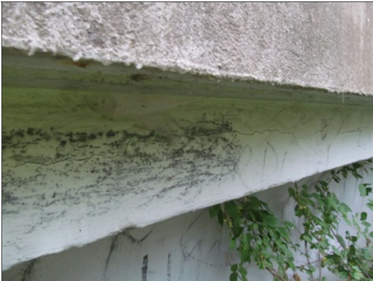
Nosníky IS-73 nad OP1: trhliny v sanační omítce
