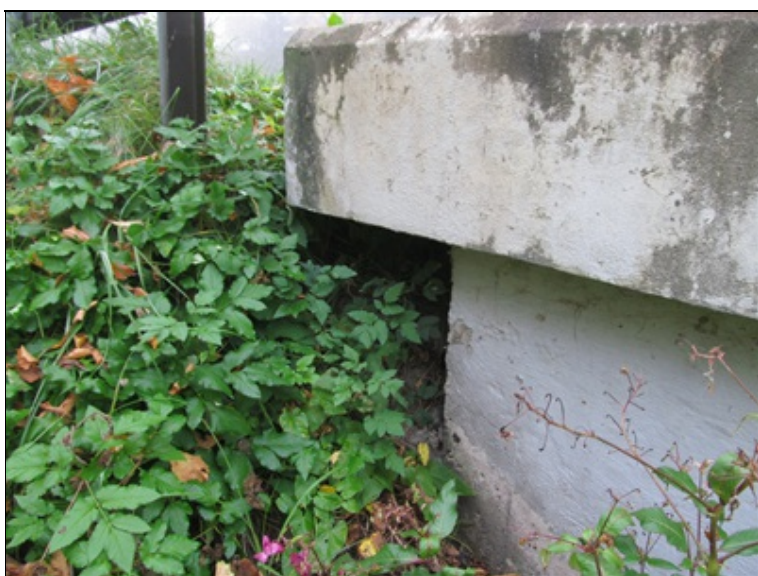
Levé křídlo OP4, pod římsou je kaverna
