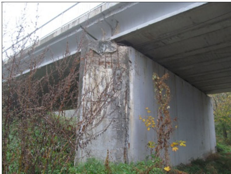
P3 vlevo : hloubková degradace betonu
