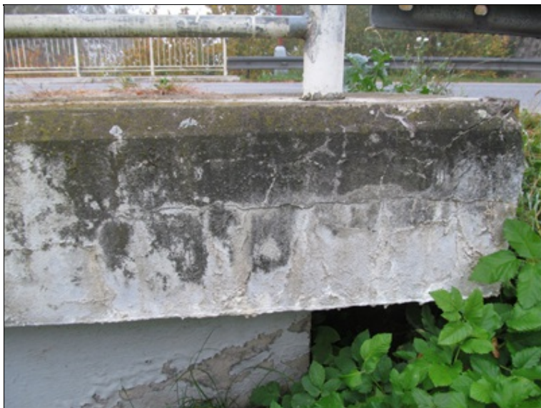
Římsa nad OP4 : sanační omítka je separovaná, trhliny, prosakování vody s výluhy pojiva
