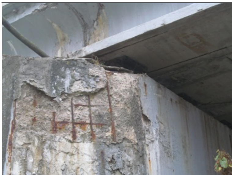
P3 vlevo : hloubková degradace betonu. Ocelolitinnové ložiště je osazeno na kraji rozpadlého betonu, hrozí porušení betonu pod ložiskem, pokles ložiska.
