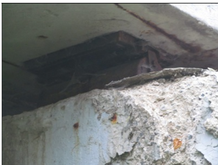
P3 vlevo : hloubková degradace betonu
