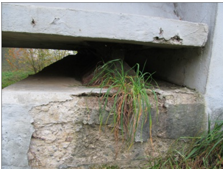
OP4 : hloubková degradace betonu
