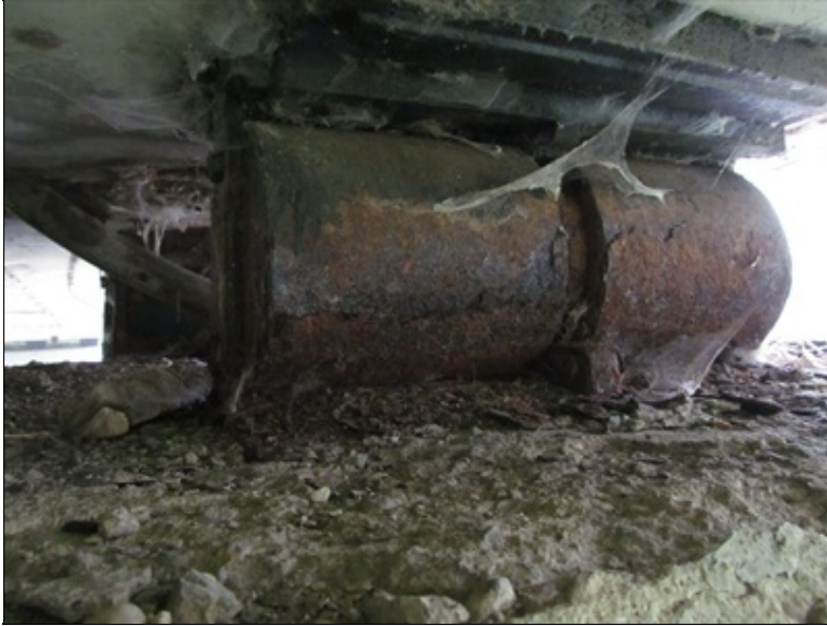
Ložiska na P3 vrstevnatě korodují
