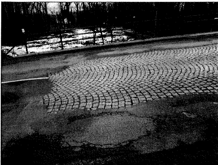
příčný pohled nad O8, výtluky v krytu vozovky
