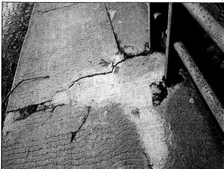
trhliny v betonu chodníku
