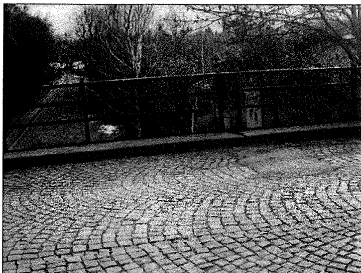
totální koroze zábrany i zábradlí na pravé straně
