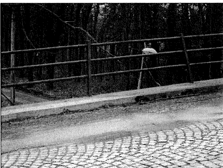
deformace pravého zábradlí, rozpad betonu římsy
