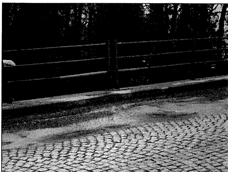
totální koroze zábradlí
