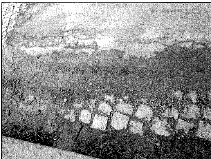
deformace krytu vozovky
