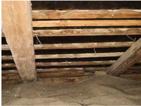
A22. Pohled na střešní plášť z podkroví. Na mnoha místech jsou viditelné stopy po zatékání šablonami patrně při větrem hnaném dešti.
