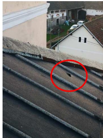
A12. V průběhu prohlídky střechy byly zjištěny lokální perforace v hliníkové krytině, kterými rovněž dochází k zatékání do konstrukce střechy a podkroví.
