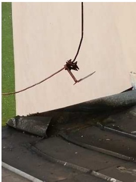
A23. Pohled na poškozený stávající hromosvod.
