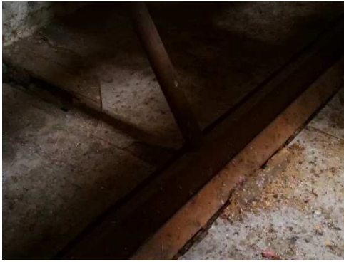
A21. Viz předchozí komentář. Při prohlídce bylo rovněž zjištěno, že některé části krovu byly opravovány v minulosti, viz tato ocelová vzpěra. Dokumentace k těmto opravám, jakož i k objektu nebyla v době vypracování této zprávy k dispozici. Pouze pro informaci. Není zahrnuto do souhrnného seznamu nálezů.
