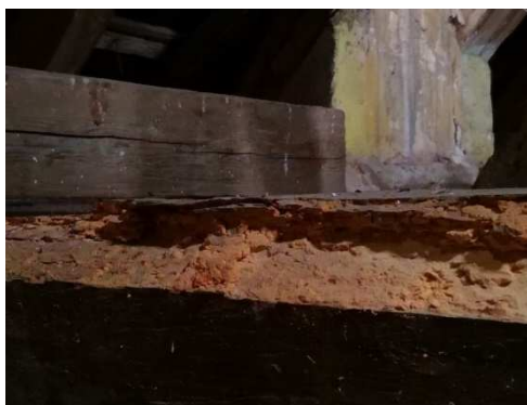
A20. Některé dřevěné konstrukce krovu jsou napadené dřevokaznými houbami a škůdci v důsledku dlouhodobého zatékání do střešní konstrukce. Tato vada způsobuje zmenšování průřezu a snižuje únosnost dotčených částí krovové konstrukce.
