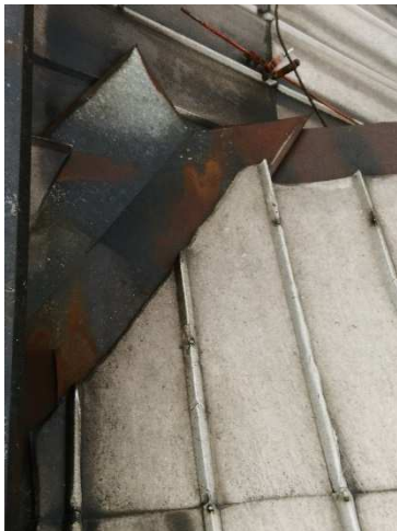
A11. Pohled na neodborně provedený detail úbočí střechy vikýře v návaznosti na mansardovou střechu.
