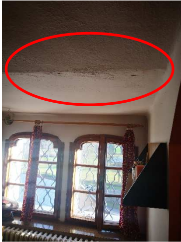
A1. Pohled na střední vikýř v obytné části budovy (podkroví) na jižní fasádě. Jedná se o kancelář personálu. V průběhu prohlídky byly zjištěny stopy po lokálním zatékání úbočím střechy vikýře do interiéru. Dochází též k úkapům vody na podlahu. Dle sdělení personálu tento stav trvá přibližně 4 roky.
