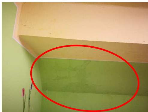
A3. Pohled na boční vikýř v obytné části budovy (podkroví) na západní fasádě. Jedná se o pokoj pacientek. V průběhu prohlídky byly zjištěny stopy po lokálním zatékání úbočím střechy vikýře do interiéru. Dochází též k úkapům vody na podlahu. Dle sdělení personálu tento stav trvá přibližně 4 roky.
