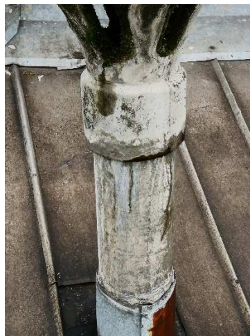
A18. Pohled na detail průniku odvětrávacího potrubí střešní rovinou, který nepovažujeme za zcela těsný.
