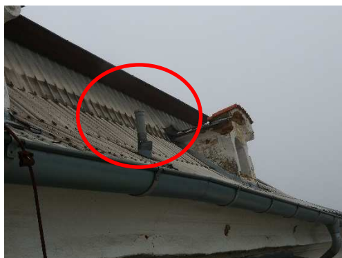
A19. Absence hlavic na odvětrávacím potrubí.
