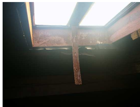
A4. Výlezy na střechu. Výplně z drátkoskel jsou poškozené a vyžadují výměnu.
