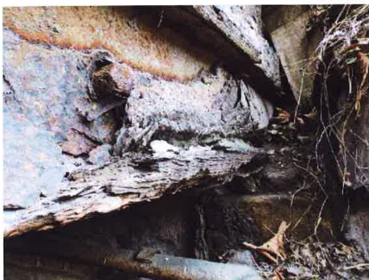
Detail koroze krajního nosníku na levé straně mostu. Nosník je potřeba provizorně podepřít.
