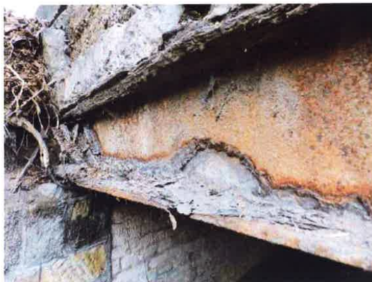
Silná koroze krajního nosníku na levé straně mostu.
