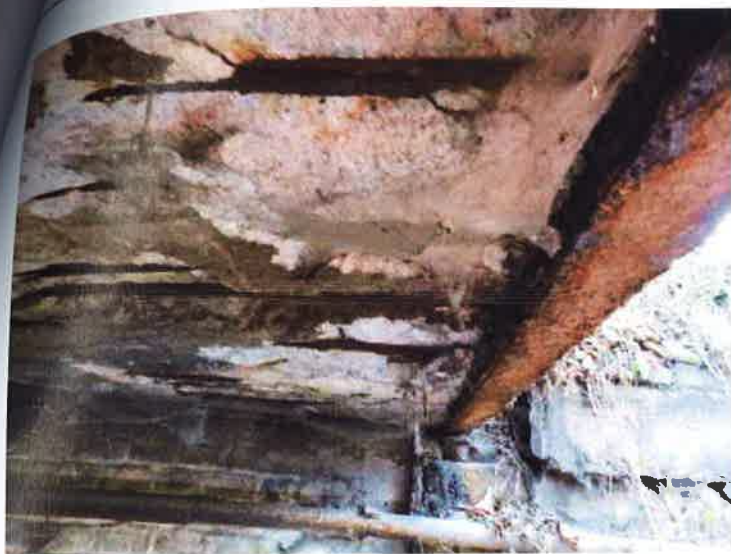
Pohled na spodní líc na levém kraji mostu. Degradace betonu, koroze odhalené výztuže.
