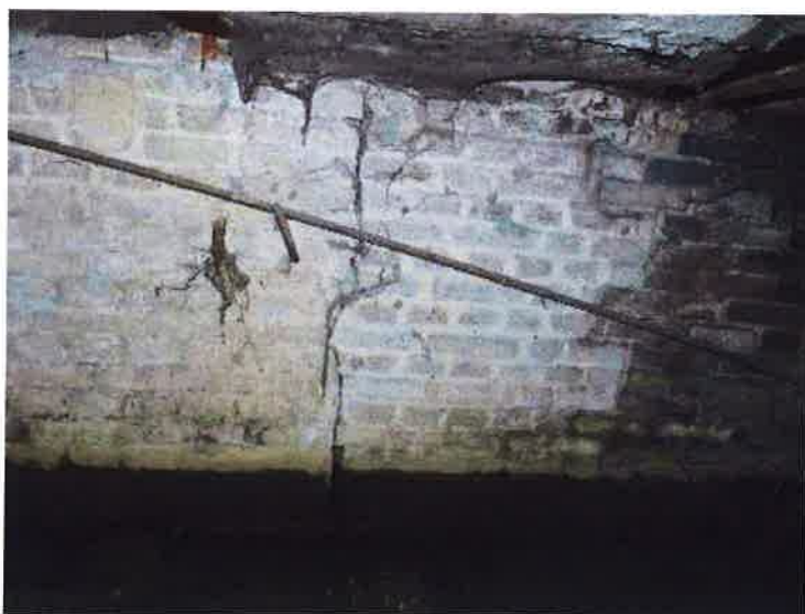
Svislá trhlina v OP2.
