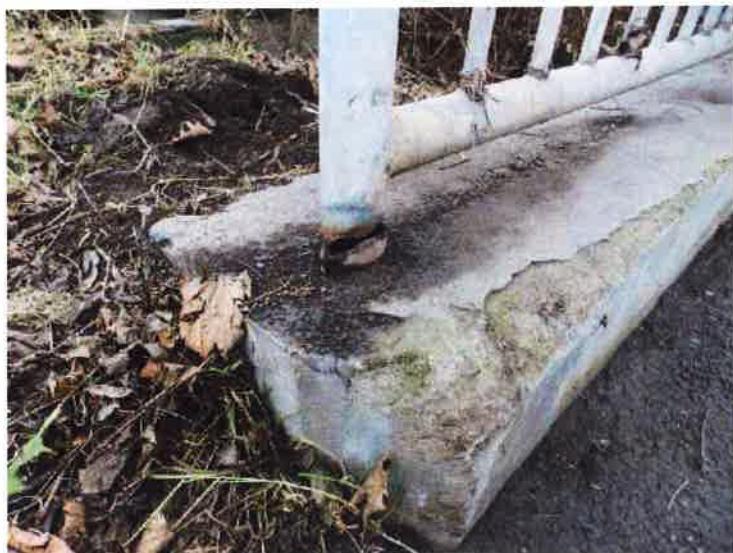
Proražený sloupek zábradlí.
