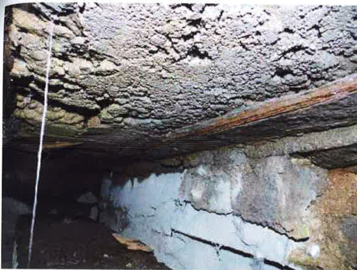
Silná degradace betonu, zatékání okolo pravé římsy a chodníkem. Koroze ocelových nosníků.
