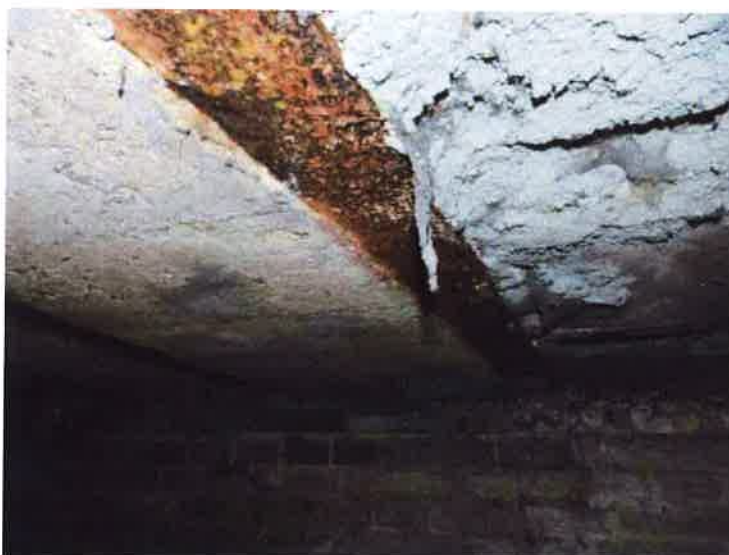
Koroze ocelových nosníků na NK mostu, degradace betonu.
