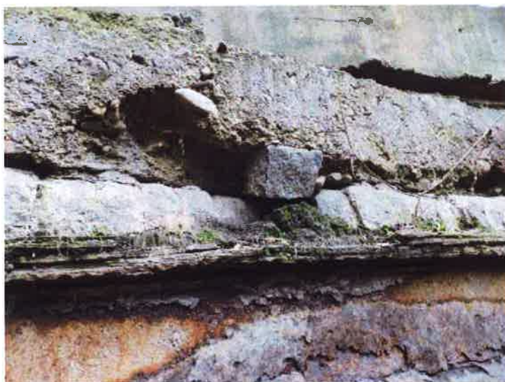
Degradace betonu římsy na levé straně mostu.
