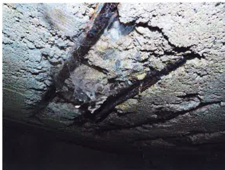
Degradace betonu NK chodníku, koroze odhalené výztuže.
